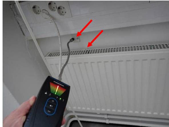
2. Kiinnikeruuveista havaittiin monin paikoin merkittävää ilmavuotoa normaaleissa käyttöolosuhteissa ja alipaineistettuna.
