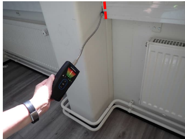
5. Pilarin ja sähkökourun liittymästä todettiin merkittävää ilmavuotoa normaaleissa käyttöolosuhteissa ja alipaineistettuna.
