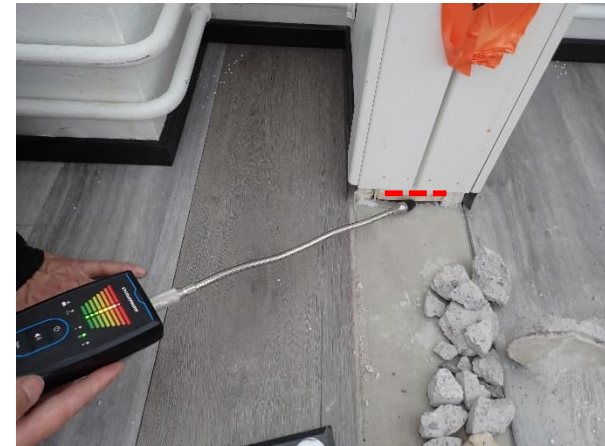
6. Vanhan väliseinän kohdalta havaittiin merkittävää rakomaista ilmavuotoa normaaleissa käyttöolosuhteissa ja alipaineistettuna.
