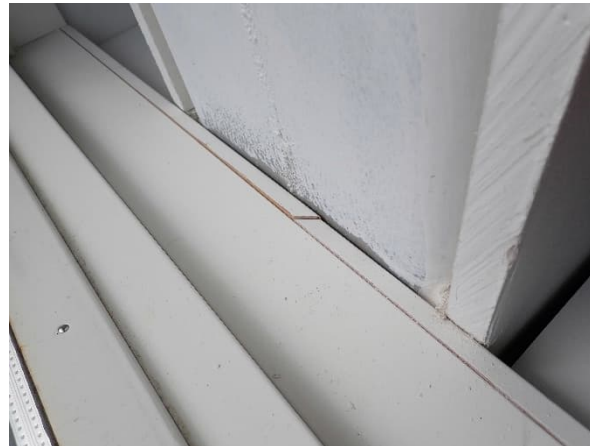
5. Koteloitu pilari on ulkoseinälinjan puolella paikoin tiivistetty. Alapohjan ja betonipilarin välistä tiivistystä ei pystytty tarkastamaan.
