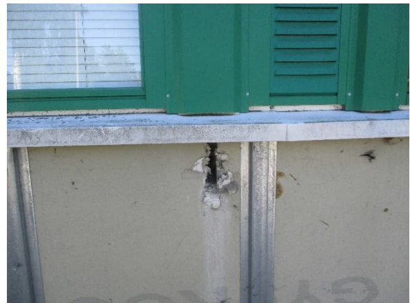
Rakenneavauksen vierustalla on tuulensuojalevy rikki.
