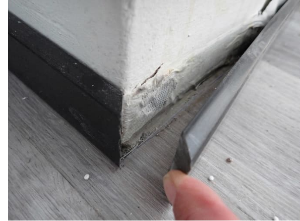
3. Tiivistysnauhan tiiveydessä koteloidun pilarin ja alapohjan välillä on aistinvaraisesti tarkasteltuna mahdollisesti puutteita.
