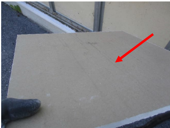
Tuulensuojalevyn sisäpinnalla on veden valumajälki.
