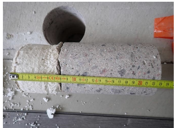
Alapohjarakenteessa teräsbetonin paksuus poikkeaa alkuperäisistä rakennesuunnitelmista.
