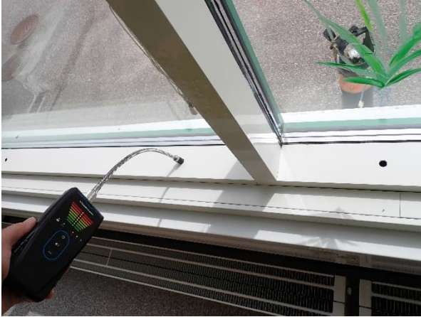
1. Metallikarmien rei'istä todettiin merkittävää ilmavuotoa kaasunsyöttökohtien ympärillä normaaleissa käyttöolosuhteissa ja alipaineistettuna.
