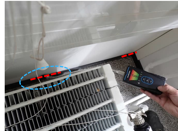
6. Ulkoseinän ja alapohjan liittymästä todettiin merkittävä rakomainen ilmavuotokohta kaasunsyöttökohdassa, kun tila oli alipaineistettu.
