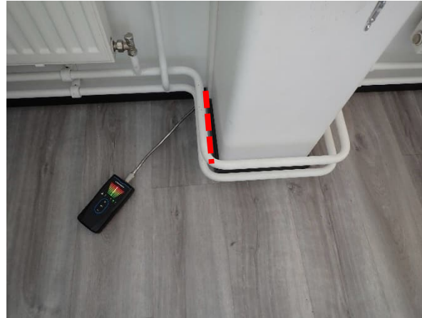
2. Koteloimattoman betonipilarin ja alapohjan liittymästä todettiin merkittävää ilmavuotoa yhdellä pilarin sivustalla.
