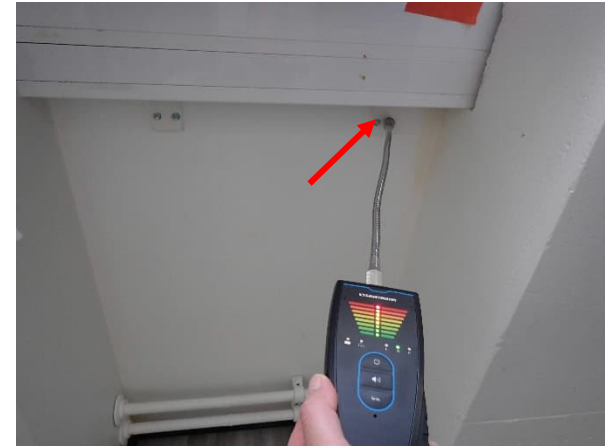
3. Kiinnikeruuveista havaittiin monin paikoin merkittävää ilmavuotoa normaaleissa käyttöolosuhteissa ja alipaineistettuna.
