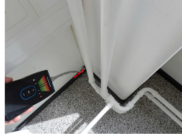
3. Pilarin juuresta todettiin merkittävää ilmavuotoa normaaleissa käyttöolosuhteissa ja alipaineistettuna.
