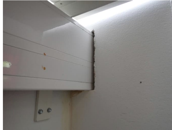
2. Pilarin koteloinnin ja sähkökourun välinen liitos on tiivistämätön.
