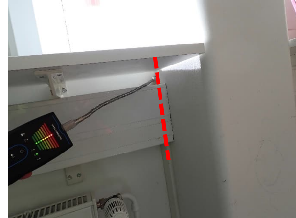
3. Pilarin ja ulkoseinän/sähkökourun liittymästä todettiin merkittävää ilmavuotoa normaaleissa käyttöolosuhteissa ja alipaineistettuna.
