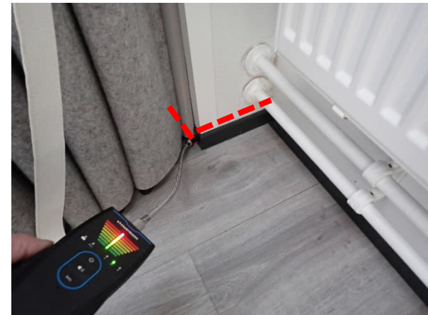
6. Vanhan väliseinän ja alapohjan liittymästä todettiin merkittävää ilmavuotoa normaaleissa käyttöolosuhteissa ja alipaineistettuna.
