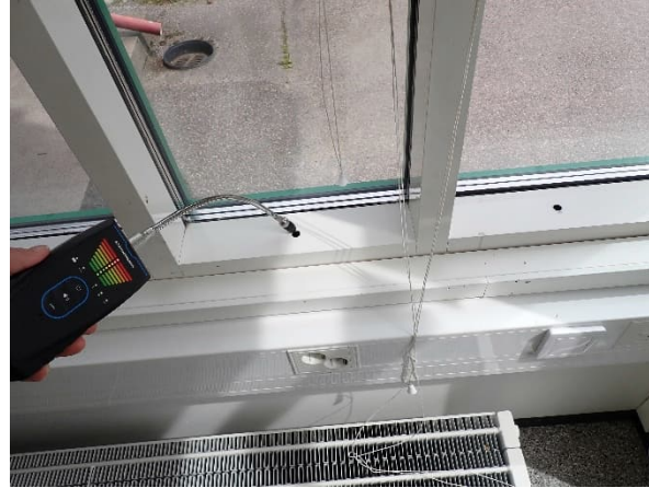
2. Metallikarmien rei'istä todettiin merkittävää ilmavuotoa kaasunsyöttökohtien ympärillä normaaleissa käyttöolosuhteissa ja alipaineistettuna.
