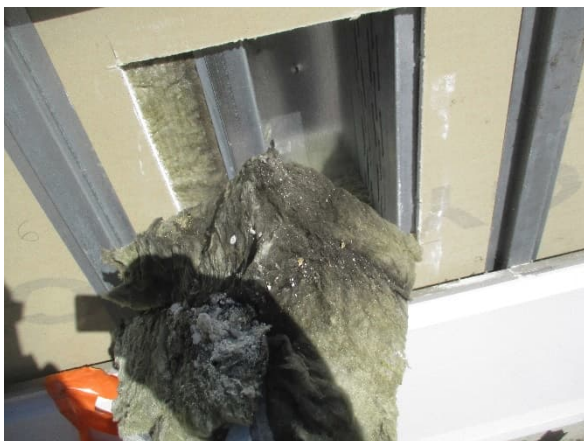
Lämmöneristeen liittymien kohdalla tummentumaa.
