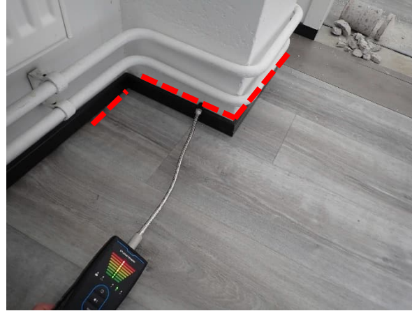
2. Alapohjan ja pilarin liittymästä todettiin merkittävää laaja-alaista ilmavuotoa normaaleissa käyttöolosuhteissa ja alipaineistettuna.
