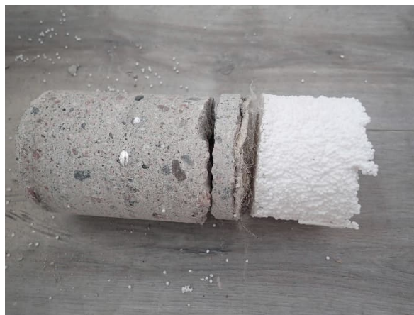
Alapohjarakenteessa teräsbetonin paksuus poikkeaa alkuperäisistä rakennesuunnitelmista.
