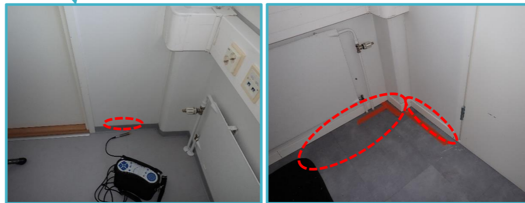
Vuodot tilan 158 puolella
