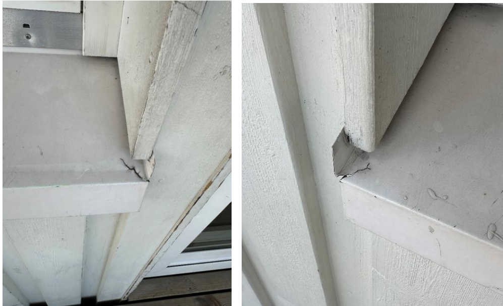
Kuva 7. Ikkunan vesipeltien ja niiden liittymien tiiveys on hyvä, mutta yksittäisten peltien kulmissa on paikoin halkeamia, jotka eivät kuitenkaan juuri vaikuta vedenohjaukseen.
