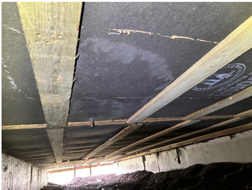
Kuva 11. Vesipostin kohdalla olevan vesivuotokohdan alueella tuulensuojalevyssä on kosteusjälkeä.
