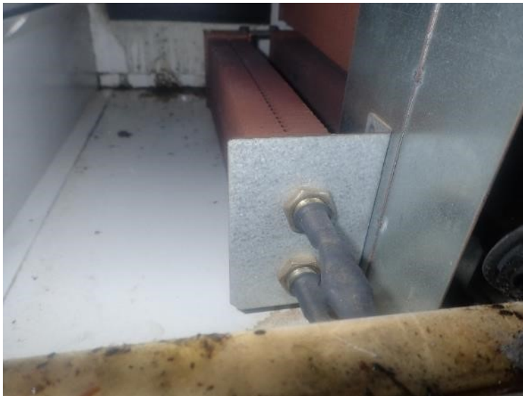
Kuva IV7. Tuloilmakoneen lämmityspattereissa havaittiin korroosiota.
