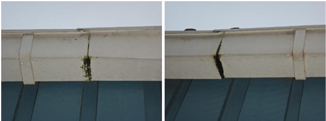
Kuva 71. Vuotavia sadevesikourun liitoksia.
