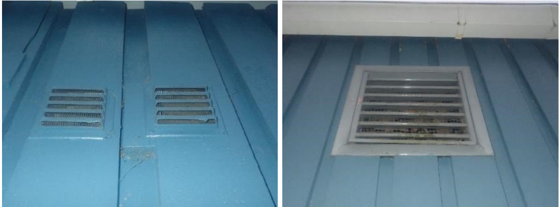
Kuva 26. Raitisilma-aukkoja ulkoseinässä. Hyönteisverkko säleikön takana on lähes ummessa pölystä.
