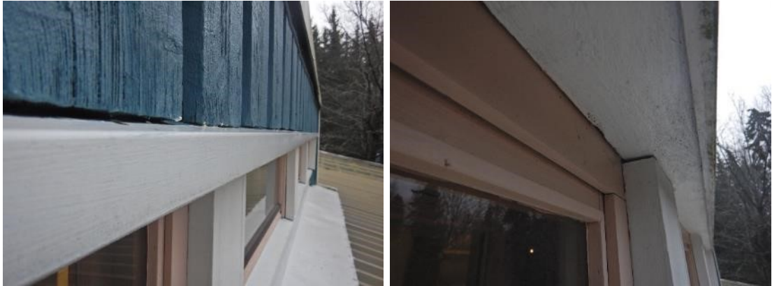
Kuva 32. Yläikkunoiden päällä on vastaava pellitys kuin muissa ikkunoissa.
