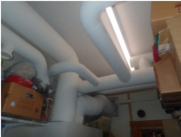
Kuva IV13. Ilmanvaihtokanavistosta puuttuu kannakkeet ilmanvaihtokoneen läheisyydestä.
