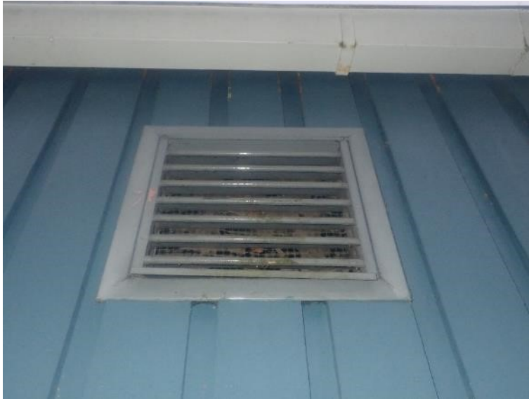
Kuva IV2. Ilmanvaihtokoneen raitisilmasäleikössä havaittiin roskaa ja se on osin tukkeutunut.
