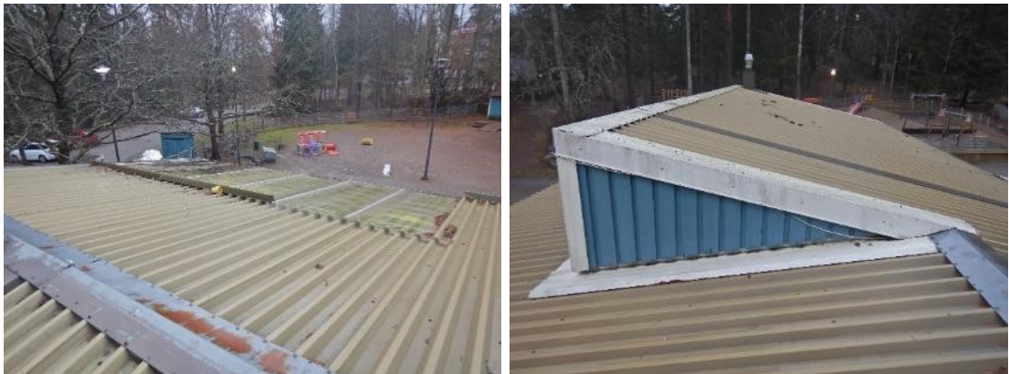
Kuva 64. Etelän puoleinen kattolape. Harjapellin maali hilseilee ja pelti on ruosteessa. Valokate on voimakkaasti leväkasvustoinen.
