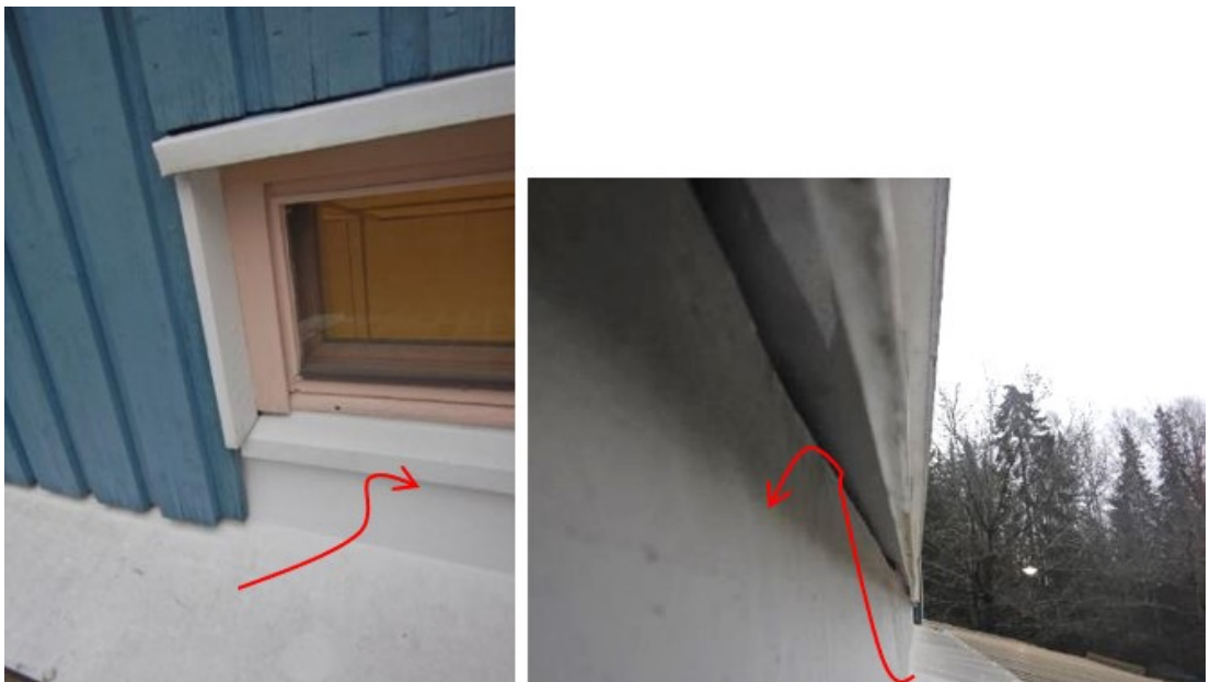
Kuva 33. Yläikkunoiden alareuna on lähellä alemman kattolapteen pintaa. Liittymässä on pelti, jonka ylösnoston korkeus on vain n. 150 mm ja reunasta puuttuu myrskytaite. Sadevesi pääsee liittymästä kovalla tuulella rakenteeseen (nuoli).
