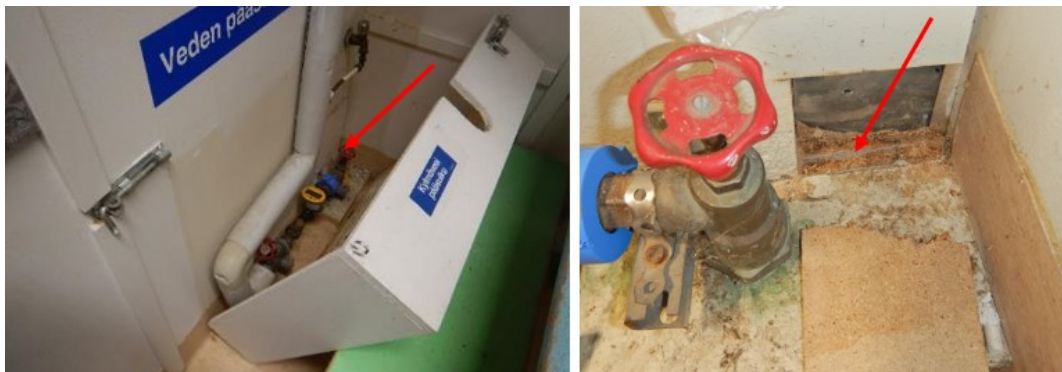
Kuva 42. Ulkoseinän rakenneavaus RA17 vesimittarin/pääsulun kotelon sisällä. Rakenteen sisäosassa vesiputken vuodon aiheuttama mikrobivaurio lastulevyssä. Höyrynsulun takana rakenne oli kunnossa.
