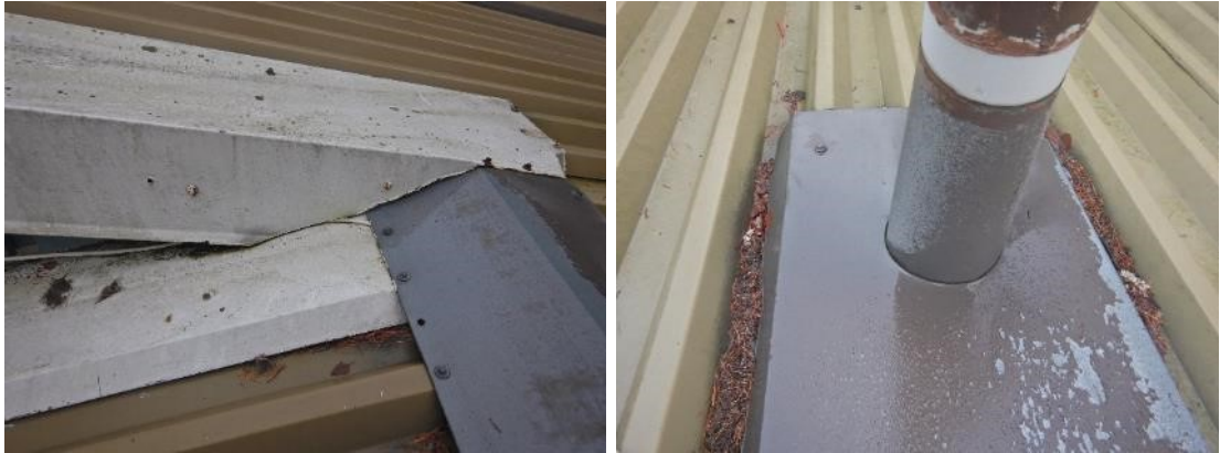
Kuva 68. Etelän puoleinen kattolape. Lappeiden liitoksessa pellityksessä on vesitiiveyspuutteita. Oikealla viemärintuuletusputki. Suojapellin ja katepellin välissä on vaahtomuovitiivistä, vrt. edelliset kuvat.
