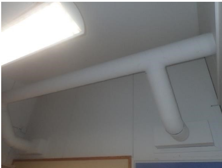
Kuva IV14. Huonetiloissa sijaitsevasta tuloilmakanavistosta puuttuu kannakkeet.
