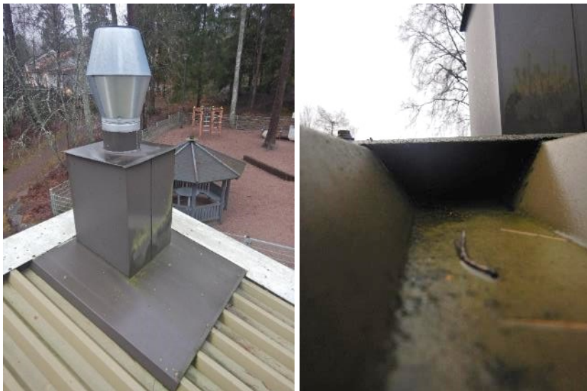
Kuva 69. IV-koneen poistoilmahuppu rakennuksen harjalla. Suojapellin ja katepellin välissä olevasta vaahtomuovi- tai muusta tiivistyksestä ei saatu varmuutta.
