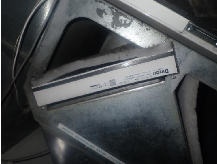
Kuva IV4. Tuloilmakoneen kasettsuodattimen ja ilmanvaihtokoneen rakenneosien välinen tiiveys on puutteellista, josta aiheutuu ohivirtausta.
