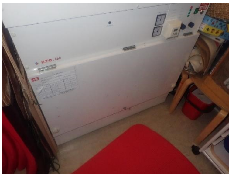
Kuva IV1. Yleiskuva ilmanvaihtokoneesta TPK1.
