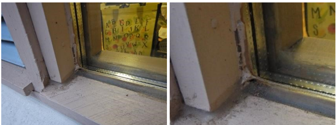
Kuva 28. Lämpölasien kittauksissa puiseen ikkunaelementtiin oli paikoin puutteita. Sadevesi pääsee rakenteeseen.
