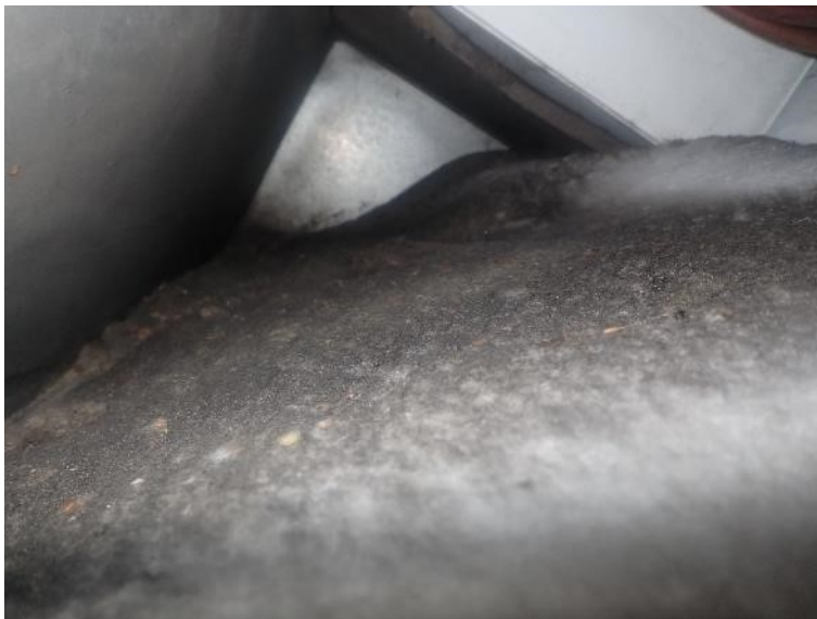
Kuva IV3. Tuloilmakoneen karkeasuodattimessa havaittiin runsaasti pölykerrostumaa ja ulkoilman epäpuhtauksia.
