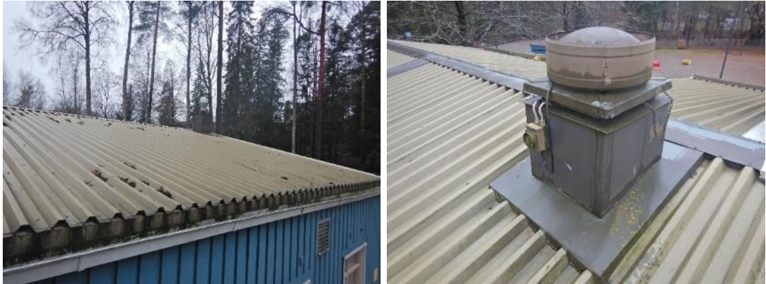
Kuva 63. Pohjoisen puoleinen kattolape. Käytöstä poistettu huippuimuri. Huippuimurin alapuolinen läpivienti on vuotanut aiemmin.
