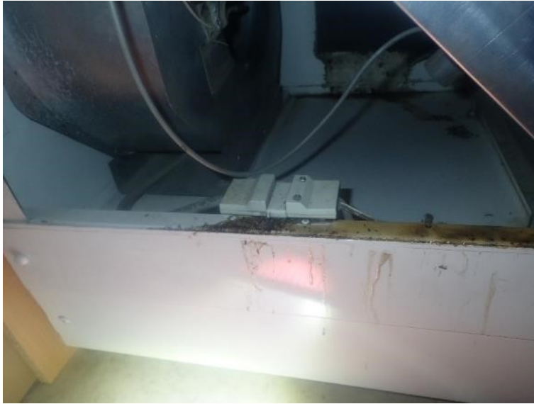
Kuva IV6. Poistoilmakoneen LTO-kuution ja puhaltimen välisessä kammiossa havaittiin tuntemattomaksi jäänyttä tahmeaa likaa ja jyrsiäjäperäisiä jätöksiä sekä kuolleita hyönteisiä.
