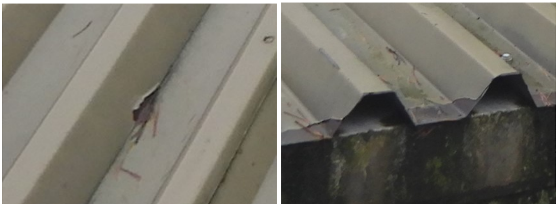
Kuva 65. Katon pinnoitteen hilseilyä.
