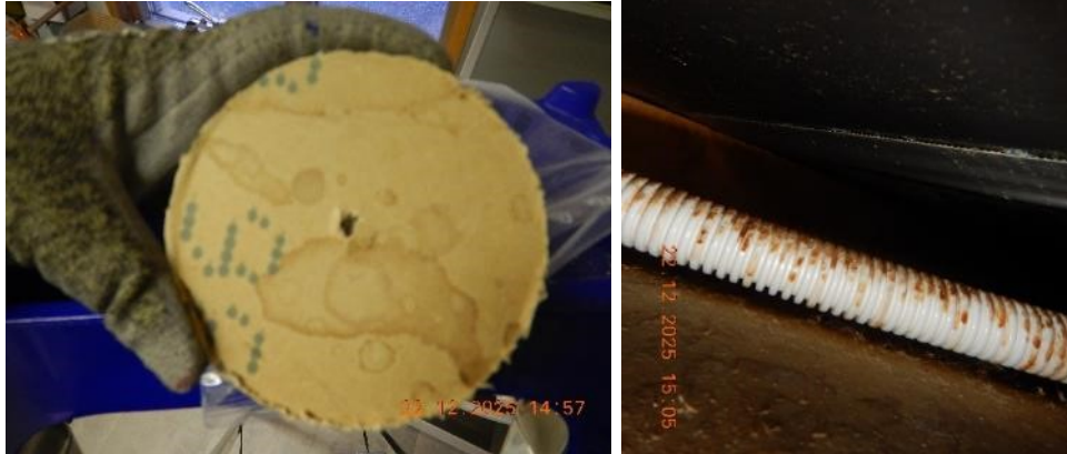
Kuva 80. Rakenneavaukset RA12 ja RA13 keittiön 101 kattoon. Molemmassa avauskohdissa todettiin kosteusjälkiä rakenteessa.
