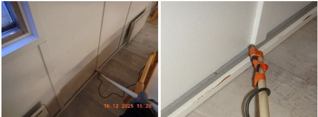
Kuva 54. Tilan 104 ilmavuotokohtia: ulkoseinä-lattialiitos paikallisesti.
