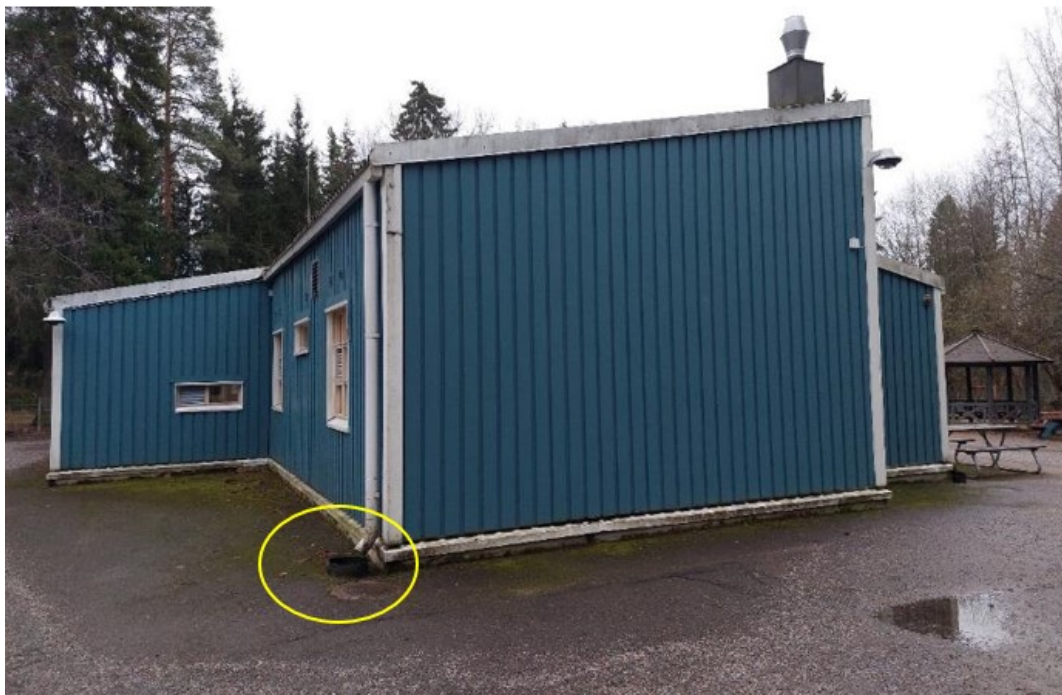
Kuva 13. Rakennuksen luoteispääty. Maanpinta kallistaa hyvin loivasti pois päin rakennuksesta, mutta matala sokkeli ja asfaltti ovat rakennuksen ympärillä voimakkaasti sammaloituneet. Sokkelin juuressa on peltikaista. Pohjoisnurkalla on rännikaivo ja alkuperäisten suunnitelmien mukainen salaojakaivo.
