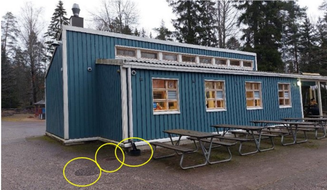
Kuva 14. Rakennuksen lounaisjulkisivu. Terrassin alue on kivetty. Kiveys on hieman sammaloitunut. Maanpinta kallistaa loivasti pois päin rakennuksesta. Tällä alueella sokkeli on jonkin verran muita julkisivuja korkeampi. Nurkalla on rännikaivo, salaojakaivo ja suunnitelmien mukainen perusvesikaivo. Syöksytorvea on jatkettu ulottumaan kaivolle saakka.
