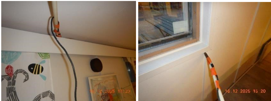
Kuva 56. Tilan 104 ilmavuotokohtia: ulkoseinä-kattoliitos, ikkunaelementin liitos paikallisesti.
