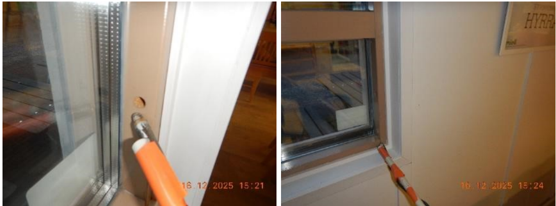
Kuva 55. Tilan 104 ilmavuotokohtia: ikkunaelementin karmin reikä, ikkunaelementin liitos paikallisesti.
