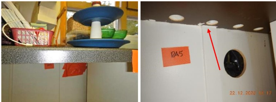
Kuva 36. Keittiön 101 kalustelevypöytä on kiinni ulkoseinässä. Levyä ei ole irrotettu takana olevan levysauman tiivistämiseksi, mutta levyn reunat on kitattu seinään.
