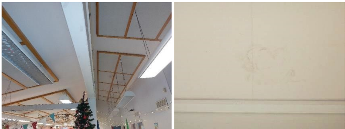
Kuva 72. Lappeen suuntaista kattoa salissa 104. Alemman lappeen reunassa havaittiin kosteusjälki joka tutkittiin rakenneavauksella (RA14).
