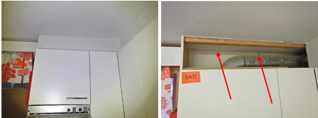
Kuva 37. Esimerkki kohdasta, jossa ulkoseinän tiivistys on jätetty tekemättä. Keittiön 101 liesituulettimen kanavan koteloinnin sisällä levysaumaa ja seinä-kattoliitosta ei ole tiivistetty.
