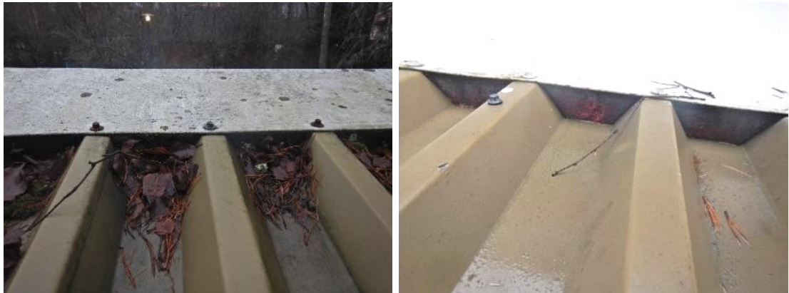
Kuva 67. Lehtiroskaa yläräystäällä räystäspellin ja katepellin välissä. Oikeanpuoleisessa kuvassa näkyy harjapellin ja katepellin välissä vaahtomuovitiiviste (alkuperäisissä suunnitelmissa mainittu "neopreenitiiviste"). Vaahtomuovi ei tiivistä kunnolla peltien väliä (todennäköisesti muovi on kutistunut ajan myötä). Vastaava tiivistys on räystäällä ja läpiviennissä.
