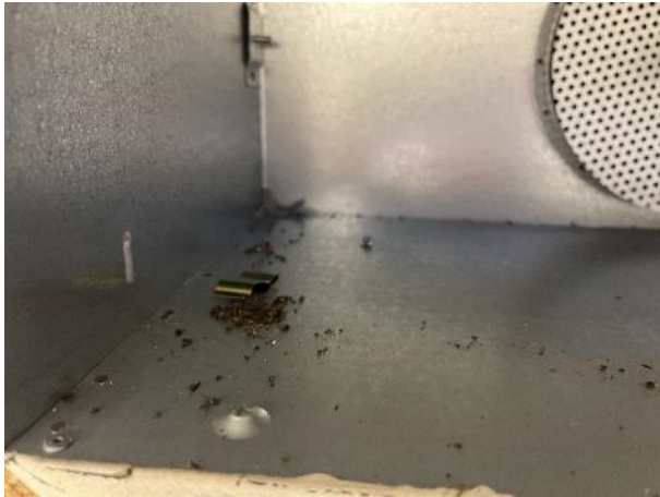
Kuva IV17. Kuolleita hyönteisiä ja raskaampaa likaa tuloilmapäätelaitteen sisällä.
