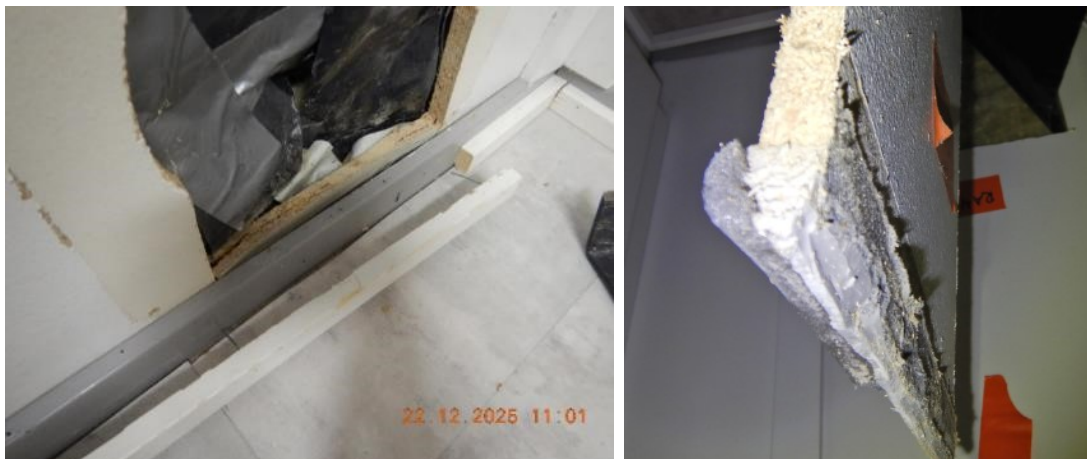
Kuva 38. Lastulevyseinän tiivistys lattiaan. Levyn ja alapohjalaatan yläpinnan välissä on n. 10 mm rako, joka on täytetty paisuvalla saumanauhalla ja elastisella massalla. Sisäpinnassa on itseliimautuva tiivistysnauha. Tiivistys on tehty vinyylilankkulattian alle, vanhan muovimaton päälle.
