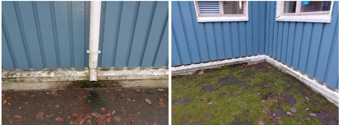
Kuva 12. Lähikuvia koillisjulkisivulta. Sokkeli on runsaasti sammaloitunut ja sokkelin suojaepellin pinta kasvaa levää. Syökytorven roiskevedet rasittavat sokkeliä (ei rännikaivoa).
