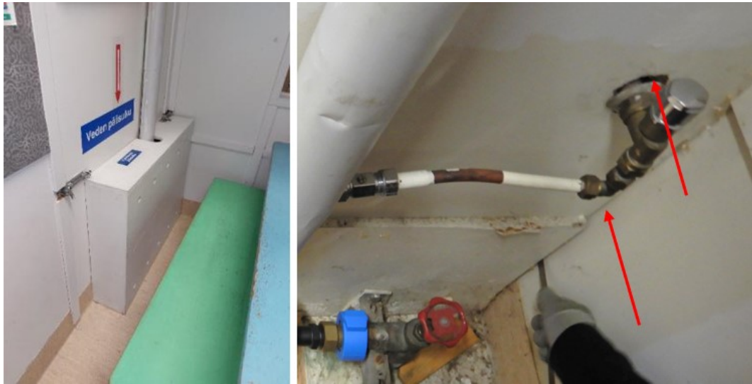
Kuva 35. Esimerkki kohdasta, jossa ulkoseinän tiivistys on jätetty tekemättä. Liittymät ja läpiviennit vesimittarikotelon sisällä tilassa 107 ovat tiivistämättä. Tiivistys loppuu kotelon yläreunaan.
