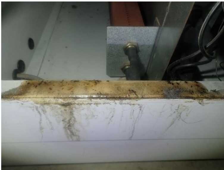
Kuva IV5. Tuloilmakoneen LTO-kuution ja lämmityspatterin välisessä kammiossa havaittiin tuntemattomaksi jäänyttä tahmeaa likaa ja jyräjäperäisiä jätöksiä.
