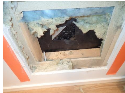
Kuva 17. Tilan 07 ulkoseinän tervapaperia vasten olevassa mineraalivillaeristeessä ei todettu mikrobikasvustoa.
