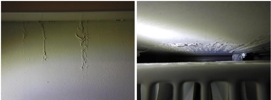
Kuva 29. Tilan 179 maalipinta hilseilee pääasiassa seinän alaosassa, erityisesti patterin takana. Hilseily oli epätavallisen näköistä; maali ja tasoite eivät olleet pehmenneitä, vaan maalipinta oli tiivis ja kiinni alustassa, vaikkakin kuprulla.
