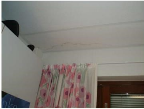
Kuva 7. Terveystenhoituhuoneen alakatossa on yläkerran tilojen lattian pesuvesien vuotojälkiä. Vuotoalueet korjataan.
