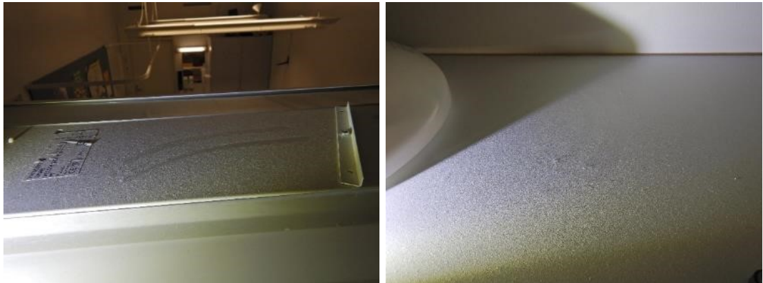
Kuva 46. Tilojen valaisimien ja korkeiden kalusteiden päällä havaittiin runsaita yläpölyjä. Muuten tilat olivat pääasiassa siistejä.
