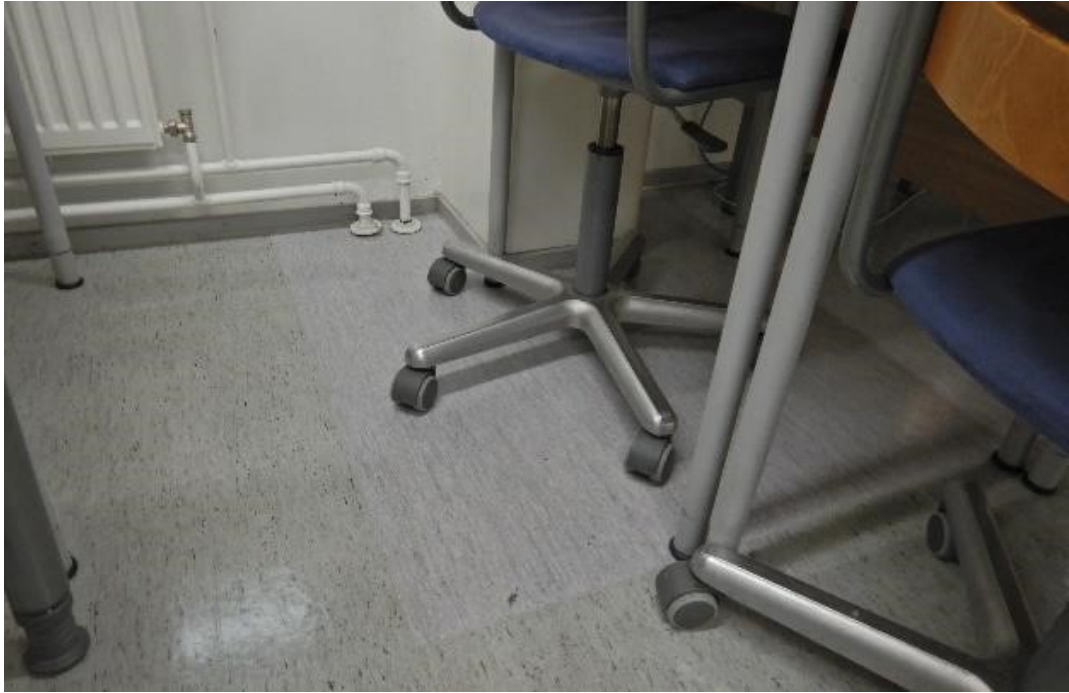
Kuva 36. Luokan 272 pilarin alueelta on vaihdettu muovimatto siivousvesien alempiin tiloihin vuotamisen jälkeen. Vuoto oli tapahtunut pilarin viereisten patteriputkien läpiviennin kautta ja se oli kastellut rajalliselta alueelta muovimaton alustaa.
