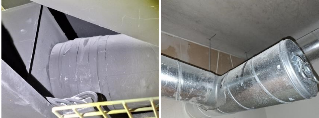
Kuva 44. Alakattojen sisällä taloteknisten asennusten päällä oli pölyä. Vasemmanpuolisessa kuvassa pölykertymää 2. kerroksen käytävän alakatosta ja oikeanpuolisessa kuvassa tilan 172 alakatosta.
