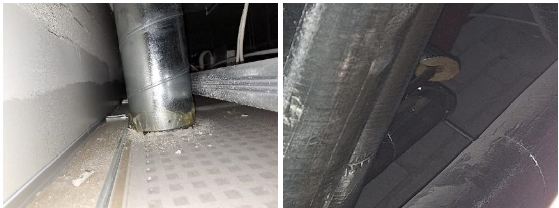
Kuva 45. Vasen kuva: 1. kerroksen käytävällä alakattolevytyys oli kipsilevyä muista tiloista poiketen. Käytävän alakatossa oli rakennusmoskaa/pölyä taloteknisten järjestelmien asennuksesta. Oikea kuva: 1. kerroksen käytävän kohta, jossa havaittiin putkieristeen paikallinen irtoaminen.
