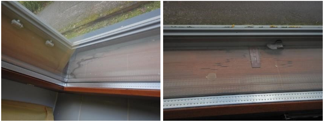
Kuva 19. 1. kerroksen tilojen ikkunoiden väleissä oli kosteusjälkiä yleisesti mutta pienialaisesti.
