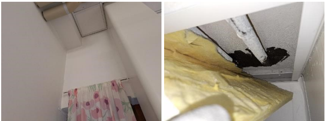
Kuva 26. Nurkkakohta tilassa 180, jossa siivousvedet ovat vuotaneet ylemmästä kerroksesta patteriputkien läpiviennin kautta aiemmin. Kohdassa alakattolevy on uusittu pinnoittamattomalla mineraalivillalevyllä ja patteriputken läpivienti on tiivistetty.
