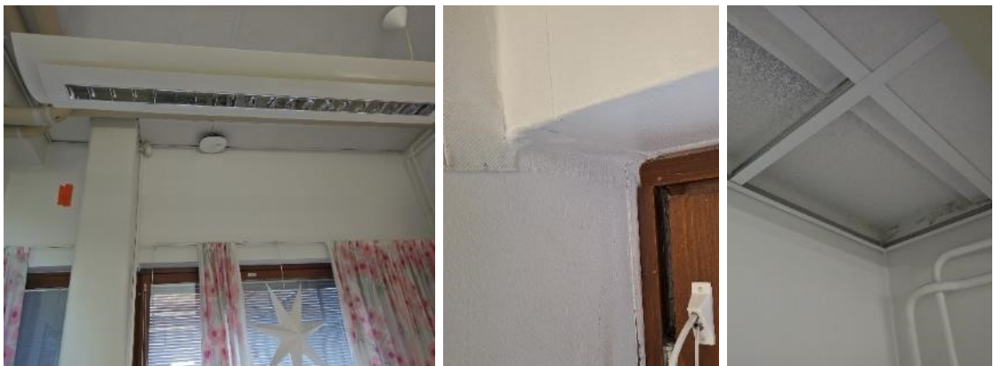
Kuva 27. Tilassa 180 ikkunaliittymät on tiivistetty, mutta välipohjan liittymät ovat tiivistämättä, toisin kuin tilassa 179 (ks. seuraava kuva).
