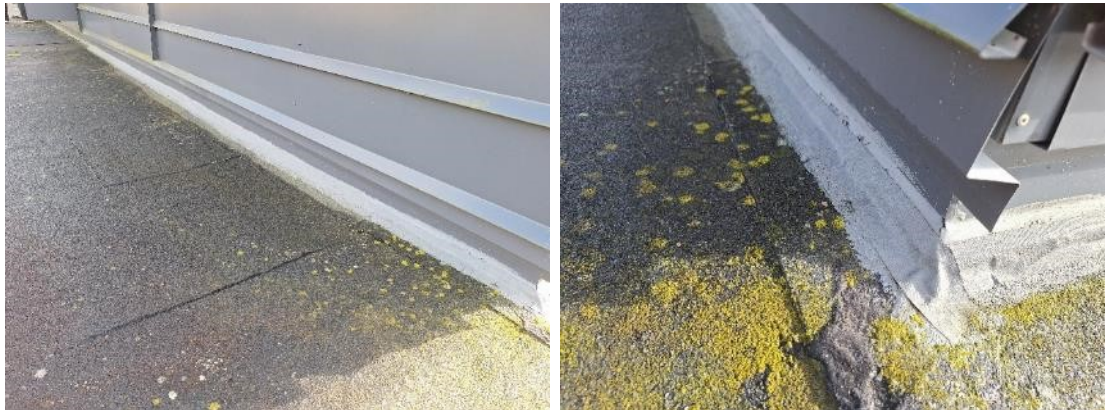
Kuva 49. IV-konehuoneen juuren liittymää on tiivistetty ulkopuolelta. Tiivistys on paikoittain poimuilla ja tiivistysmateriaali vaikuttaa epäsopivalta käyttötarkoitukseen.
