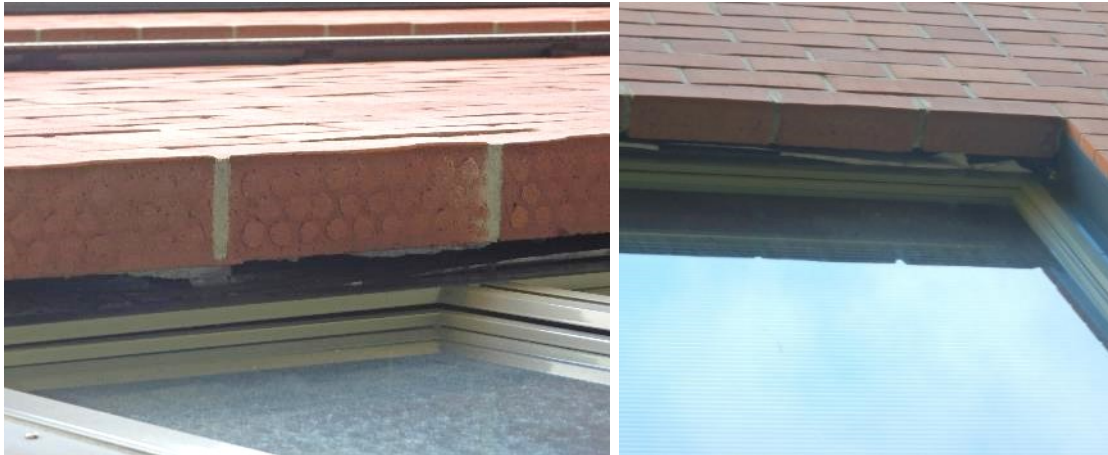
Kuva 13. Ikkunaliittymän yläosa on avoinna ulkoseinän tuuletusrakoon. Tuulensuojapaperi roikkuu / on irronnut alaosaan monin paikoin.
