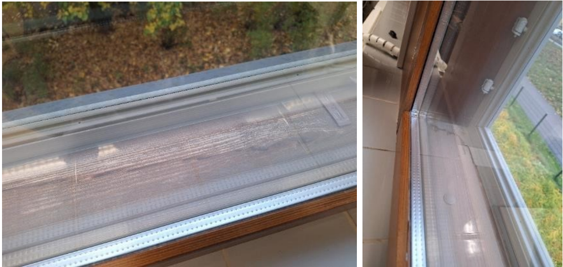
Kuva 33. Tilojen ikkunoiden välissä oli kosteusjälkiä pääosassa tarkastetuista tiloista.
