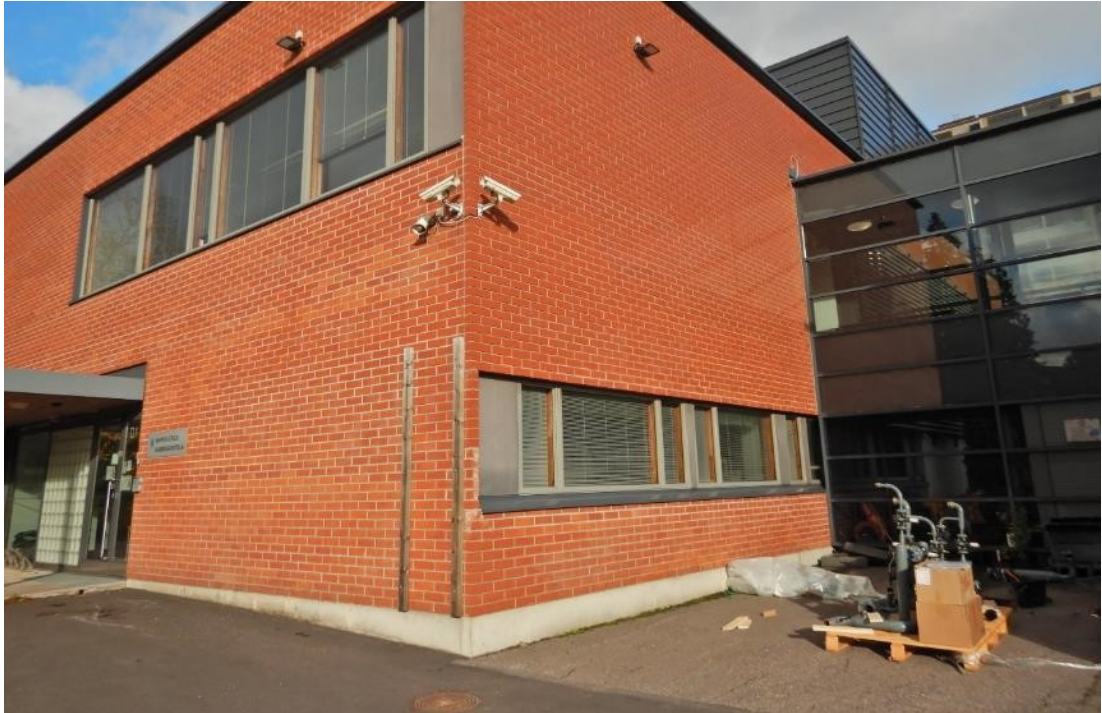
Kuva 10. Laajennusosan asfaltoitujen/laatoitettujen alueiden ja sokkelin välissä on paikoittain sammalkasvua. Laajennusosan lounaisnurkassa oli vähäistä kalkkihärmää julkisivumuurauksen pinnassa, joka liittyy todennäköisesti kohdassa aiemmin olleisiin asennuksiin.
