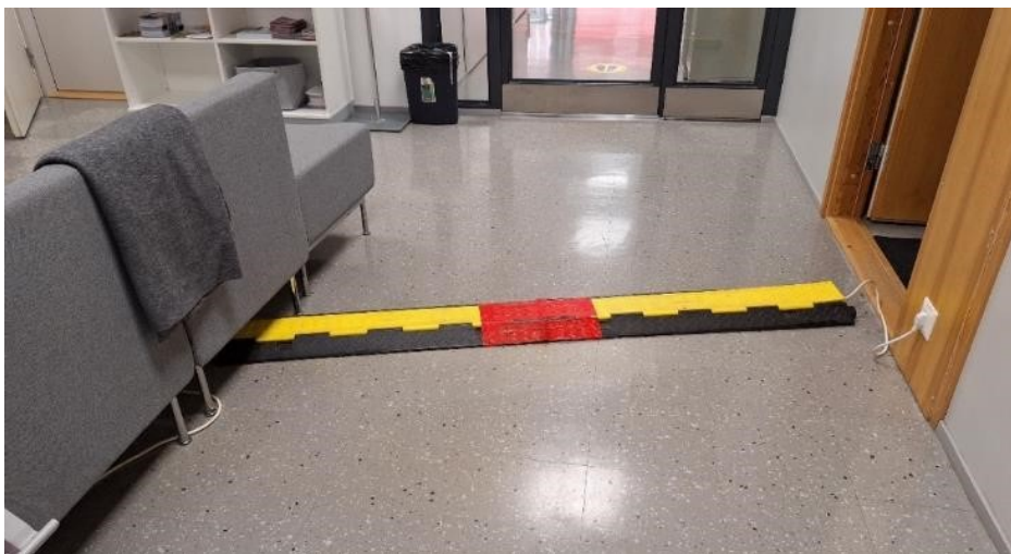
Kuva 20. Tilojen 172/173 ja 179/180 välissä olevassa odotustilassa oleva johtokotelo, josta havaittiin PAH-yhdisteisiin/öljyhilivetyihin viittaavaa hajua.
