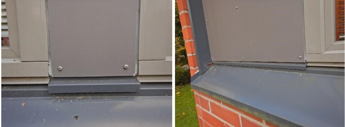
Kuva 12. Ikkunoiden levytettyjen välien saumat on tiivistetty joustavalla saumamassalla, joka alkaa olla ikääntynyttä. Levytetyn osan alareunassa on erillinen peltinen tippalista. Ikkunaliittymät on peitetty reunoilta peltisellä kulmalistalla ja muurauksen ja vesipellin väliin on lisätty saumamassaa.
