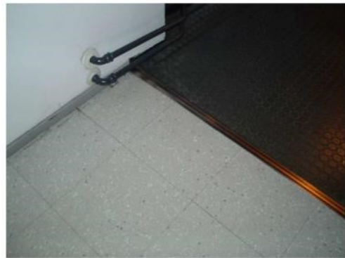
Kuva 1. Yhdyskäytävän ja laajennusosan lattialiittymä.
