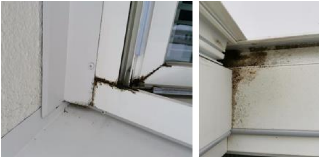
Kuvat 82 a ja b. Ikkunanurkissa oli paikoin tummaa, öljyistä likaa. Ainetta valui ulkopuolteen alanurkista alapuolelle vesiuraan ja paikoin alakarmin päälle. Ilmiön aiheuttaja ei selvinnyt.
