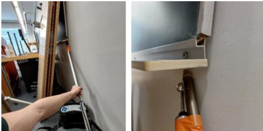
Kuvat 57 a ja b. Merkkiainekoe MA-1, ilmavuotokohtat luokassa 006. Alaosastaan maanvastaisessa seinässä havaittiin heikkoa ilmavuotoa liitutaulun kiinnikkeistä.
