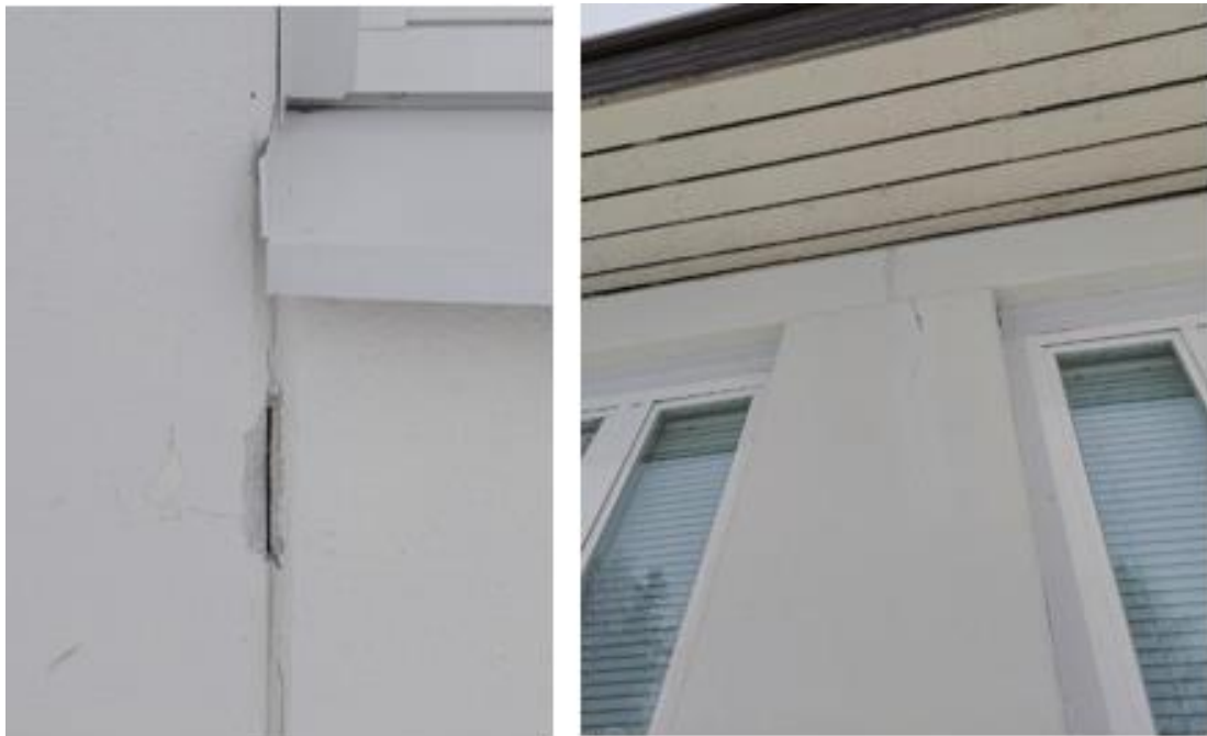
Kuvat 66 a ja b. Halkeamia siporex-elementtien pystysaumoissa ja elementtien keskellä. Vastaavia oli eri julkisivuilla muutamilla kohdilla.
