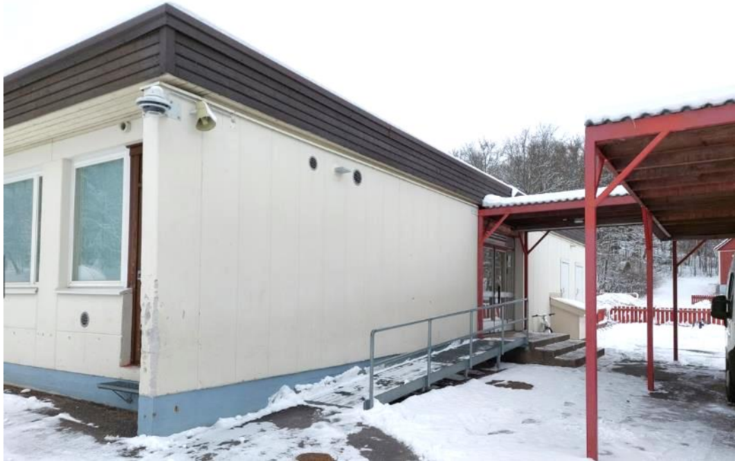
Kuva 67. Rakennuksen itäpääty. Julkisivupinnassa on koloja ja maalipinta on kulunut. Lämmöneristämättömät siporex-ulokkeet ovat pahiten rapautuneet. Lippa suojaa sisäänkäyntiä. Lipan ylösnostopelti ei ole tarpeeksi korkea suojaamaan räystäään otsalaudoitusta lipalle kinostuvalta lumelta.
