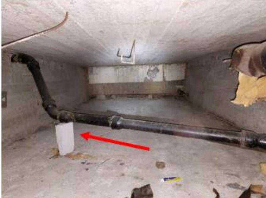
Kuva 33. Kanaalissa oleva viemäriputki on kannakoitu virheellisesti irtonaisen tiilen päälle.
