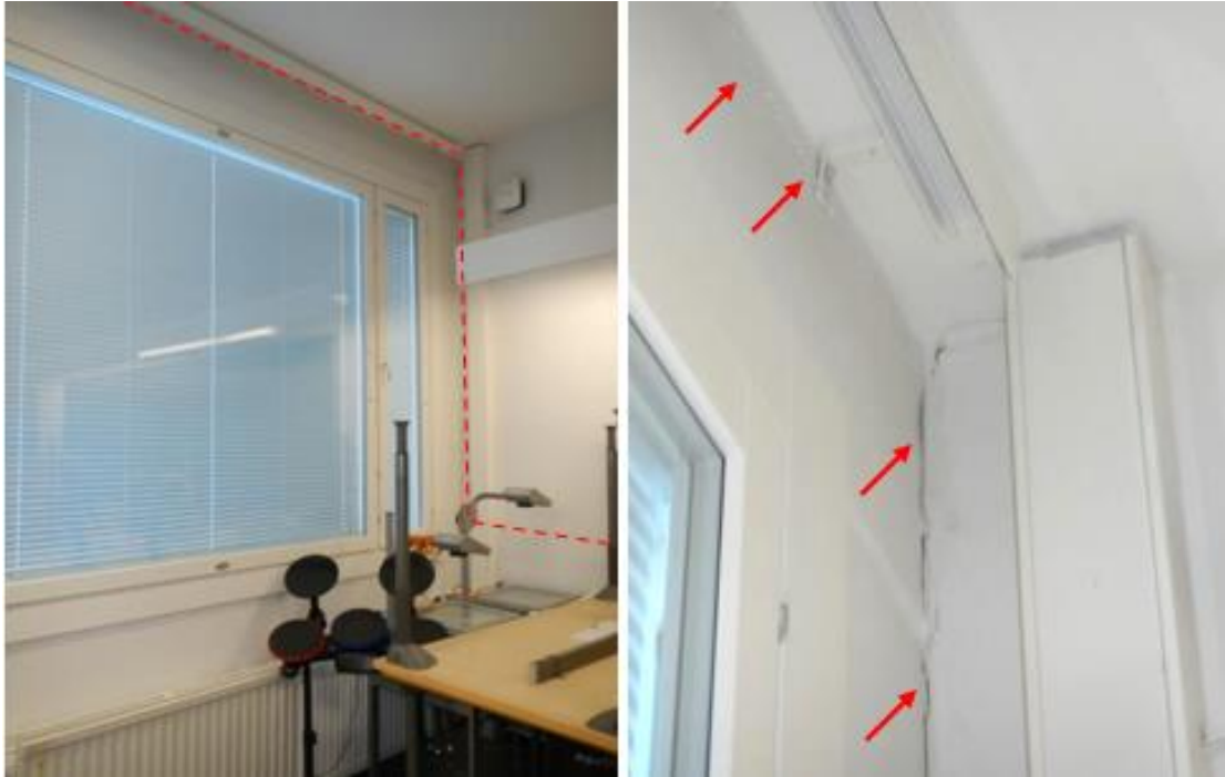
Kuvat 77 a ja b. Halkeamia käsityöluokan 006 rakenteissa rakennuksen tasoeron kohdalla.
