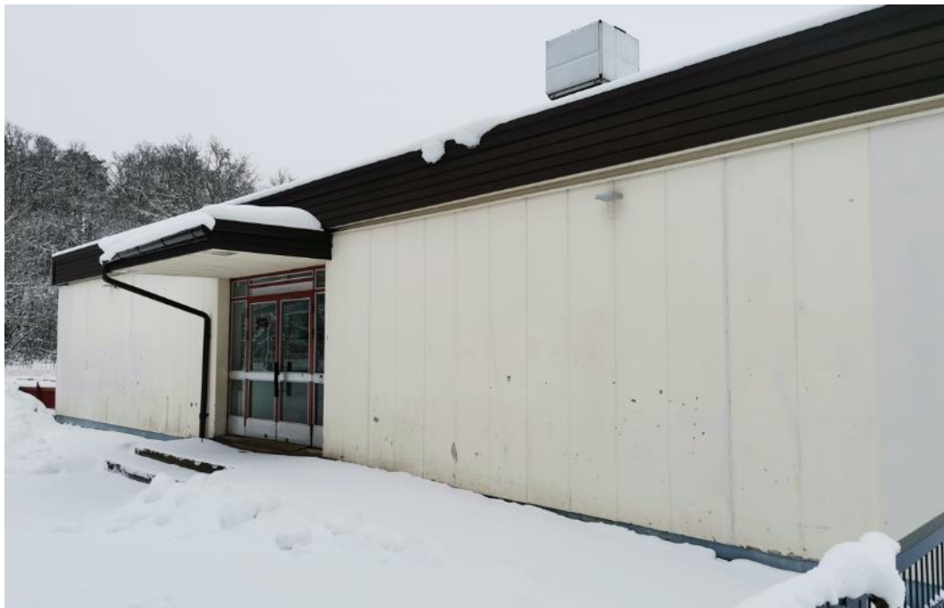
Kuva 74. Rakennuksen länsipääty. Sokkeli on melko matala. Lippa suojaa sisäänkäyntiä, mutta lipan pellityksen ylösnosto on riittämätön. Julkisivu on kulunut ja siinä on paljon pieniä koloja, ja halkeamia elementtisaumoissa. Kulmissa julkisivua on paikattu ja maalattu harmaansävyisellä maalilla.
