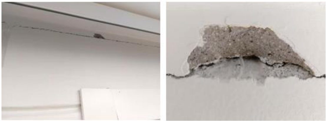
Kuvat 75 a ja b. Painumahalkeamia käsityöluokan 006 seinän yläosassa siporex-elementtien välisessä vaakasaumassa.
