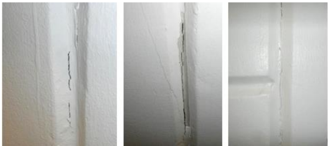
Kuvat 76 a...c. Paikallisia pystyhalkeamia siporex-elementtien välissä. Vastaavia oli koko rakennuksessa melko vähän.
