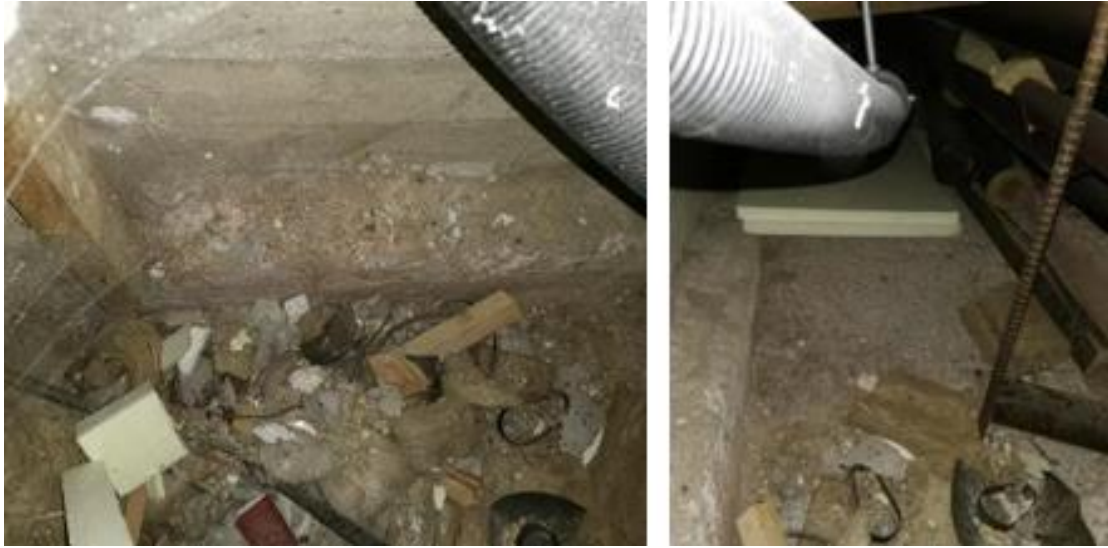
Kuvat 41 a ja b. Pienemmän kanaalin pohjalla on rakennusjätettä. Kanaalia ei ole mahdollista siivoamaan. Kanaalissa oli vastaava maakellarimainen haju kuin isossa kanaalissa.
