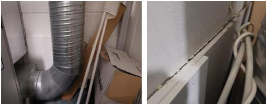
Kuvat 78 a ja b. IVKH:en ulkoseinässä on siporex-rakenteessa aukko raitisilmakanavaa varten. Seinän alaosa on eristetty mineraalivillalla ja verhottu lastulevyllä. Kohdan ulkopuolella on lumisiepparisäleikkö.
