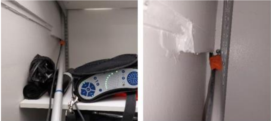
Kuvat 56 a ja b. Merkkiainekoe MA-1, ilmavuotokohtat varastossa 007. Maanvastaisen seinän nurkasta havaittiin voimakasta ilmavuotoa. Seinän maanvastainen alaosa on harkkorakenteinen ja yläosa lastulevyrakenteinen. Ilmavuoto todettiin materiaalien rajakohdasta.
