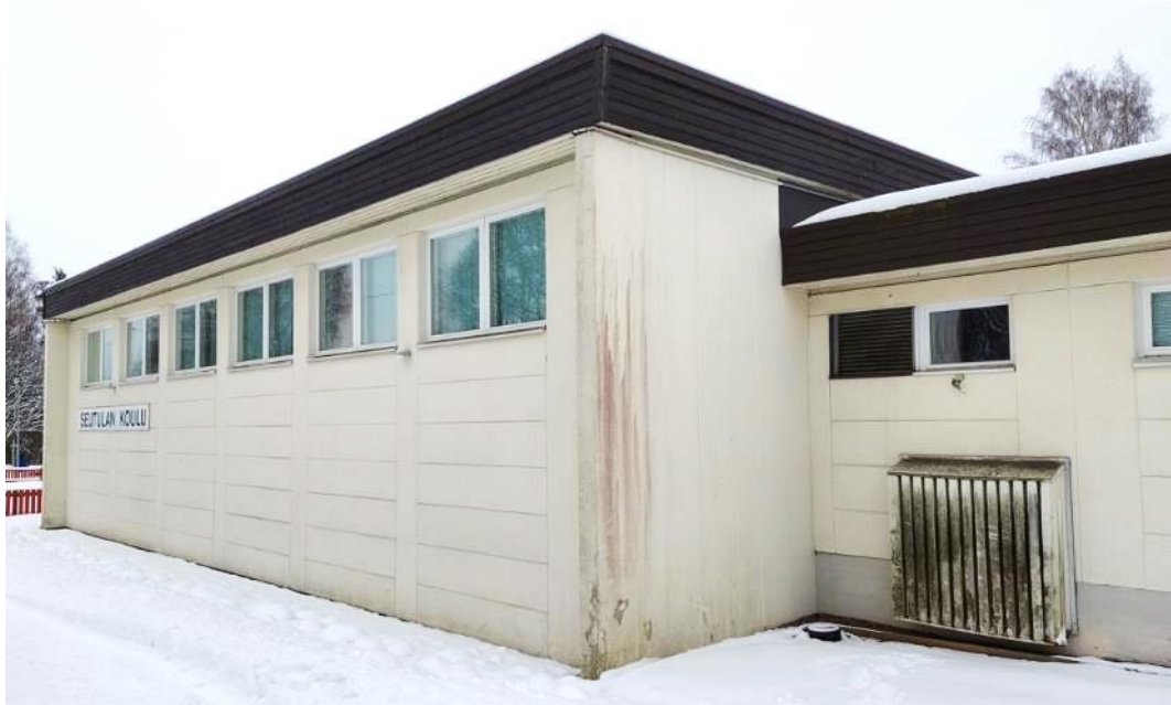
Kuva 69. Pohjoisjulkisivua. Sokkeli on matala erityisesti liikuntasalin kohdalla. IV-konehuoneen kohdalla julkisivulla on tuloilmasäleikön edessä puurakenteinen lumisieppari, jonka rakenne on huonokuntoinen ja leväkasvuston peitossa.
