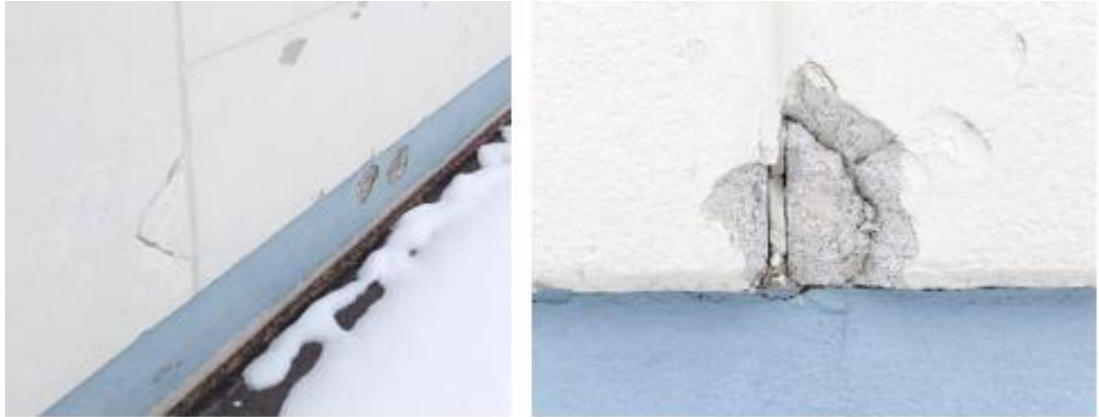
Kuvat 65 a ja b. Mekaanisia ja mahdollisesti osin pakkasrapautumisesta johtuvia vaurioita julkisivujen ja sokkelien pinnassa. Halkeamia on paikkakorjattu, mutta ne ovat uusiutuneet.
