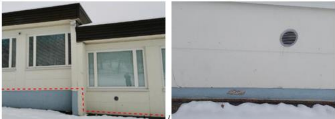
Kuvat 64 a ja b. Rakennuksen tasoerokohta. Lattiapinnan taso on merkitty kuvaan punaisella katkoviivalla. Alempana olevan osan sokkeli on liitoskohdalla hyvin matala. Tällä kohdalla on aiemmin ollut kosteusvaurio maanvastaisen väliseinöosan puurakenteissa. Alkuperäisten puurakenteisten väliseinien alajuoksun alapinta on ollut sokkelin yläpinnan tasossa. Tasoerokohdassa ja siitä kuvassa oikealle todettiin sekä sisä- että ulkopuolella rakenteissa 1-2 mm levyisiä halkeamia.
