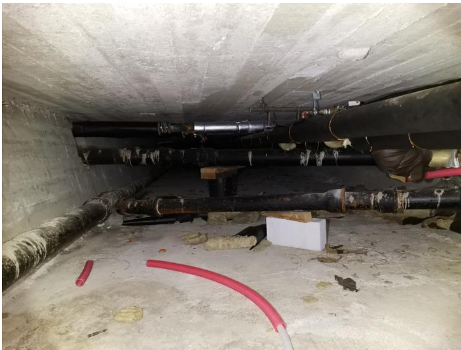
Kuva 38. Viemäriputket estävät osin kulun kanaalissa. Osa viemäriputkien kannakoinneista on tehty asianmukaisesti katosta ripustamalla, osa virheellisesti tiilillä ym. tukemalla.
