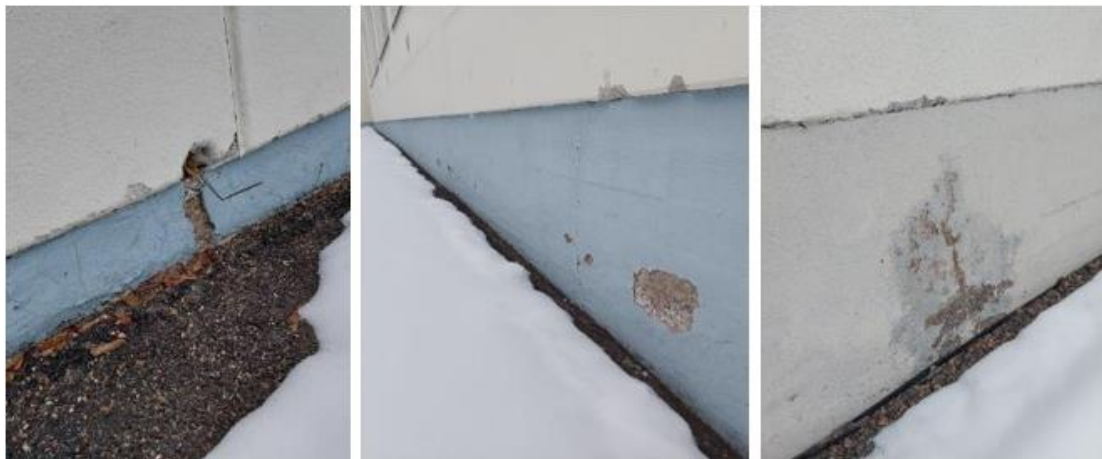
Kuva 11 a...c. Perusmuurissa havaittiin paikallisia maalipinnan hilseilyjä ja betoniteräksiä oli paikoin näkyvissä. Julkisivun havainnot tarkemmin, ks. kohta 5.2.
