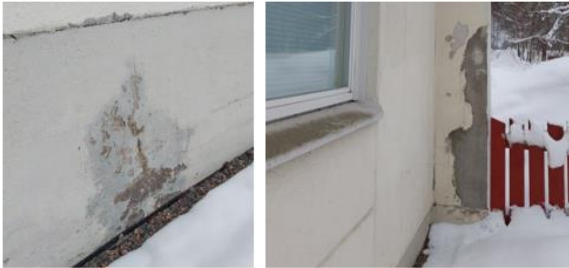
Kuvat 73 a ja b. Vaurioita pohjoisjulkisivun betonisokkelissa ja siporexissa.
