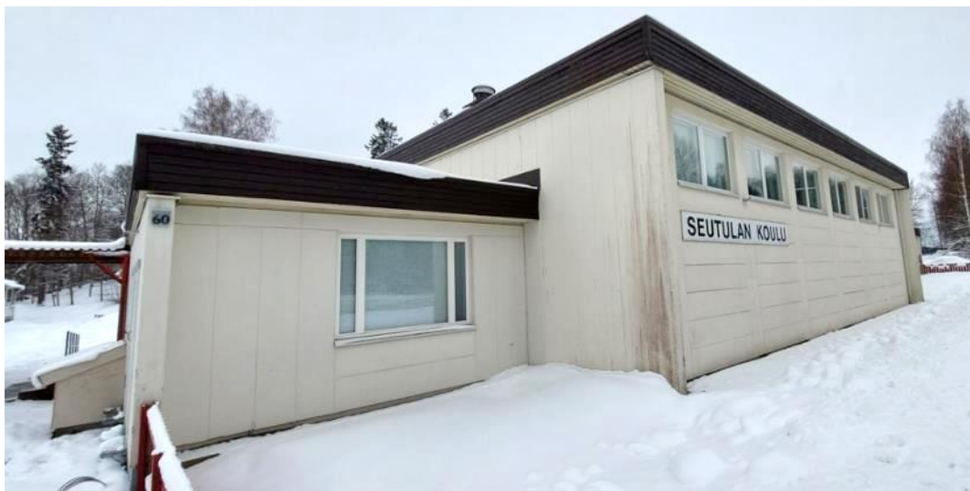
Kuva 68. Pohjoisjulkisivua. Julkisivun pinnassa on leväkasvustoa erityisesti ulokekohdissa, joissa rakenne on viileä, ja pinnan kuivuminen on hitainta.
