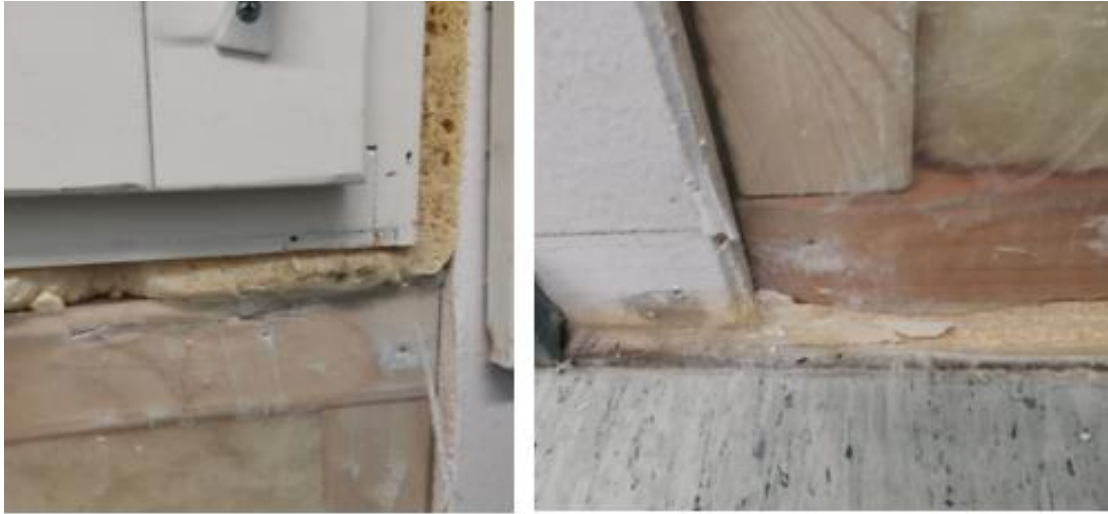
Kuvat 26 a...c. Ulkoseinärakenteet olivat hyväkuntoisia. Vuotojälkiä ei todettu. Ikkunaliittymät on tiivistetty polyuretaanivaahdolla. Höyrynsulkumuovit eivät ole tiiviitä liitoskohdissa.
