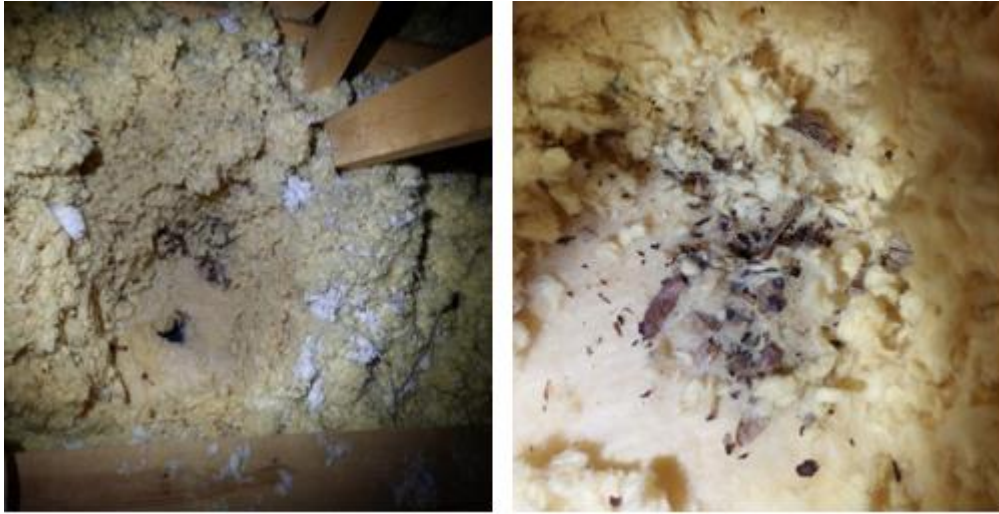
Kuvat 41 a ja b. Yläpohjan eristykseen tehtiin yksi tarkastuskuoppa. Höyrynsulkumuovin päällä on 100 mm levyvilla ja ~250 mm puhallusvillaa. Villan seassa oli jyrssiöihin viittaavaa roskaa.
