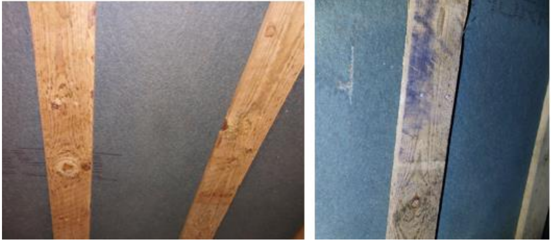
Kuvat 15 a ja b. Alapohjan tuulensuojalevyt olivat hyväkuntoisia. Levyn alapuolisessa laudoituksessa oli paikoin vähäistä sinistymää/pilkkuja.
