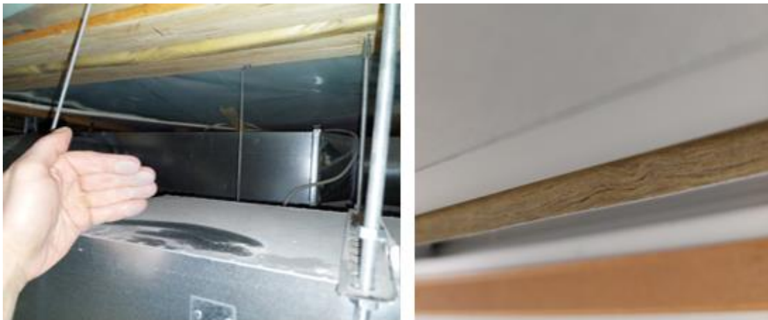
Kuvat 35 a ja b. Alakattojen yläpuolella oli paikoin runsaasti pölyä pinnoilla. Alakattolevytysten leikattuja reunoja ei ollut maalattu/pinnoitettu ja niissä oli avoimia mineraalivillapintoja.
