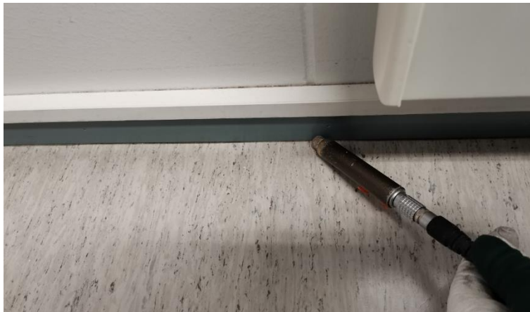
Kuva 20. Lattia-seinäliittymästä havaittiin ilmavuotoa. Ilmavuoto oli kohtalaista mutta vuotokohta vain pistemäinen.
