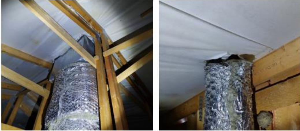
Kuvat 39 a ja b. Aluskatteen läpiviennit eivät olleet tiiviitä, mutta viitteitä vuodoista ei havaittu. Puset kattotuolit olivat siistit.
