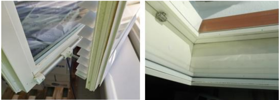
Kuvat 22 a ja b. Ikkunat ja ovet olivat hyväkuntoisia eikä niiden toiminnassa havaittu puutteita. Ikkunoissa ei ollut kosteusjälkiä.
