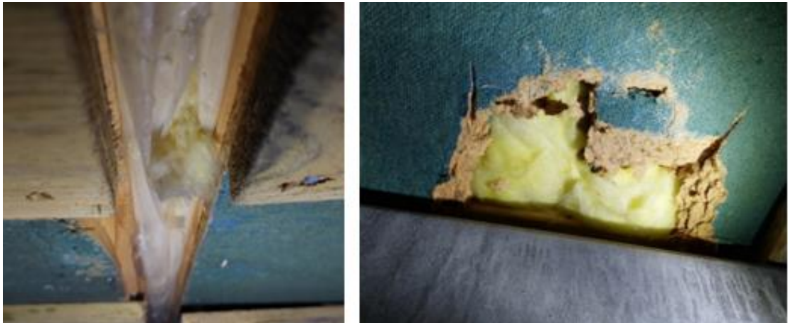
Kuvat 16 a ja b. Tilaelementtien väliset villakaistat ovat muovituksen sisällä, muovit olivat paikoin repeytyneet. Tuulensuojalevyssä oli yksittäinen reikä, josta oli näkyvissä mineraalivilla.
