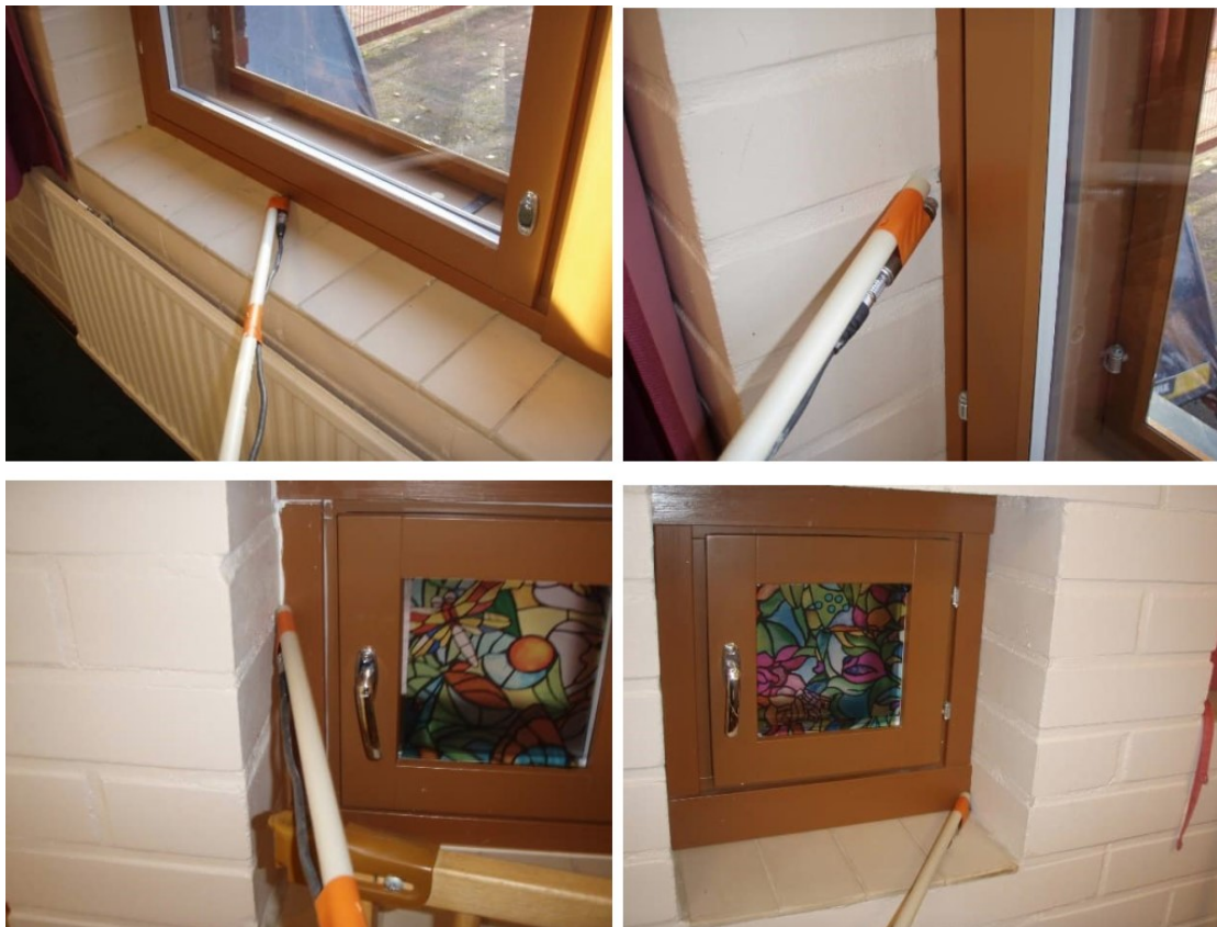
Kuva 55. Ilmavuotoa havaittiin ikkunoiden ala- ja pystyliittymissä.
