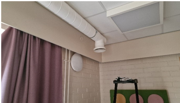
Kuva 95. Yleiskuva kanava-asenteisesta tuloilmaventtiilistä, jonka kartiolautanen on lukitsematta.
