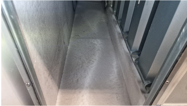
Kuva 74. Tuloilmakammiossa havaittiin pölyä ja roskaa.
