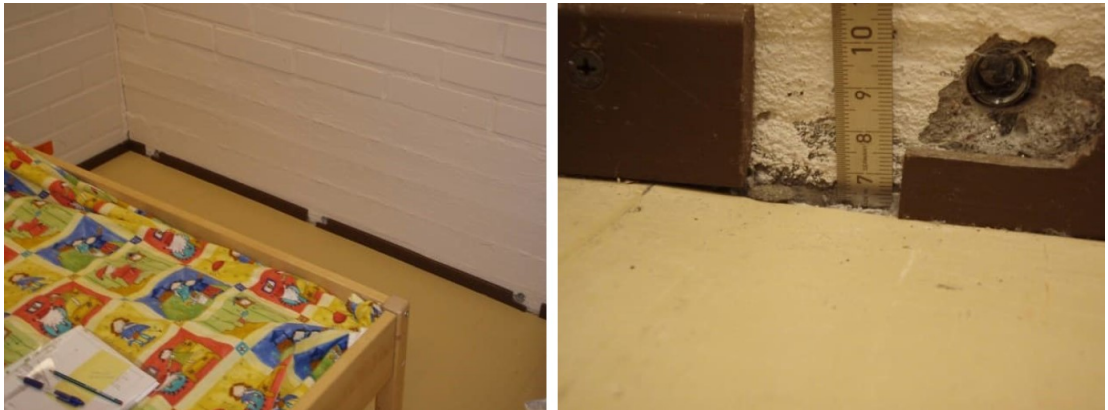
Kuva 19. Tilassa 113 alapohjan ja kantavan väliseinän sekä portaan pielimuurauksen ja kantavan väliseinän liittymissä havaittiin rakoja. Alapohjaliittymän rako ulottuu lähes alapohjalaatan alapintaan. Raossa havaittiin ilmavirtausta.
