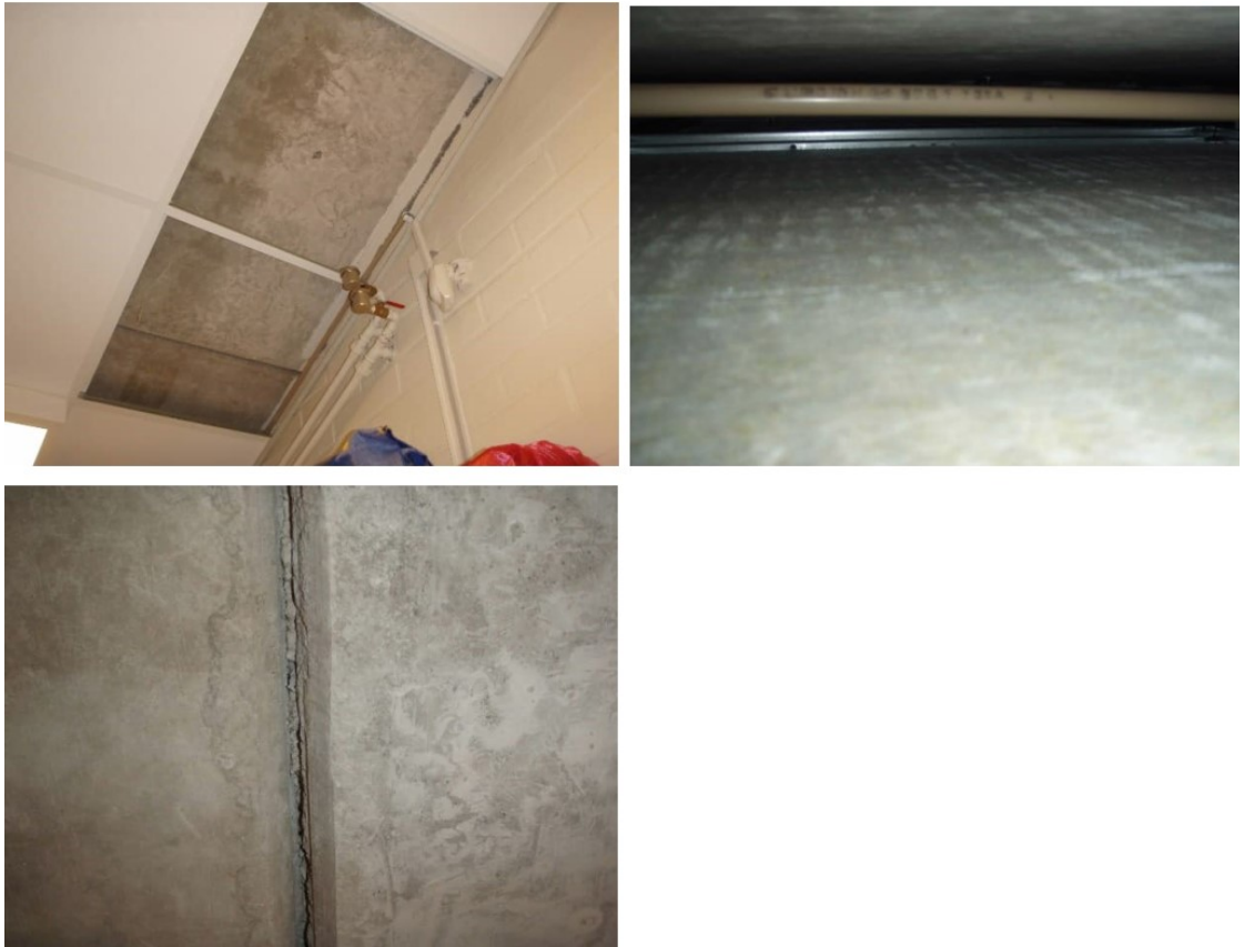
Kuva 65. Alakattoavaus AKA3 varastossa 125 kohdassa, jossa vanhassa alakatossa oli ollut kosteusjälki. Katto oli vuotanut ennen vuotta 2000. Alakattotila on noin 70 mm korkea. Tila ja rakenteet ovat siistit ja hyväkuntoiset. Ontelolaatan saumassa ei havaittu ilmavirtausta.
