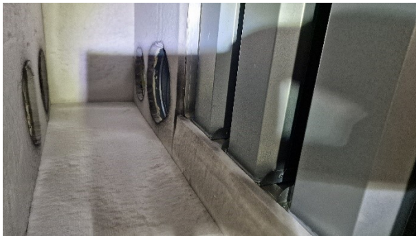
Kuva 75. Tuloilmakammiossa ääneneristyslevyt ovat lievästi nokeentuneet.
