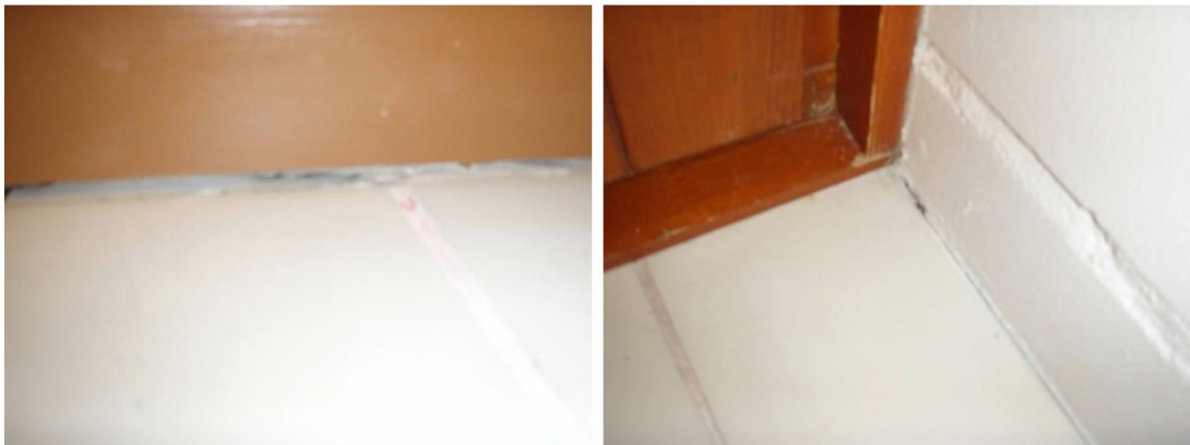
Kuva 45. Sekä alkuperäisten että uudempien ikkunoiden ja ikkunapenkkien liittymissä havaittiin rakoja, joissa todettiin ilmavirtausta.
