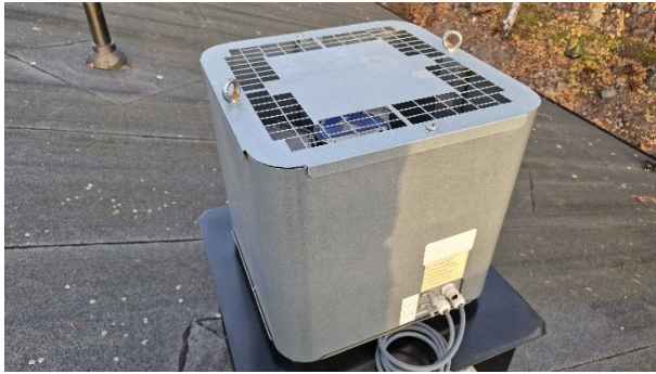
Kuva 78. Yleiskuva, keittiön huippuimurista.
