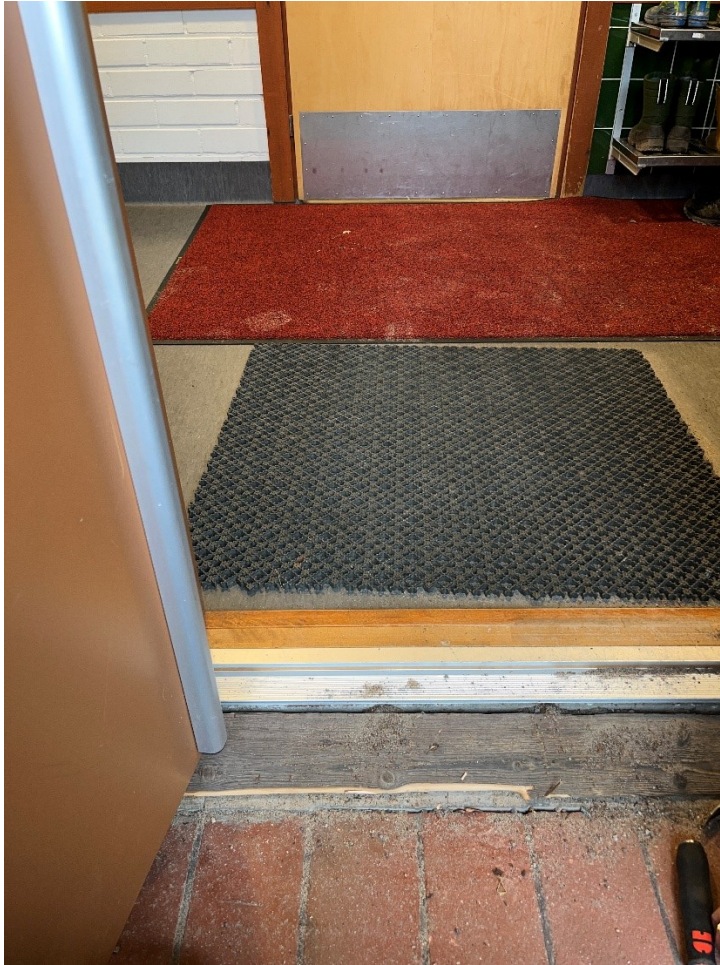
Kuva 24. Kuraeteisen 132 ulko-oven kynnyks ei ole puurakenteinen, vaan kynnyksellä on puinen kiila, jolla ei ole rakenne- eikä sisäilmateknistä merkitystä. Rakente kiilan alla on betonia kuten muiden kuraeteisten ulko-ovilla.
