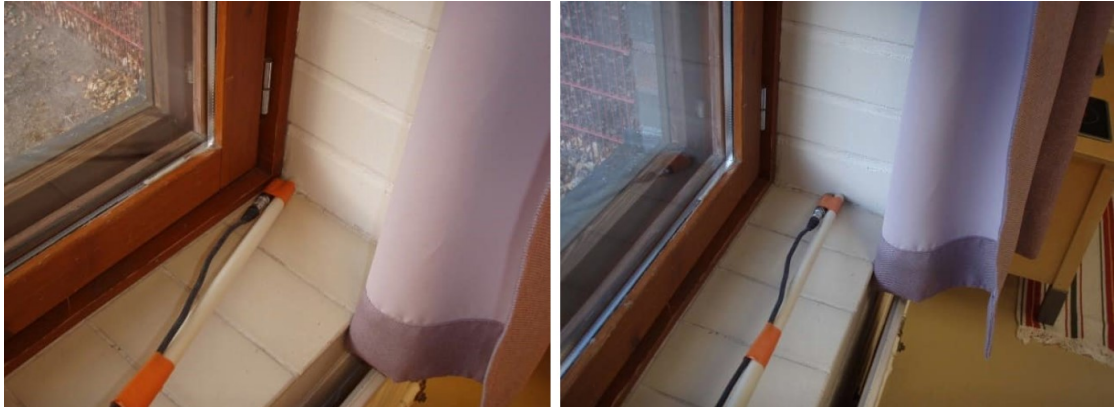
Kuva 52. Ilmavuotoa havaittiin ikkunapenkin liittymissä.
