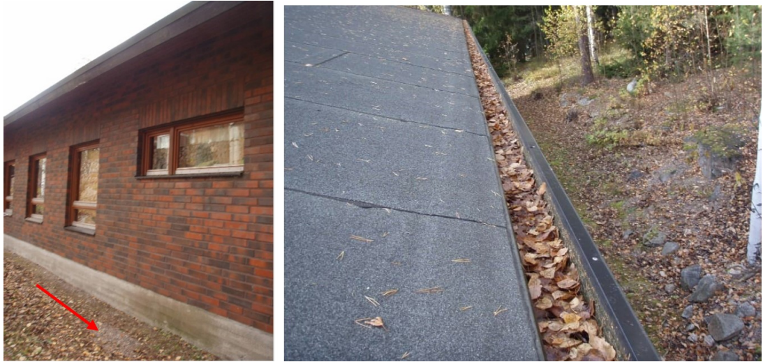
Kuva 34. Wc-tilan 106 kohdalla sokkelin tummuma johtuu räystäskourun tulvimisesta, mikä on havaittavissa sokkelin vierussoran puhtaudesta verrattuna ympäristöön.
