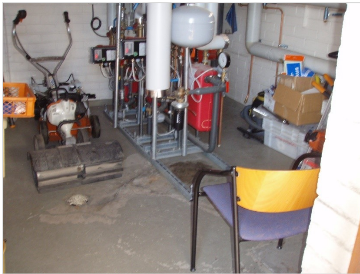
Kuva 23. Lämmönjakuhuoneen alapohjan maalipinta on kulunut, ja alapohjalaatassa on jonkin verran halkeamia. Käyttöveden lämmönsiirtimestä vuotaa vettä lattialle.
