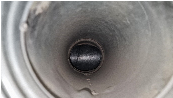
Kuva 91. Poistoilmakanavassa hieman pölykertymää.
