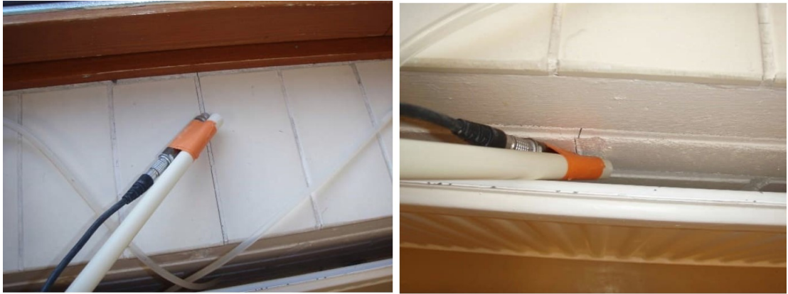
Kuva 53. Ilmavuotoa havaittiin ikkunapenkin ja seinän halkeamien kohdalla.
