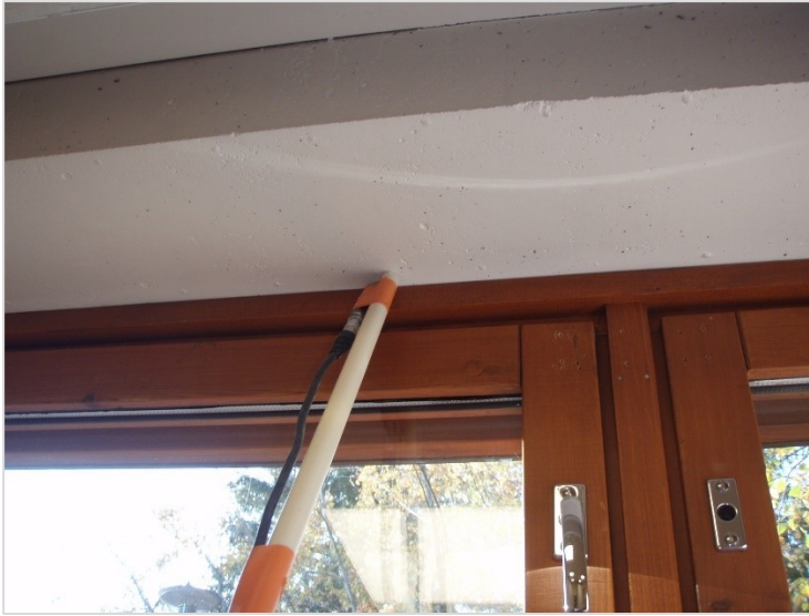
Kuva 67. Ilmavuotoa havaittiin ikkunan yläpuolisessa palkki liittymässä.
