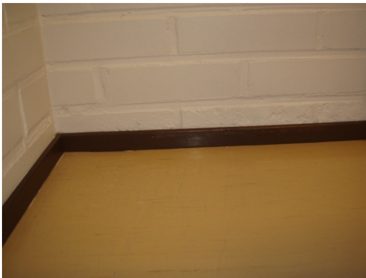
Kuva 43. Tilassa 136 ulkonurkassa seinän alaosan pinta on epätasainen. Epätasaisella alueella pintakosteusilmäsimen lukema (62-64) ei poikennut viereisten alueiden alimman tiilikerroksen lukemista (58-65).
