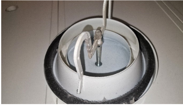
Kuva 97. Yleiskuva poistoilmaventtiilistä, jossa hieman pölykertymää.
