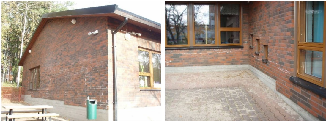
Kuva 33. Julkisivussa on jälkiä pois pestystä graffitista ja liitupiiirroksia. Tilojen 113, 124 ja 136 pitkien sivujen ulkoseinät ovat osin maan pinnan alapuolella (oikea kuva). Maan pinta nousee siten, että pitkän sivun lounaispäädyssä lattiapinta on noin 3 cm ylempänä kuin viereinen maanpinta. Sisäportaiden edessä lattiapinta on noin 10-15 cm alempana kuin viereinen maanpinta. Sisäportaat ovat maan pinnan alapuolella. Lounaispäädyssä lattiapinta on noin 25 cm ylempänä kuin viereinen maanpinta.
