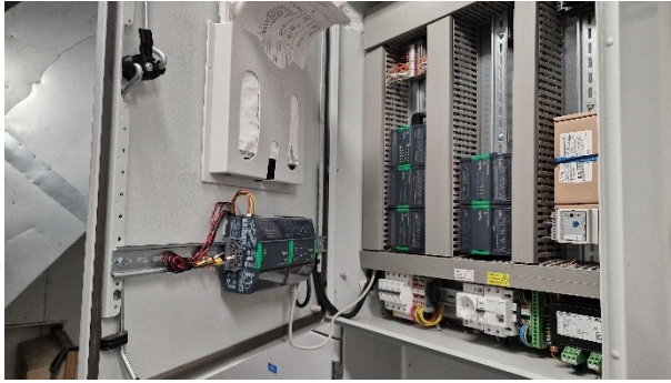
Kuva 99. Yleiskuva Schneider Electric -rakennusautomaatiojärjestelmän alakeskuksesta.
