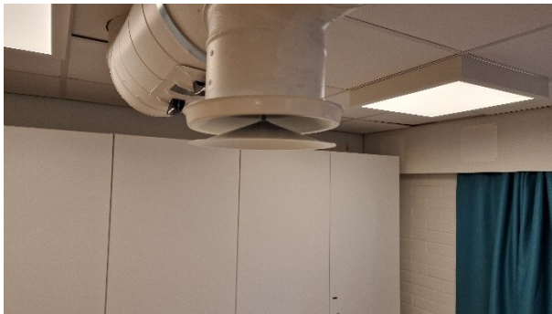
Kuva 94. Yleiskuva kanava-asenteisesta tuloilmaventtiilistä, jonka kartiolautanen on lukitsematta
