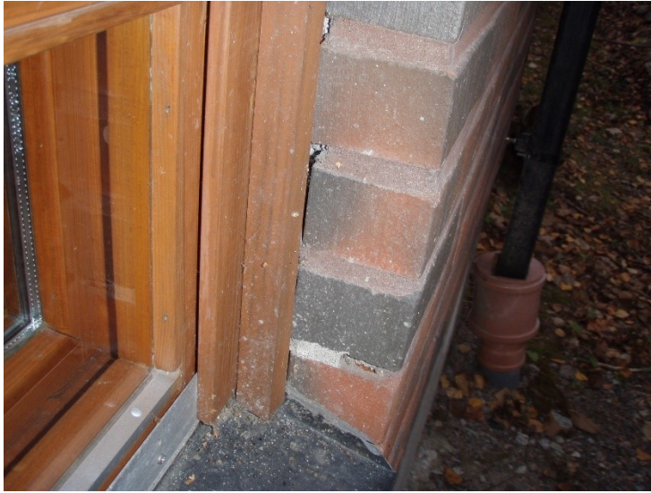
Kuva 40. Alkuperäisten ikkunoiden julkisivuliittymissä on rakoja.
