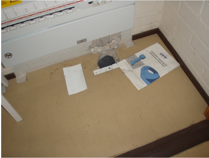
Kuva 22. Sähkökeskusten lattiat olivat varsin siistit. Yhden sähkökeskuksen alapohjassa on avoin, tyhjä putki. Putkessa ei havaittu ilmavirtausta.
