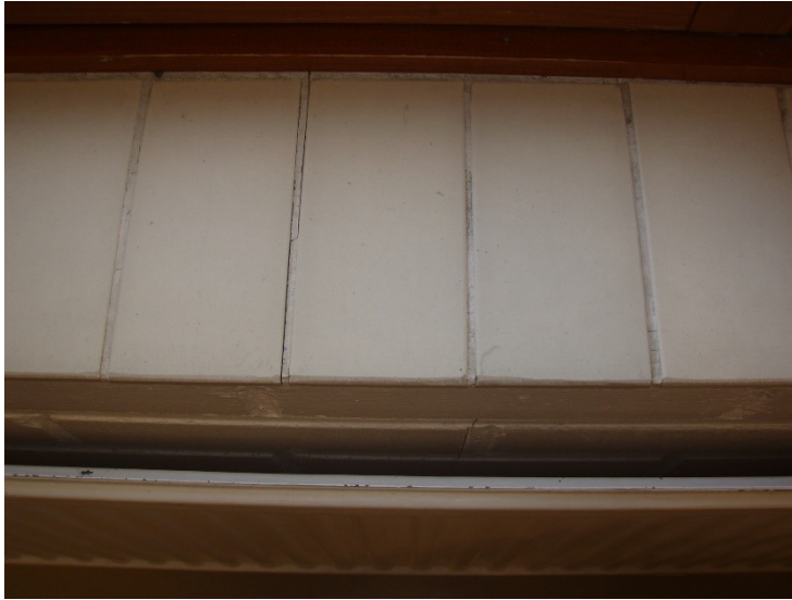
Kuva 44. Ikkunapenkkien keraamisen laatoituksen laastisaumoissa oli paikoin halkeilua.
