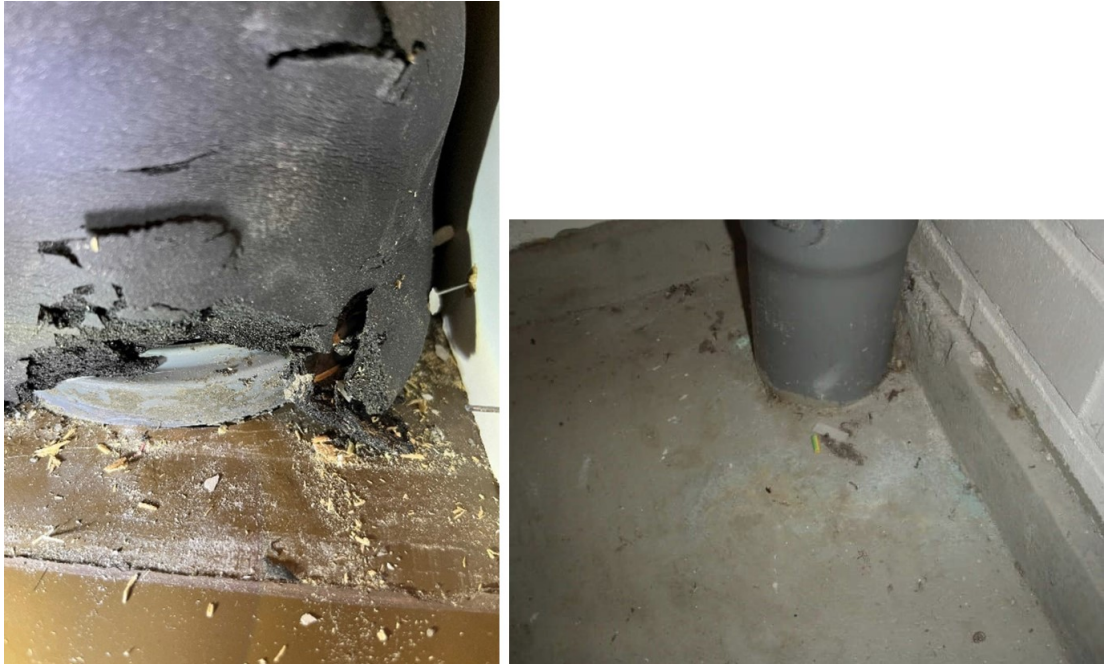
Kuva 20. Alapohjan läpiviennit ovat valussa, niitä ei ole erikseen tiivistetty. Osassa läpivientejä havaittiin rakoa putken ja alapohjarakenteen liittymässä.
