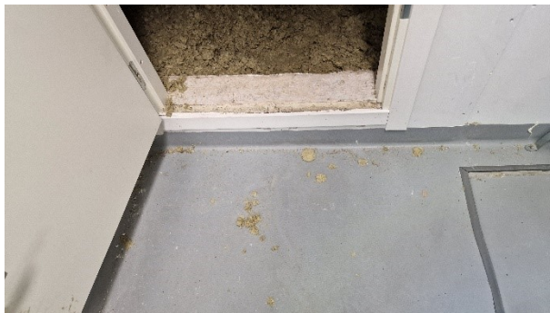
Kuva 103. Luukun kohdalla ei ole kulkusiltaa, minkä seurauksena ullakolla liikuttaessa mineraalivillakuituja kulkeutuu konehuoneeseen.
