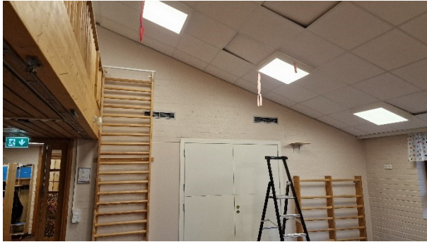
Kuva 93. Yleiskuva seinäasenteisista tuloilman päätelaitteista.
