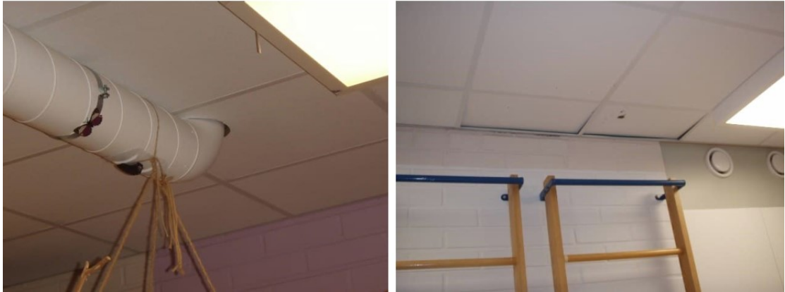
Kuva 66. Alakattojen läpivientien kohdalla mineraalivillalevyjen leikkauspintaa ei ole pinnoitettu. Tilassa 136 mineraalivillalevyn pinnoite on rikki.
