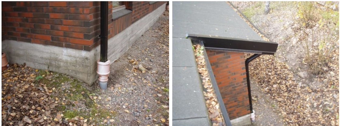
Kuva 35. Varastotilan 125 nurkalla sokkelin tummuma on peräisin vanhasta tilanteesta, jolloin katon sadevedet johdettiin suoraan maahan, josta vesi on roiskunut sokkelille. Nyt sadevedet johdetaan putkella suoraan sadevesijärjestelmään.
