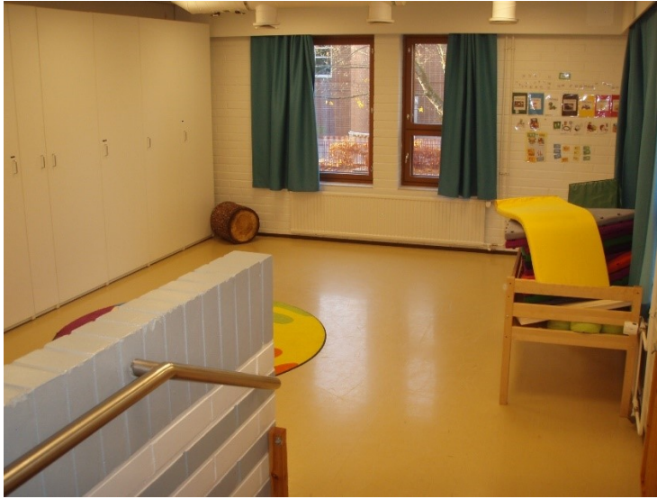
Kuva 42. Ulkoseinien sisäpinnat ovat hyväkuntoiset. Tilojen 113, 124 ja 136 yhdellä ulkoseinällä on sänkykaapit. Seinien yläosassa on lastulevykoteloita, joissa on tarkastusluukkuja, ks. kohta 6.4 ja liite 2.
