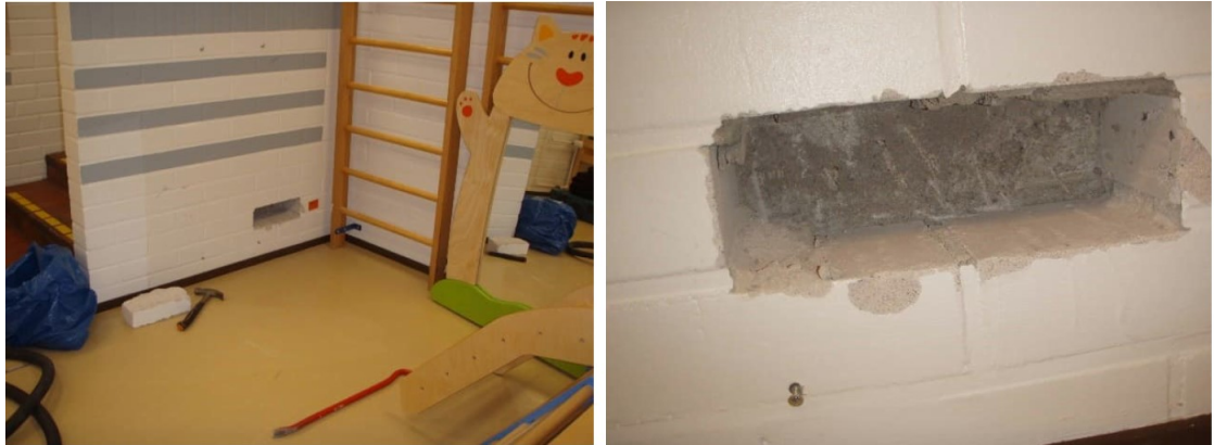
Kuva 26. Sisäportaan pielimuurauksen rakenneavauksessa ei havaittu suunnitelman mukaista pahvia. Tiilimuurauksen takana on portaan paikalla valettu betonirakenne.
