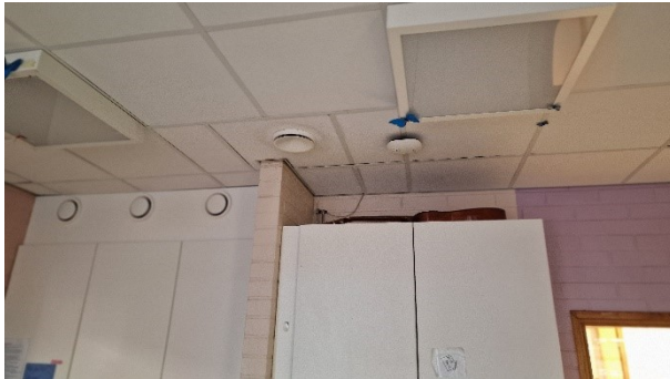
Kuva 98. Yleiskuva poistoilmaventtiilestä. Kuvassa on myös yksi tuloilmaventtiili.
