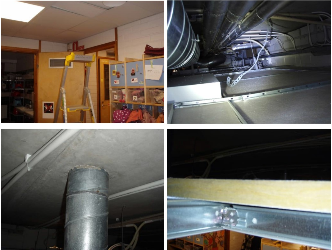
Kuva 64. Alakattoavaus AKA2 käytävällä 107. Alakattotila on korkea, ja siellä on talotekniikka-asennuksia. Yksittäinen pinnoittamaton putkieristeen pää havaittiin. Yläpohjan kanavaläpiviennissä on rakoja, mutta ilmavirtausta ei havaittu. Alakattolevyn leikkauspintaa ei ole pinnoitettu.
