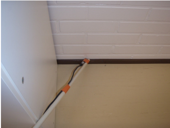
Kuva 25. Ilmavuotoa havaittiin väliseinän yhden tiilisauman kohdalla.
