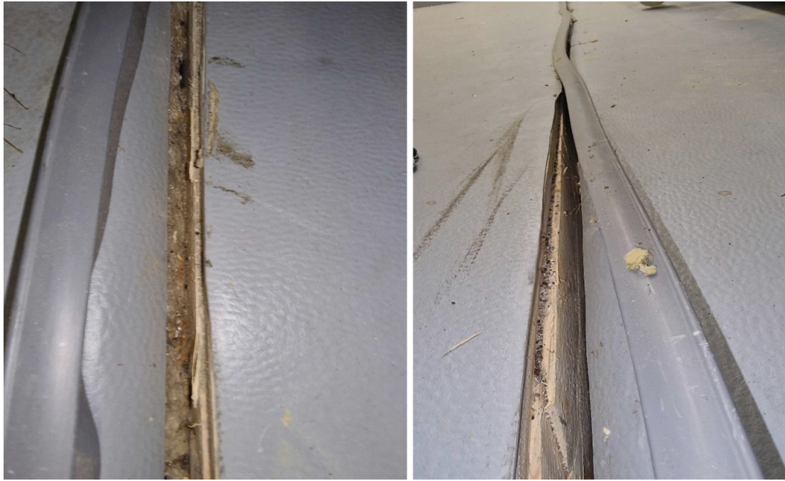
Kuva 30. Ilmanvaihtokonehuoneessa on muutaman sentin korkuinen pykällyys ja rako, jossa on muovilista, mutta se ei tiivistä rakenteita asianmukaisesti.
