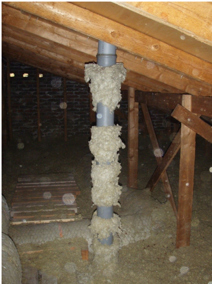
Kuva 62. Viemärin tuuletusputken lämmöneriste on puutteellinen.
