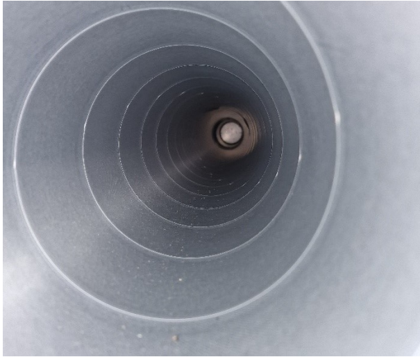
Kuva 89. Pääosin puhdas tuloilmakanava, muutamia pieniä epäpuhtauksia.
