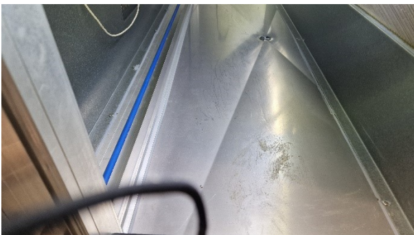
Kuva 73. Tuloilmakoneen LTO- kammiossa on hieman pölyä.
