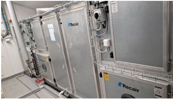
Kuva 68. Yleiskuva ilmanvaihtokoneesta TK1/PK1.
