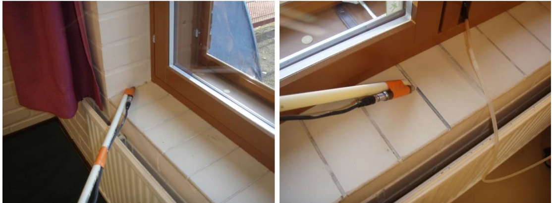
Kuva 56. Ilmavuotoa havaittiin ikkunapenkin liittymissä ja halkeamassa.
