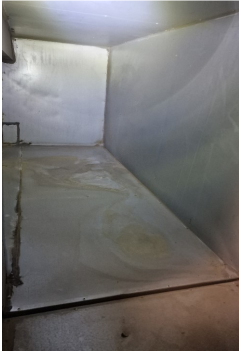
Kuva 69. Tuloilmakoneen raitisilmakammiossa ei ole viemäröintiä
