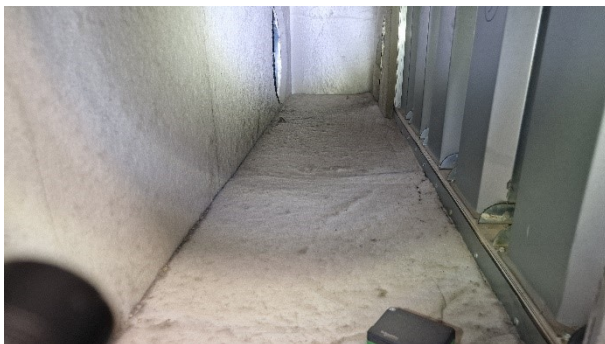
Kuva 76. Poistoilmakammiossa on havaittavissa pölykertymää.
