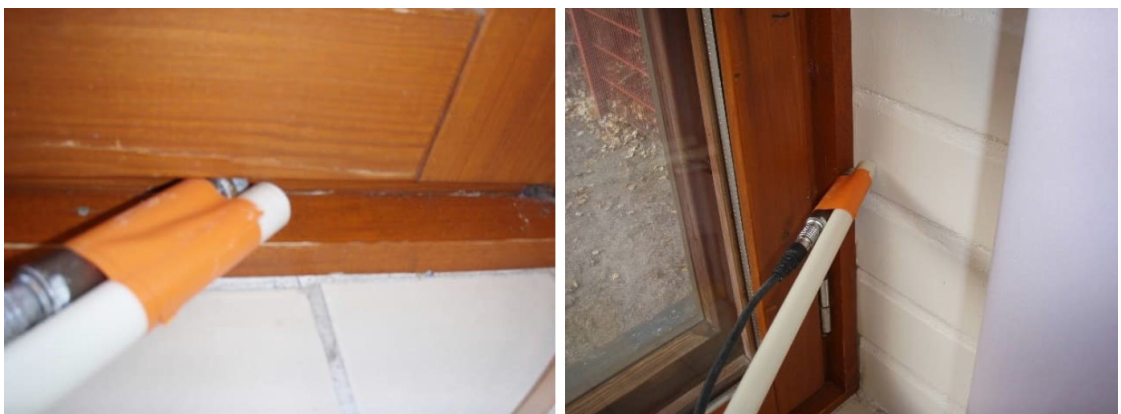
Kuva 51. Ilmavuotoa havaittiin ikkunan ala- ja pystyliittymissä.
