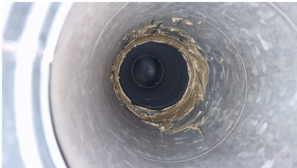
Kuva 86. Kuvassa tiivistetty kanavaliitos, mutta muuten puhdas tuloilmakanava.
