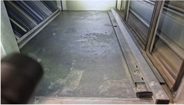
Kuva 70. Tuloilmakoneen suodatuskammiossa havaittiin hieman pölyä ja vanhoja kosteusjälkiä.
