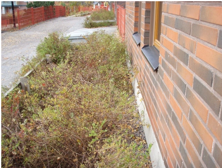
Kuva 2. Lounaissivulla pensaat ovat kasvaneet lähelle julkisivua. Sokkelivierellä maanpinta on sorastettu.
