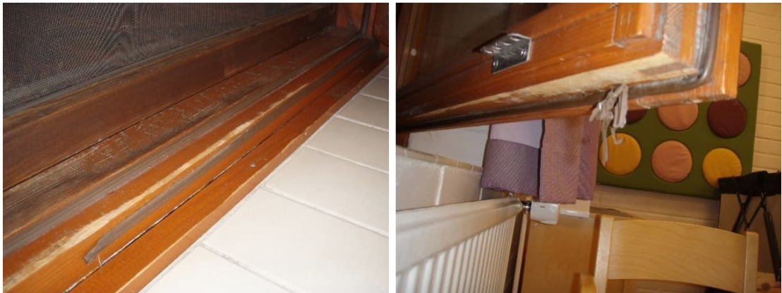
Kuva 41. Luoteispäädyn alkuperäisen ikkunan maalipinta on kulunut ja tiivisteet rikki. Ikkunan käynnissä on puutteita.
