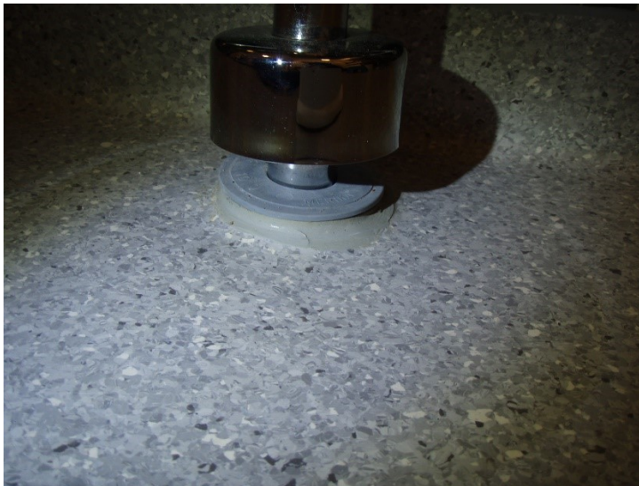
Kuva 15. Uudempien muovimattojen pesuallasviemärin liittymässä on joustava massa, mutta vedeneristeenä toimivaa muovimattoa ei ole nostettu viemäriputkea vasten. Näillä alueilla ei havaittu poikkeavia pintakosteusilmaisimen lukemia. Viemäriliittymässä on HK-tiivisteet.
