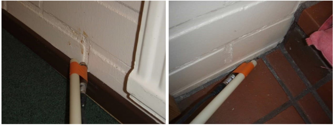
Kuva 54. Ilmavuotoa havaittiin alapohjaliittymässä tiilisaumojen kohdalla.
