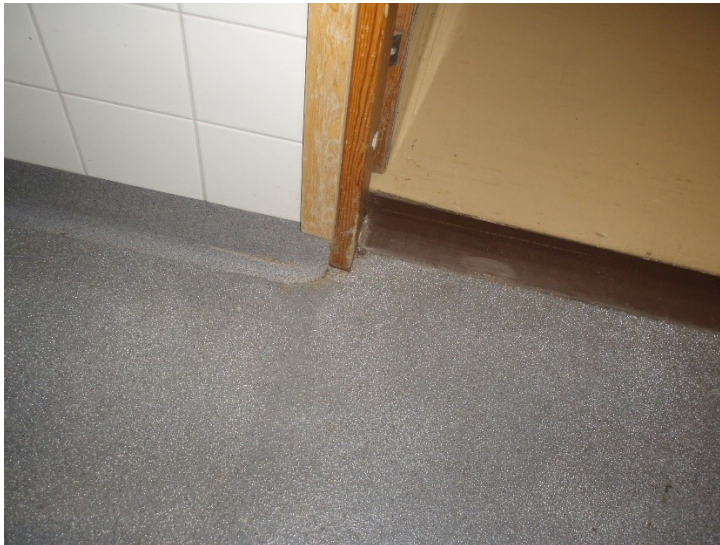
Kuva 21. Keittiössä on hyväkuntoinen akryylibetonilattia, joka on nostettu seinille, mutta ei kynnykselle. Oven pielissä pinnoitteessa on pienet raot. Ovien pielissä eikä kynnyksalueella havaittu poikkeavia pintakosteusilmaisimen lukemia. Ovikarmin puu oli kovaa.
