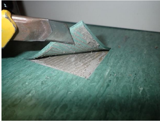
Kuva 22. Viiltomittauksessa VM1 ei poikkeavaa hajua, tasoite irti alustastaan.
