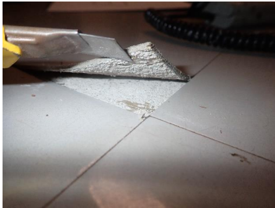
Kuva 26. Viiltomittauksessa VM 5 vinyylilaatan alla havaittiin lievä kemikaalimainen haju. Laatan tartunta alustaansa oli heikko.
