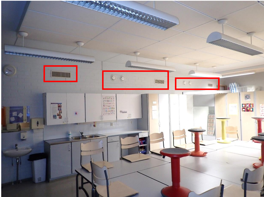
Kuva 120. Alkuperäisosan opetustilojen tyypillinen ilmanjakotapa. Tulo- sekä poistoilmapäätelaitteet on sijoitettu käytävän puoleisiin väliseiniin.
