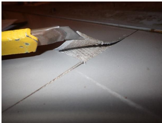
Kuva 24. Viiltomittauksessa VM3 vinyylilaatan alla havaittiin lievä kemikaalimainen haju. Laatan tartunta alustaansa oli hyvä.
