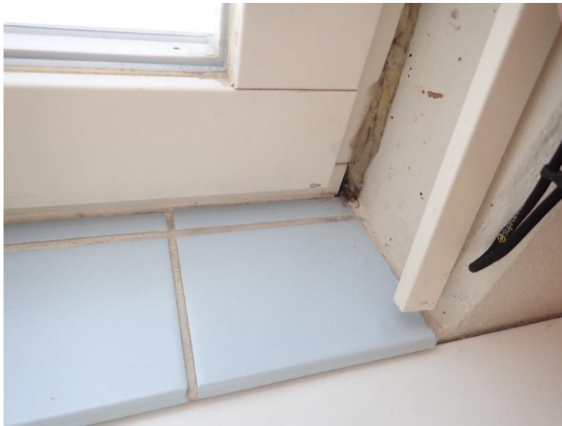
Kuva 75. Ulkoseinän ja ikkunoiden välinen liittymä on tiivistetty vanhalla osalla mineraalivillalla. Rakenneliittymä ei ole ilmatiivis.
