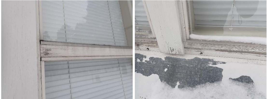
Kuvat 66 a ja b. Ikkunoiden ulko-osien maalipinnoitteessa havaittiin paikoin puutteita. Maalipinnoite on paikoin irronnut alustastaan ja hilseillyt.
