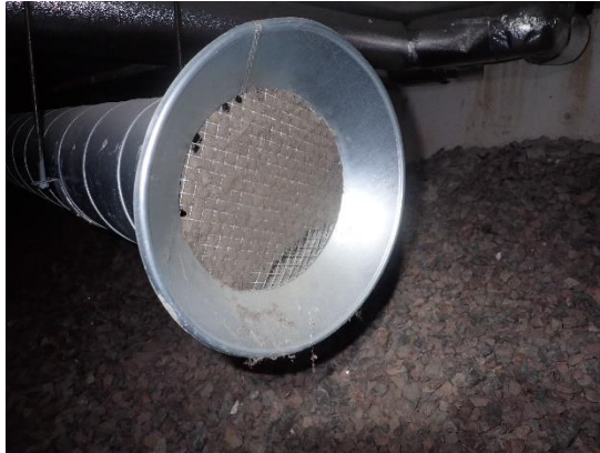
Kuva 48. Ryömintätilan poistoilmanvaihdon imukartiot olivat osin tukkeutuneet pölystä.
