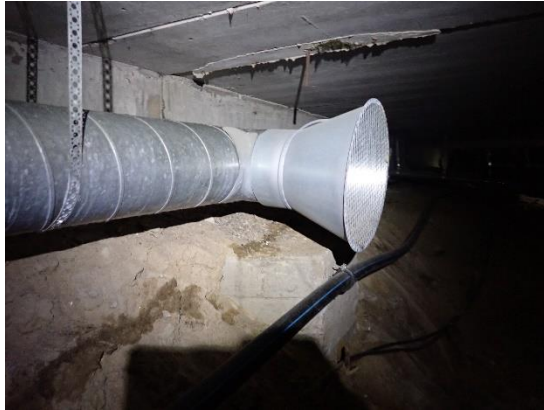
Kuva 38. Ryömintätilan ilmanvaihtokanavissa oli merkkejä kosteuden tiivistymisestä. Tiivistynyttä vettä on tippunut alustäyttöön.
