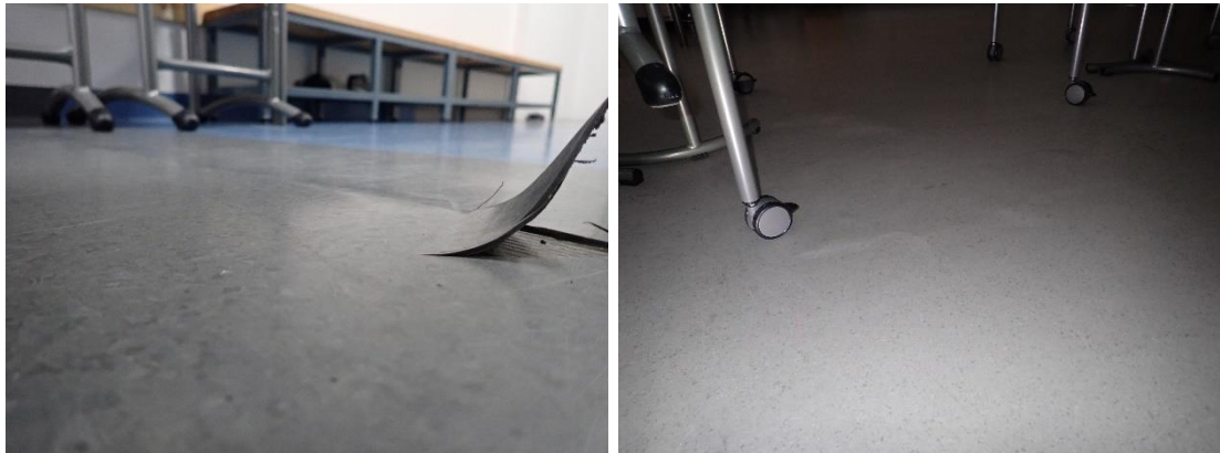
Kuva 21 a ja b. Muutamissa kohdissa laajennusosalla muovimaton alusta (tasoite) on halkeillut ja muovimatto, sekä tasoite on irti alustastaan.
