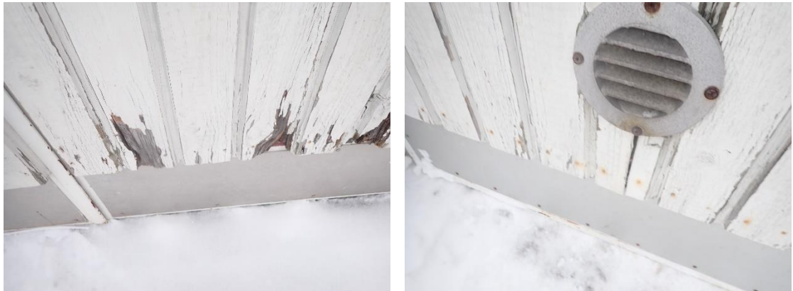
Kuvat 72 a ja b. Ulko-ovien ulkopinnan laudoituksen alaosaan on lahovaurioita.
