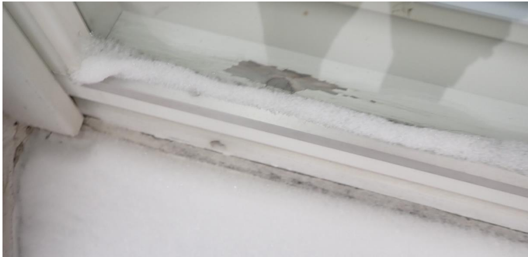
Kuva 68. Ikkunakarmin maalipinnoitteessa havaittiin yksittäisiä puutteita maalipinnoitteessa. Maalipinnoite oli paikoin irronnut alustastaan.
