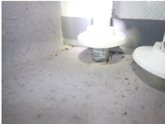
Kuva 17 a ja b. Muovimaton viemäriläpivienneissä havaittiin yksittäisiä vesitiiveyspuutteita.
