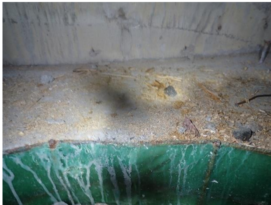
Kuva 49. Ryömintätilan ilmanvaihtokanavissa havaittiin kosteuden tiivistymistä. Tiivistynyttä vettä on tippunut alustäyttöön.
