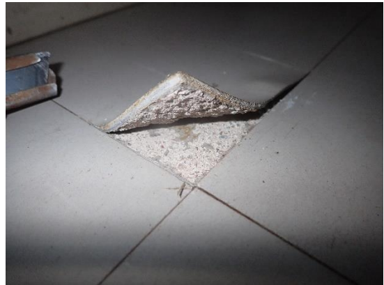
Kuva 27. Viiltomittauksessa VM 6 vinyylilaatan alla havaittiin lievä kemikaalimainen haju. Laatan tartunta alustaansa oli heikko.
