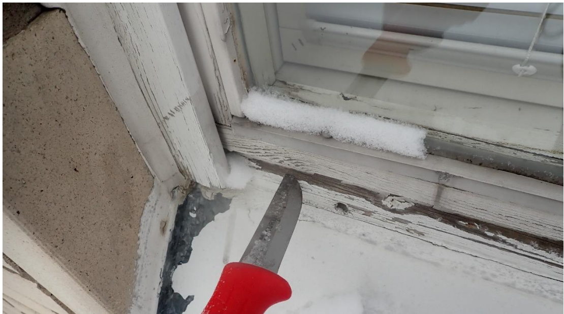
Kuva 67. Ikkunoiden ulko-osien puuaineksessa havaittiin paikoin pinnan pehmenemistä.
