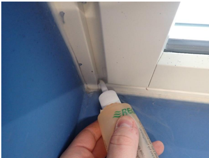
Kuva 76. Ulkoseinän ja ikkunoiden välinen liittymä uudella osalla on tiivistetty polyuretaanivaahdolla. Merkkisavulla on havaittavissa
