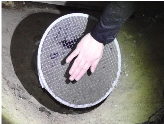
Kuva 36. Ryömintätilan tuuletuksen imukartiot olivat osin tukkeutuneet pölystä.
