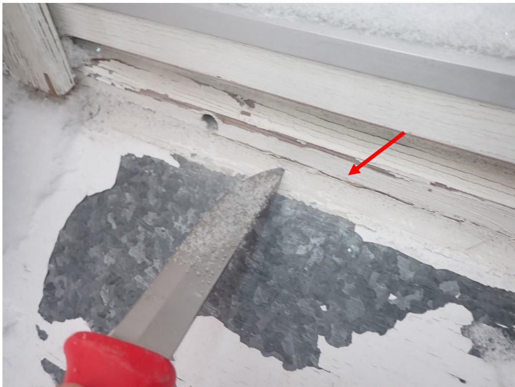
Kuva 69. Ikkunan alakarmin ja vesipellin välinen liittymä on tiivistetty tiivistysmassalla. Tiivistysmassa oli paikoin irti vastepinnaltaan (osoitettu nuolella).
