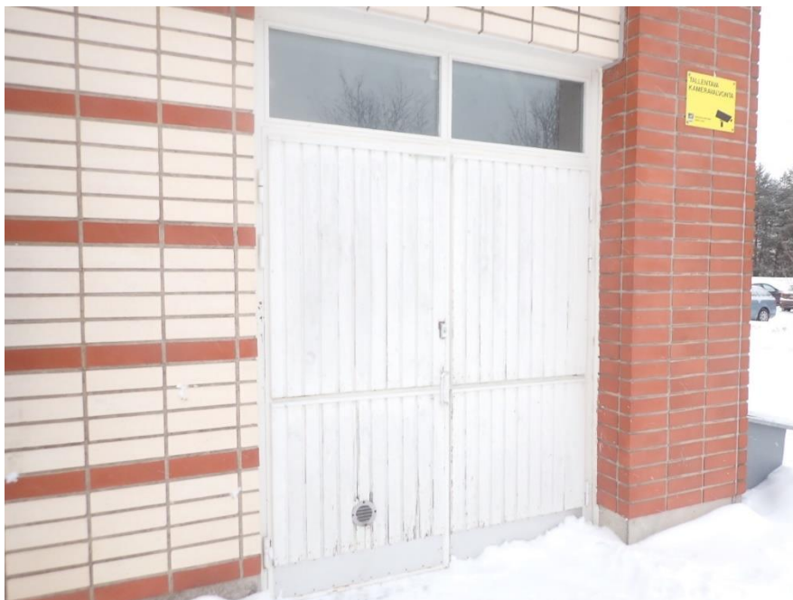
Kuva 71. Yleiskuva rakennuksen ulko-ovista. Ulko-ovet ovat yleisilmeeltään tyydyttävässä kunnossa. Ovien maalipinnoitteen kunnossa havaittiin puutteita, kuten maalipinnan hilseilyä ja paikallista irtoamista.
