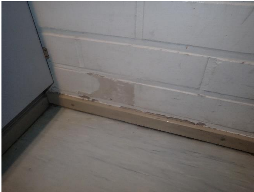
Kuva 84. Luokkatilan 1080 seinän alaosassa kosteuspoikkeamaa ja pinnoitevaurioita.
