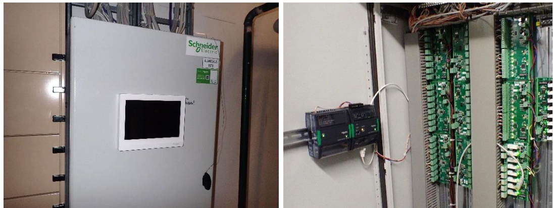
Kuva 121 a ja b. Yleiskuvat rakennusautomaation valvonta-alakeskuksista. Kuvassa a on lämmönjakuhuoneen valvonta-alakeskus ulkopuolelta ja kuvassa b toisen ilmanvaihtokonehuoneen valvonta-alakeskuksen sisältä.
