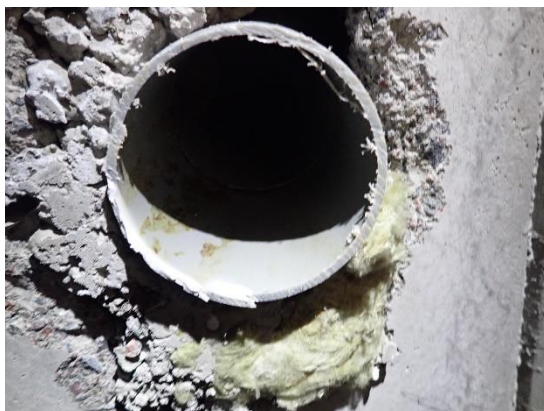
Kuva 35. Ryömintätilassa on muutamia katkaistuja ja tulppaamattomia viemäriputkia. Putkissa ei havaittu selkeitä ilmavirtausta tai hajuja.
