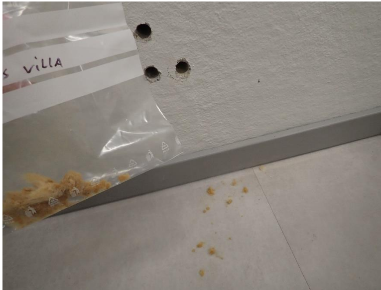
Kuva 74. Tilan 0044 päädyn maanvastaiseen ulkoseinään tehtiin rakennetarkastusreikä, jonka perusteella rakenteessa on käytetty lämmöneristeenä mineraalivillaa. Mineraalivillasta otettiin materiaalinäyte 1, jossa ei ollut mikrobikasvustoa.
