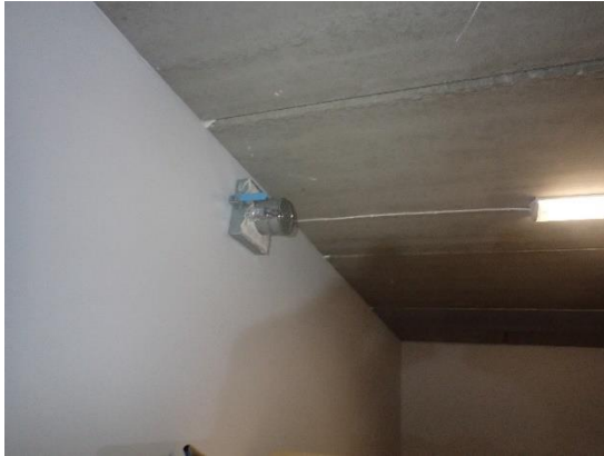
Kuva 46. Liikuntasalin viereinen välinevarasto on alipaineistettu koneellisesti liikuntasaliin nähden.
