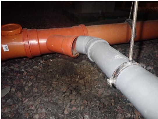
Kuva 47. Ryömintätilassa havaittiin yksi viemäriputki, joka oli irti liitoksestaan. Putki asennettiin takaisin sekä puutteesta ilmoitettiin kohteen huoltomiehelle/vahtimestarille. Liitos ja putken kannakoinnit on tarkastettava lvi-asentajan toimesta pikaisesti.
