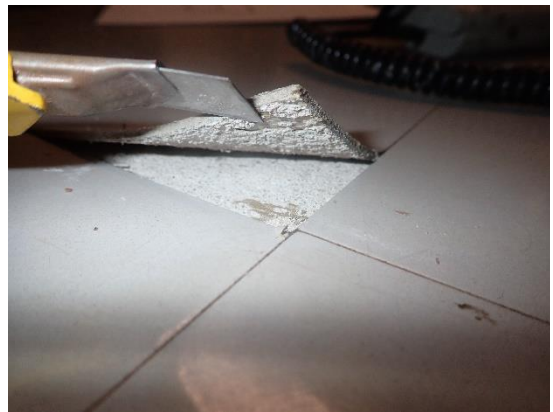
Kuva 25. Viiltomittauksessa VM4 vinyylilaatan alla havaittiin lievä mikrobiperäinen haju. Laatan tartunta alustaansa oli hyvä.
