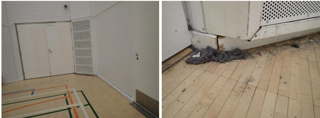
Kuva 103. Liikuntasalissa havaittiin paikoin runsaasti pöly- ja likakertymää.
