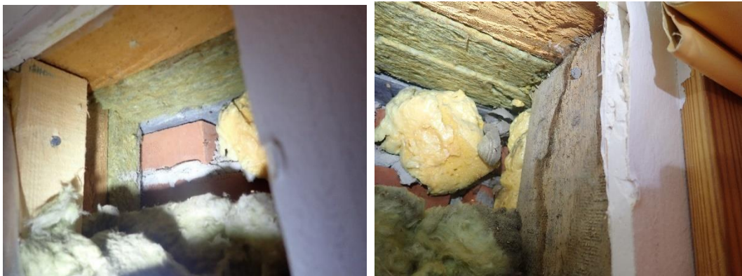
Kuva 35 a ja b. Yleiskuva Leikki- ja lepohuoneen 34 ulkoseinään yläosaan tehdystä rakenneavauksesta (RA6). Rakenteissa on nähtävissä vanhoja kuivuneita vuotojälkiä, jotka mahdollisesti ovat peräisin vanhoista vesikattovuodoista. Rakenne vastaa pääosin alkuperäisiä suunnitelmia US1. Mineraalivillasta otettiin materiaalinäyte MAT14, jossa ei todettu mikrobikasvua.
