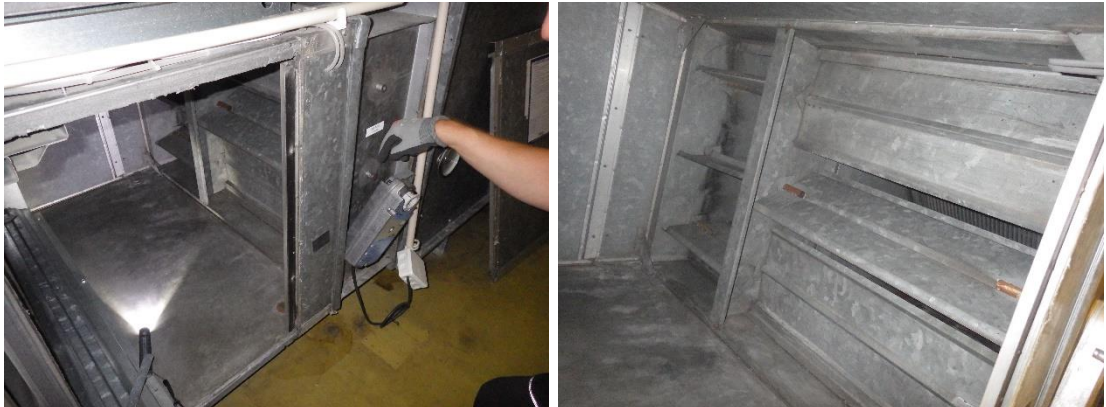
Kuva 51 a ja b. Lämmöntalteenoton säätöpeltien toimilaite on irti akselistaan. Tarkastushetkellä ohituspellit ja LTO:n keskimäinen pelti olivat auki. LTO:n alin ja ylin pelti olivat kiinni.
