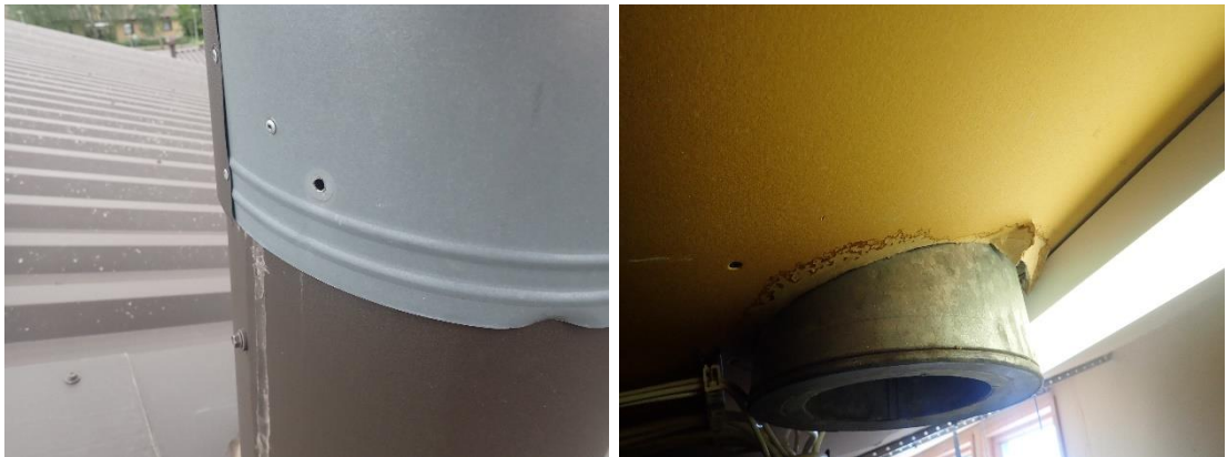
Kuva 41 a ja b. Ilmanvaihtokonehuoneen tuuletusputkessa havaittiin mahdollisia epätiivelyskohtia. Ilmanvaihtokonehuoneen sisäkatossa on nähtävissä kosteusjälkiä tuuletusputken ympärillä.
