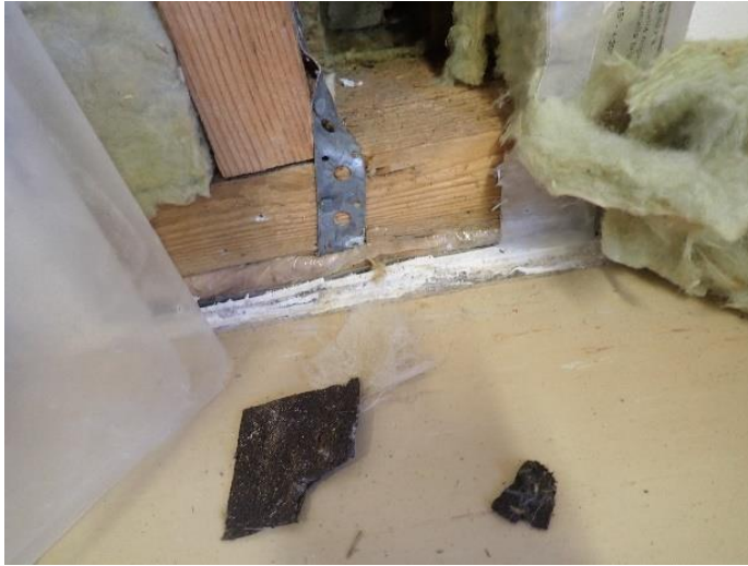
Kuva 34. Yleiskuva Leikki- ja lepohuoneen 11 ulkoseinän alaosaan tehdystä rakenneavauksesta (RA3). Kovan mineraalivillan takana havaittiin kermi. Ulkoseinän rakenneavauksesta havaittiin mikrobiperäistä hajua. Mineraalivillasta otettiin materiaalinäytteet MAT6, MAT7 ja MAT8, joissa MAT6 ja MAT7 todettiin mikrobikasvua.
