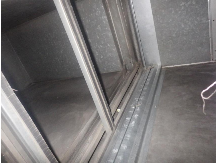
Kuva 50. Suodatinrungot lukituksineen ovat hyvässä kunnossa ja suodattimet asettuvat runkoa vasten tiiviisti.
