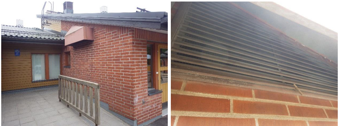
Kuva 49 a ja b. Yleiskuvia tulo- ja poistoilmanvaihtokoneen ilmanottoaukosta. Ulkoilmasäleikkö oli tarkastushetkellä puhdas.
