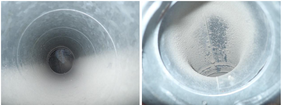
Kuva 57 a ja b. Poistoilmakanavissa on pölykertymää.
