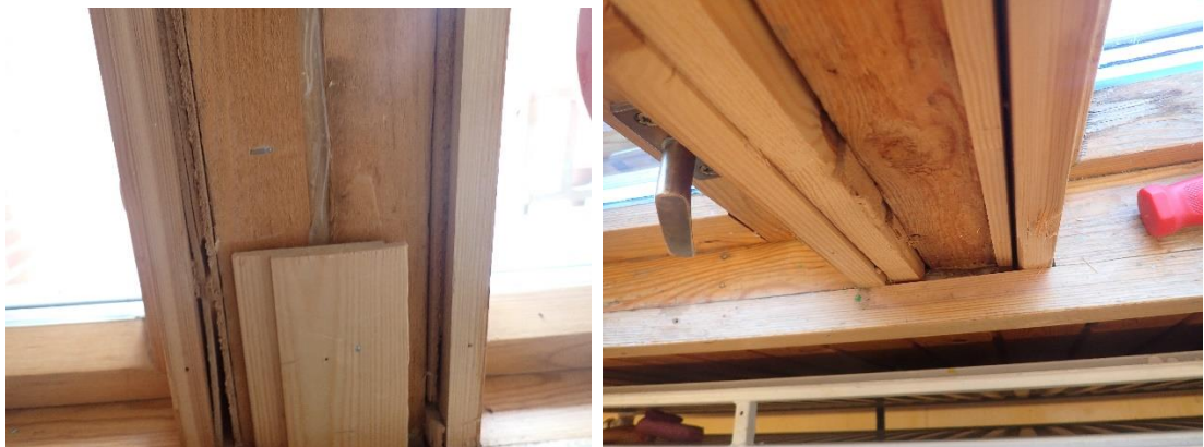
Kuva 36. Ulkoseinän ja ikkunoiden välinen liittymä on tiivistetty mineraalivillalla. Rakenneliittymä ei ole täysin ilmatiivis.
