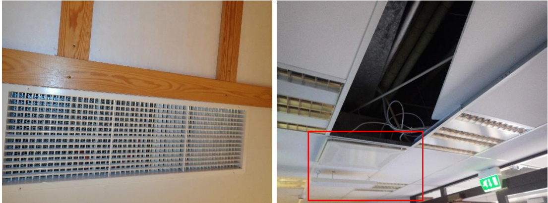
Kuva 58 a ja b. Yleiskuvia tuloilmapäätelaitteista. Suurin osa rakennuksen tuloilmapäätelaitteista on vasemman kuvan mukaisia säleikköjä.
