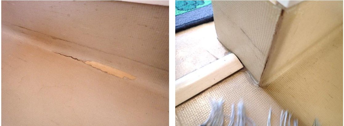
Kuva 12 a ja b. Muovimattopäällysteissä havaittiin yksittäisiä epätiivelyskohtia märkätiloissa.
