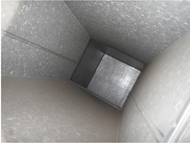
Kuva 56. Tuloilman runkokanava on melko puhdas.
