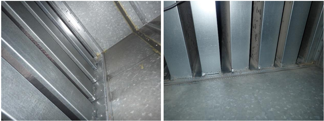
Kuva 53 a ja b. Tuloilmapuolen äänenvaimentimet (vasen kuva) olivat siistit. Poistoilmapuolen äänenvaimentimet (oikea kuva) ovat ennen suodattimia ja niissä todettiin pölykertymää.
