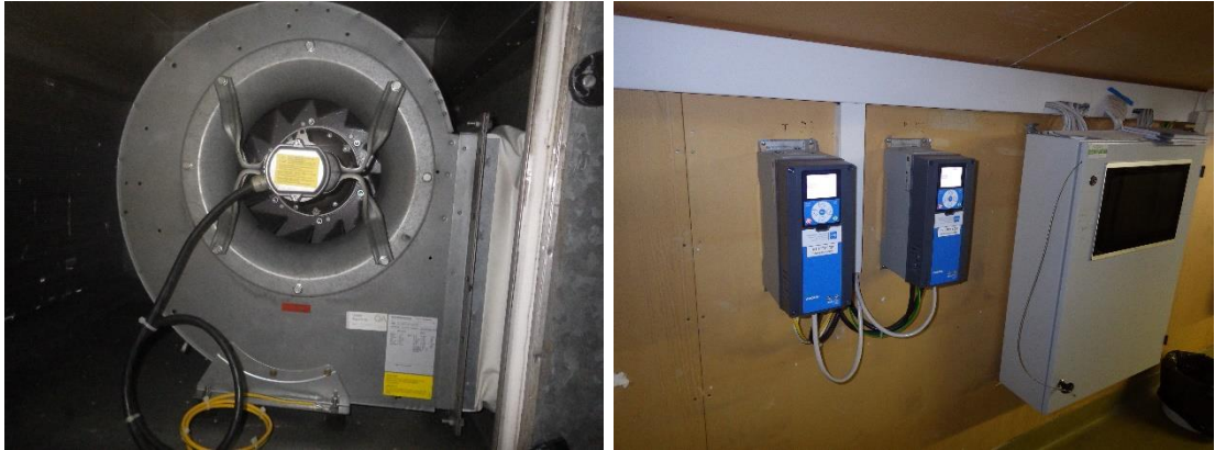
Kuva 52 a ja b. Yleiskuva puhaltimesta ja taajuusmuuttajista.
