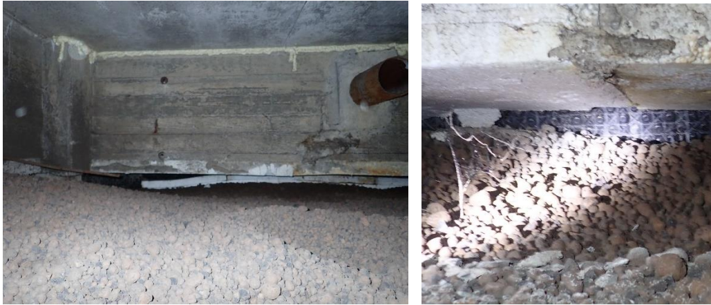
Kuva 23 a ja b. Rakennuksen täytöt ovat monin paikoin painuneet niin, että sokkelipalkin alla on tyhjää tilaa. Kuvat lounaispäädyssä, josta näkyvät myös ulkopuoliset routaeristykset ja perusmuurilevy.
