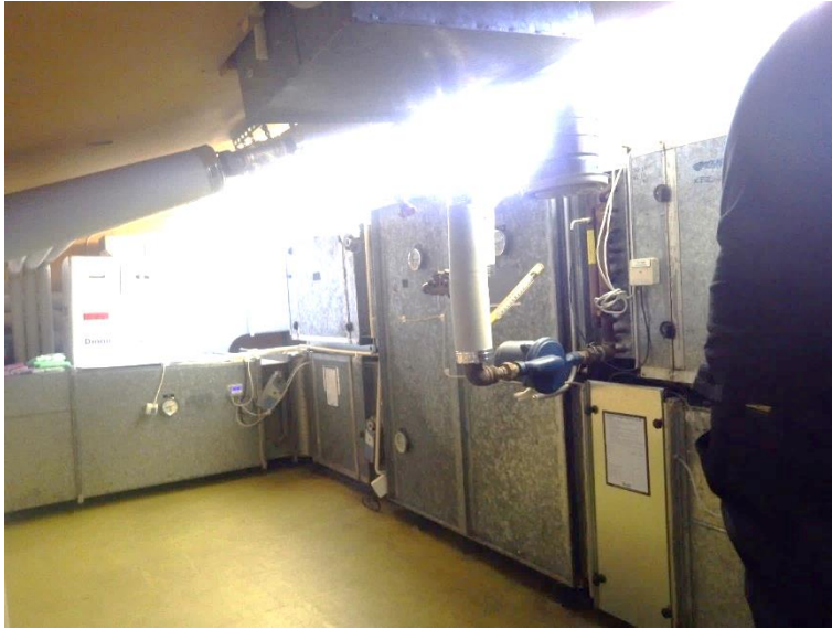
Kuva 48. Yleiskuva ilmanvaihtokoneesta TP1/PP1. Huoltoluukkujen lukitukset ovat osittain rikki. Aistinvaraisen havainnon perusteella poistoilmapuhaltimen huoltoluukku on epätiivis ja kone imee poistoilmaa konehuoneesta.
