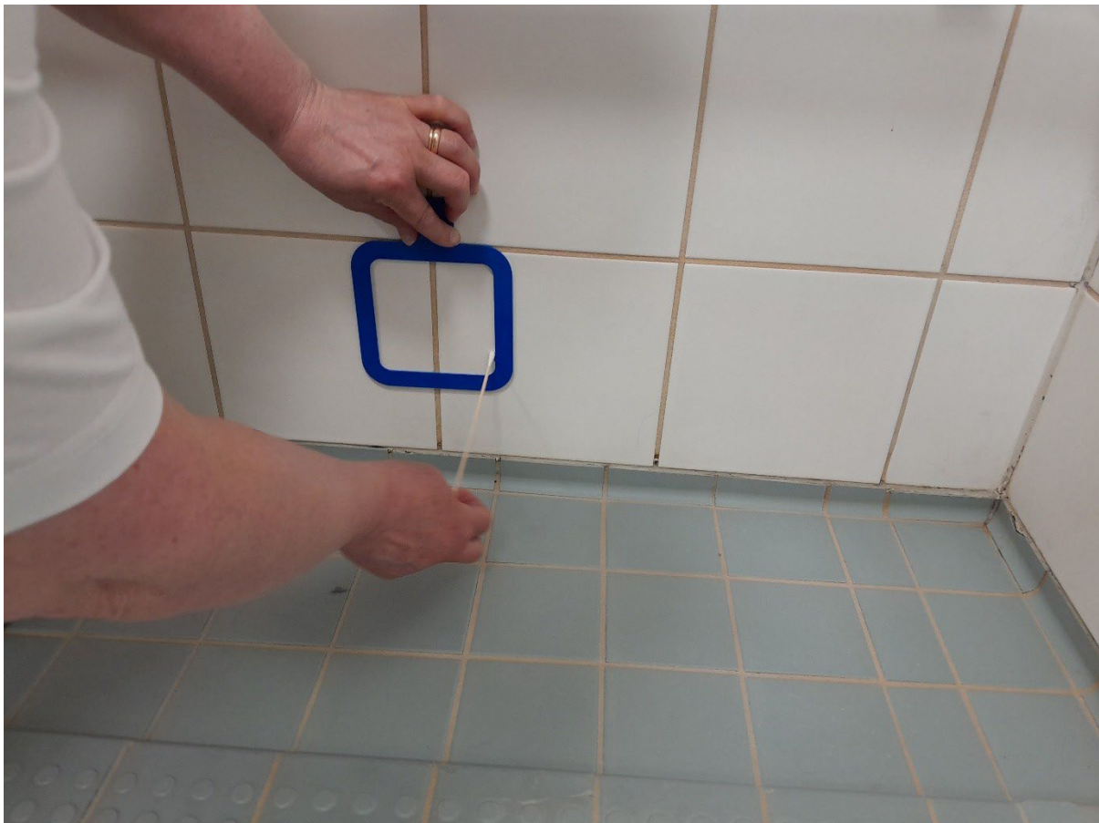
Kuva 5. Suihkuseinän alaosa likaantuu yläosaa enemmän
