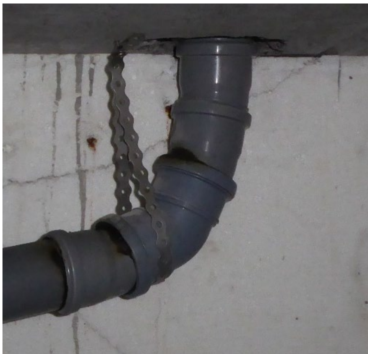
Kuva 10. Tummentumaa viemäriinjan muhviliitoksissa.
