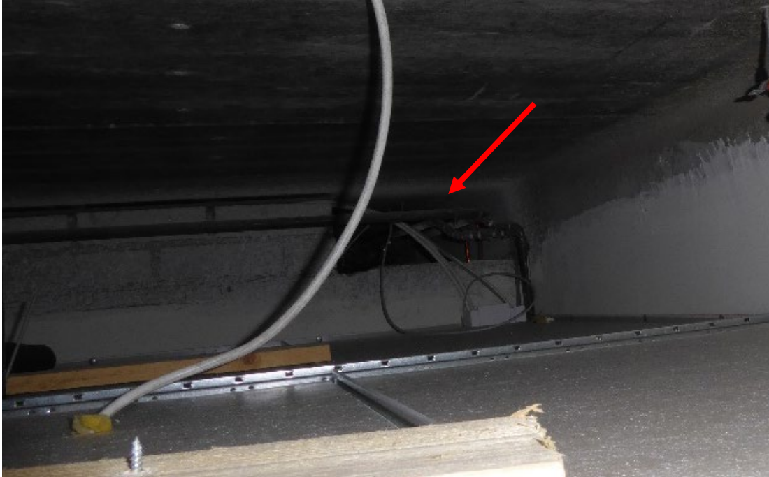
Kuva 22. Esimerkkikuva epätiiviyistä tilojen välisestä läpiviennistä alaslasketun katon yläpuolelta.
