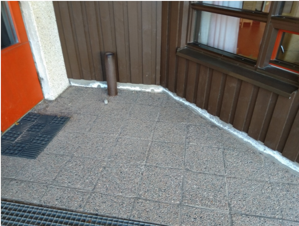
Kuva 4. Kalkkihärmää sokkelissa liikuntahuoneen H40 edustalla.
