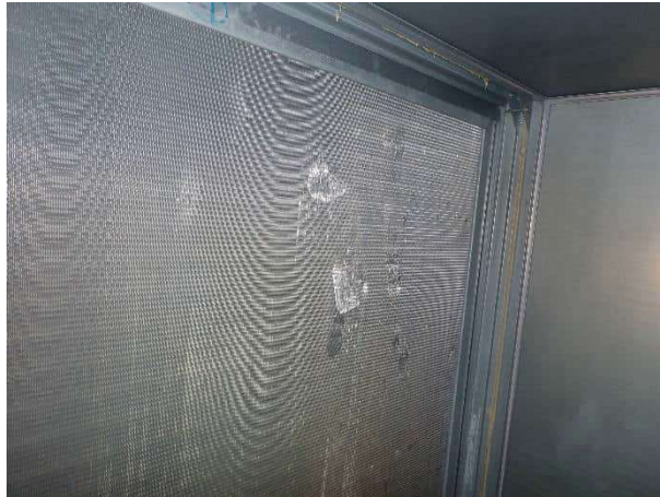
Kuva 14. Painumia ja likaa tuloilmakoneen lämmityspatterissa.
