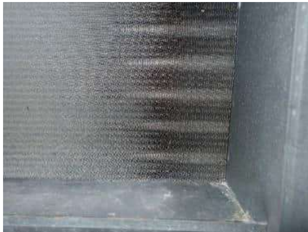
Kuva 25. Hapettumaa ja likaa tuloilmakoneen LTO-patterissa.
