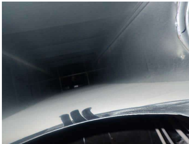
Kuva 39. Kohtalaista pölykertymää poistoilmakanavistossa.
