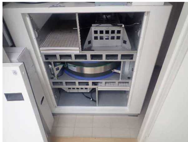
Kuva 34. Yleiskuva ilmanvaihtokoneesta TK030.
