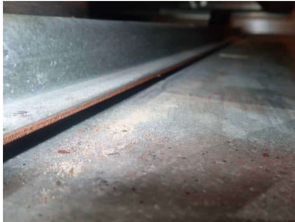
Kuva 32. Tuloilmakoneen puhallinkammiossa havaittiin hienojakoista valkoista jauhemaista ainesta, kosteusjälkiä ja kumimursketta.
