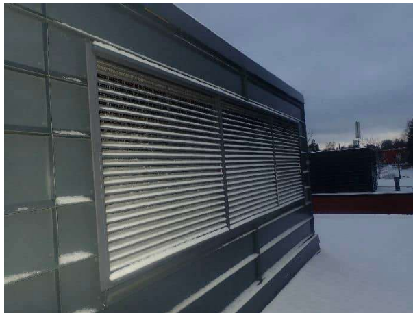
Kuva 42. Yleiskuva vesikatolla sijaitsevasta raitisilman ilmanottoaukosta.
