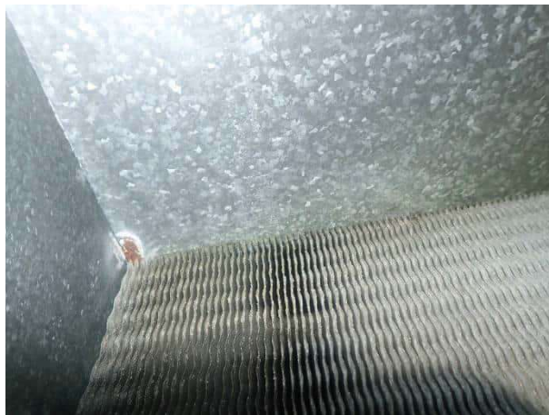
Kuva 30. Tuloilmakoneen LTO-patterin läheisyydessä havaittiin korroosiovaurio.
