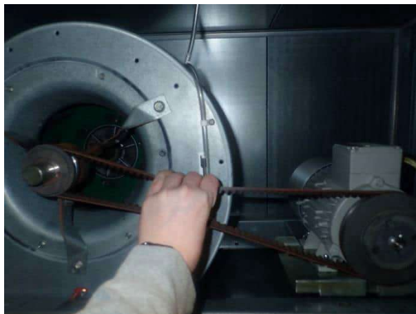
Kuva 20. Tulo- ja poistoilmakoneiden urapyörät sekä -hihnät ovat kuluneet. Hihnojen kireydessä havaittiin myös puutteita.
