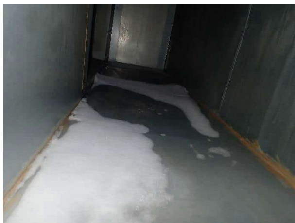
Kuva 4. Tuloilmakoneen TK01 TF1 raitisilmakammiossa havaittiin lunta.
