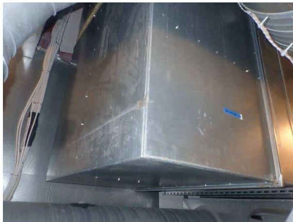
Kuva 22. Raitisilmakammiossa ei havaittu tarkistus-/puhdistusluukkua.
