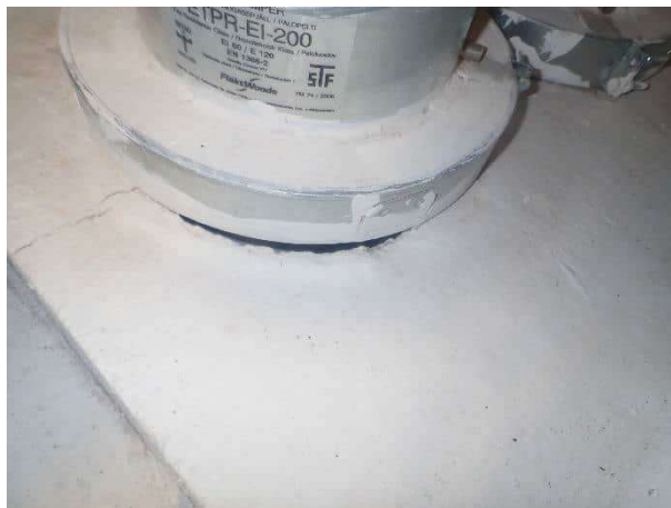
Kuva 40. Palo-osastojen välinen läpivienti ei ole tiivis.
