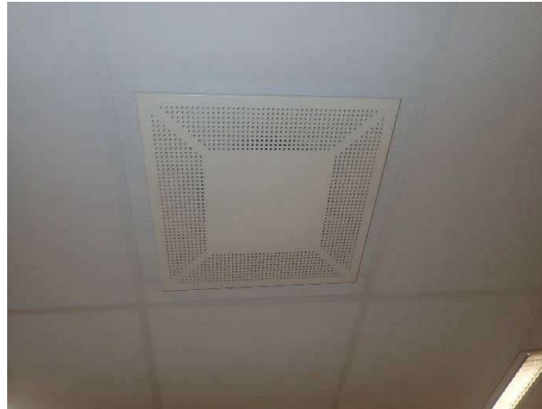
Kuva 43. Yleiskuva kattoasenteisesta äänenvaimennetulla tasauslaatikolla varustetusta tuloilmapäätelaitteesta.
