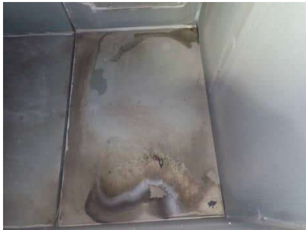
Kuva 29. Raitisilmakammiossa havaittiin kosteutta ja likaa, kammiossa ei havaittu viemäröintiä.
