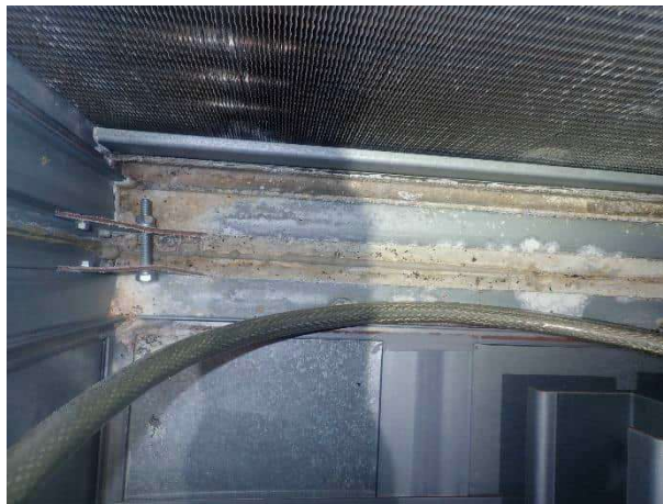
Kuva 15. Kumimursketta, likaa ja korroosiota tuloilmakoneen puhallinkammiossa.
