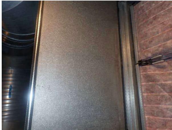
Kuva 24. Tuloilmakoneen suodatinkammion ovesta havaittiin suodatinkehikon ja suodattimien väliseen ohivirtaukseen viittaavia vuotojälkiä.
