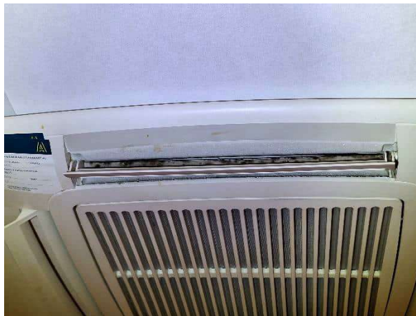
Kuva 49. Puhallinkonvektori on likaantunut, ja sisäilmatutkimuksessa siinä todettiin myös mikrobikasvustoa (ks. erillinen kuntotutkimusraportti).
