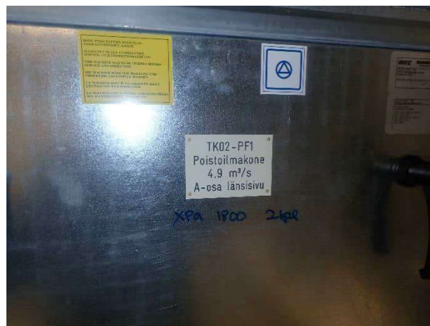
Kuva 10. Yleiskuva ilmanvaihtokoneesta TK02 PF1.
