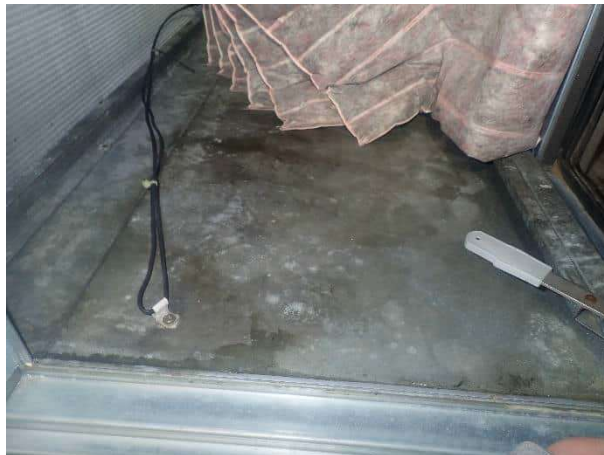
Kuva 5. Tuloilmakoneen suodatinkammiossa havaittiin kosteusjälkiä ja likaa.
