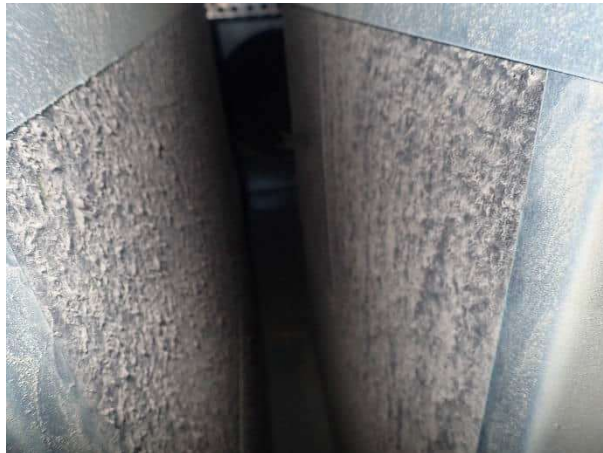
Kuva 28. Poistoilmakoneen äänenvaimennuslamellit ovat runsaan pölykerroksen peittämät.
