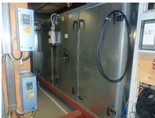
Kuva 3. Yleiskuva ilmanvaihtokoneesta TK01 PF1.
