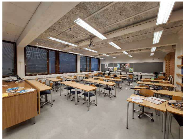
Kuva 44. Yleiskuva tuloilman suutinkanavasta.
