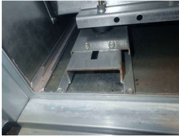
Kuva 18. Kumimursketta ja likaa tuloilmakoneen puhallinkammiossa.
