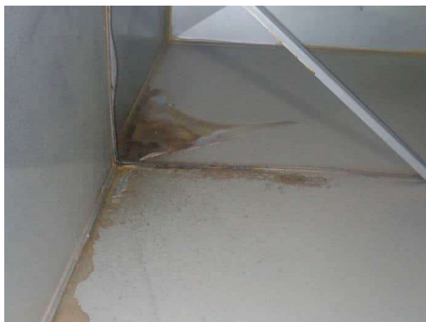
Kuva 7. Poistoilmakoneen imukammiossa havaittiin kosteusjälkiä ja likaa.
