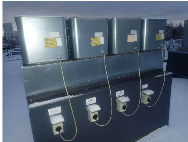
Kuva 37. Yleiskuva vesikatolla sijaitsevista huippuimureista.
