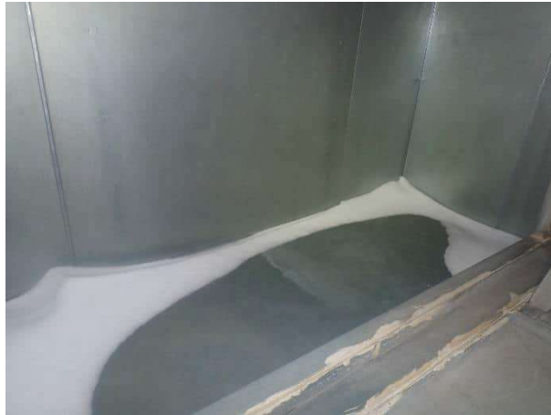
Kuva 11. Raitisilmakammiossa havaittiin lunta.
