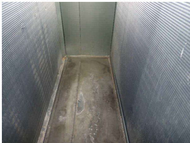
Kuva 13. LTO- ja lämmityspatterin välisessä kammiossa havaittiin kosteusjälkiä ja likaa.
