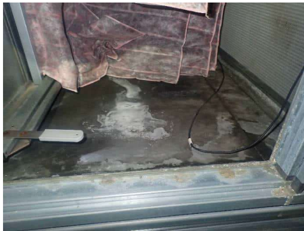
Kuva 12. Likaa, kosteutta ja kosteusjälkiä tuloilmakoneen suodatinkammiossa.
