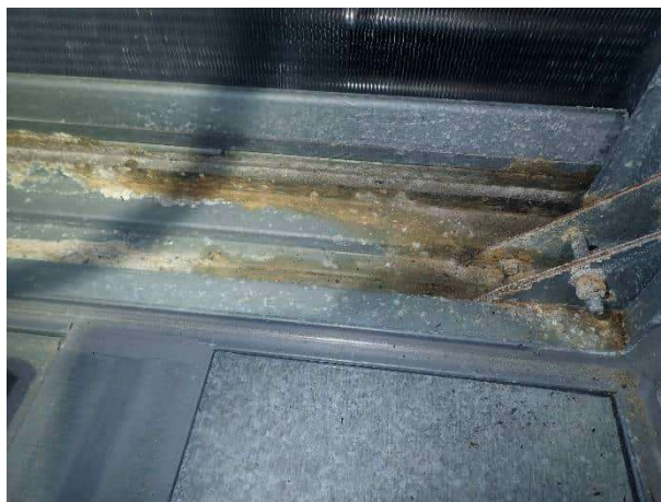
Kuva 6. Tuloilmakoneen puhallinkammiossa havaittiin kosteusjälkiä, korroosiovaurioita ja kumimursketta.
