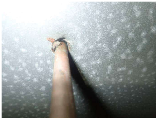
Kuva 16. Anturiläpivientejä ei ole tiivistetty ja niissä on suojaamatonta mineraalivillaa.
