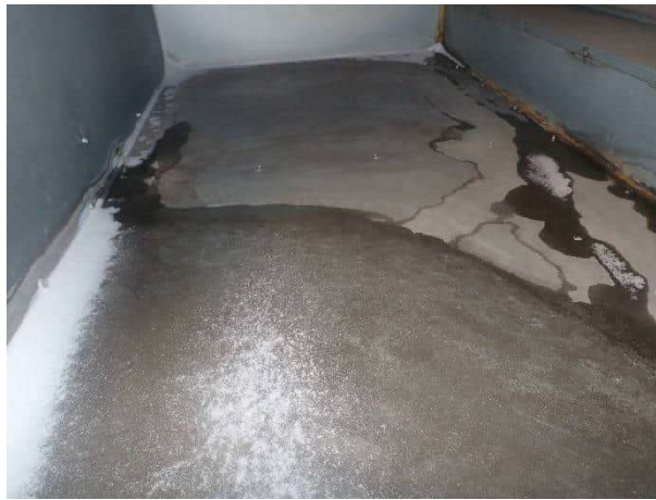
Kuva 32. Lunta ja kosteusjälkiä raitisilmakammiossa.
