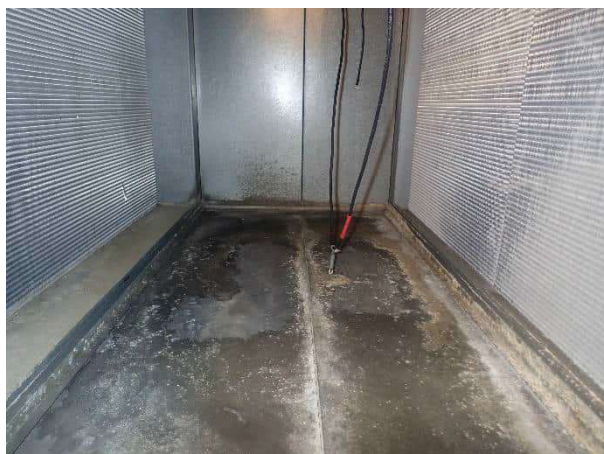
Kuva 26. Tuloilmakoneen LTO-patterin ja lämmityspatterin välisessä kammiossa havaittiin kosteusjälkiä, kosteutta ja likaa.
