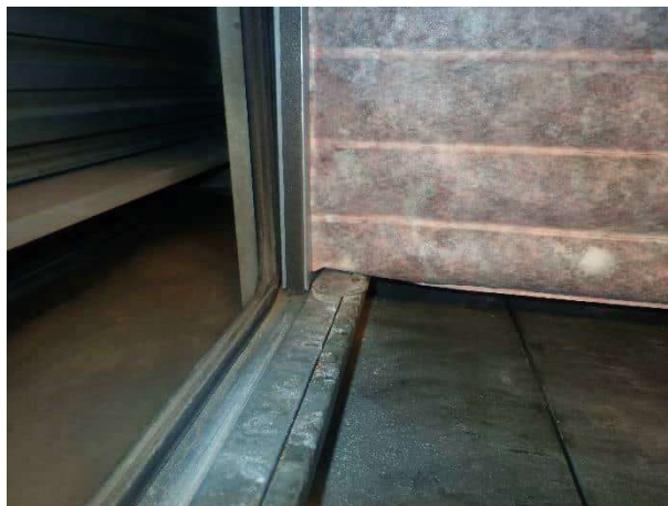
Kuva 23. Suodattimissa on välitiivisteet, minkä takia suodattimet eivät osu täysin suodatinkehikon tiivisteisiin, mikä heikentää suodatinkehikon ja suodattimien välistä tiiveyttä.
