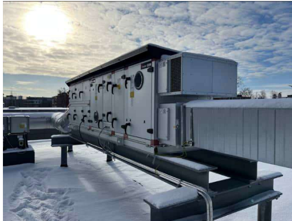
Kuva 35. Yleiskuva ilmanvaihtokoneesta G310TK01PK01.
