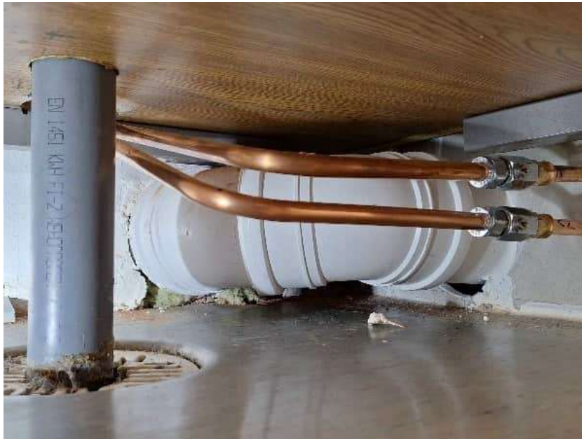
Kuva 127. Luokan 205 vesipisteen alapuolinen lattiakaivo, joka haisi viemärille, ja läpivienti viereiseen kuilutilaan, josta havaittiin ilmavirtaus sisätiloihin päin.
