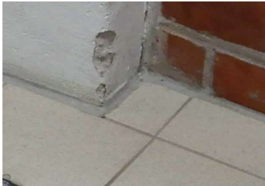
Kuva 67. Kellarin seinä-lattialiittymät on tiivistetty säännönmukaisesti joustavalla massalla. Tiivistys on todennäköisesti peruskorjauksen 2007 aikainen. Tiiveys on kohtalaisen hyvä. Kuvat kellarin käytävältä 048. Pilarin juuressa mekaaninen pinnoite vaurio.
