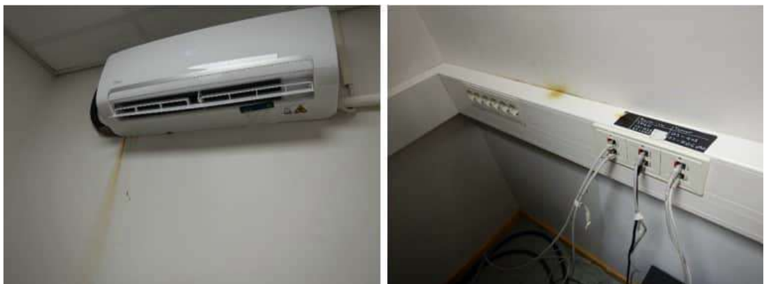
Kuva 126. Tilassa 233 havaittiin ilmalämpöpumpun vuotaneen seinäpinnalle.
