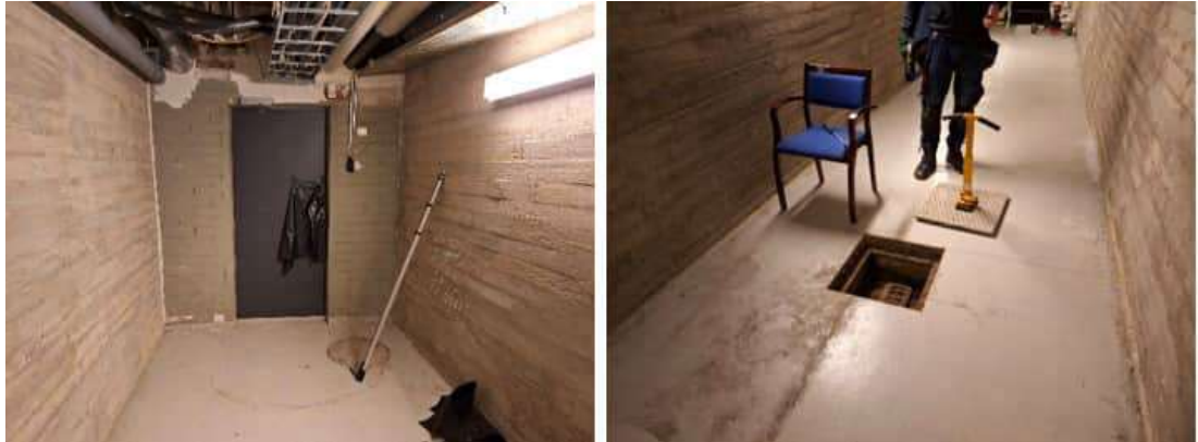
Kuva 44. Tunneli 016a. Havainnot kuten tunnelissa 016b. Tunnelien lattioissa on salaoja- ja viemärintarkastuskaivoja, joiden kannet eivät ole tiiviitä, ja joista kulkeutuu hajua ja maaperän epäpuhtauksia sisäilmaan. Tunnelien seinissä on myös avoimia läpivientejä ympäröivään maaperään.
