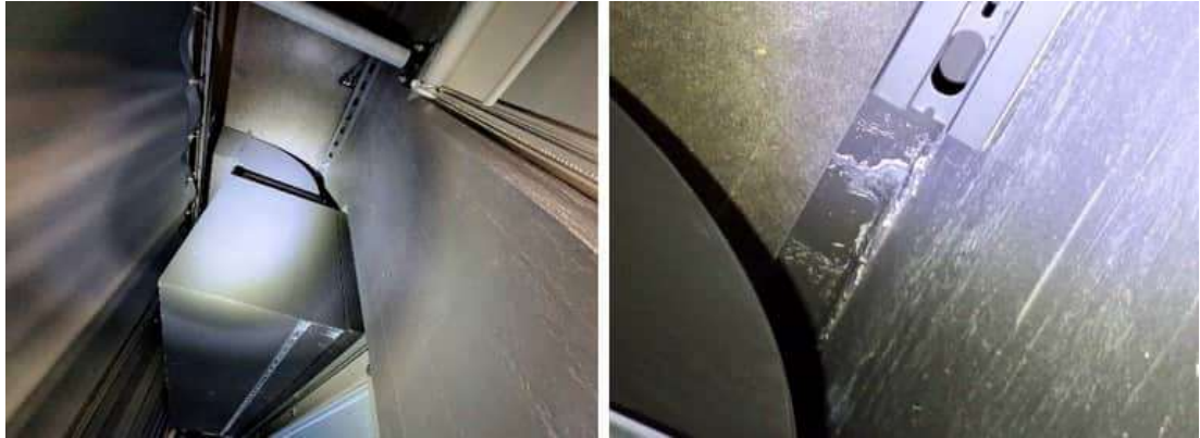
Kuva 116. Näkymä tilan 123 ulkoseinän vierellä kohti kattoa. Ulkoseinän keskiosalla kattopinnassa ja seinän yläosassa oli pieni kosteusjälki, jossa havaittiin kohonneita pintakosteusilmaisimen lukemia (80-100). Katossa on mineraalivillalevy, jonka yläpinnassa saattaa olla kosteuden aiheuttamaa vaurioitumista.
