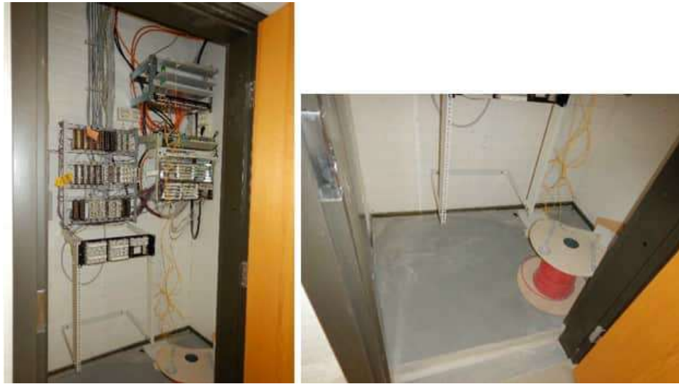
Kuva 57. Tilasta 010. Lattialla runsaasti hienoa kivimateriaalipölyä.
