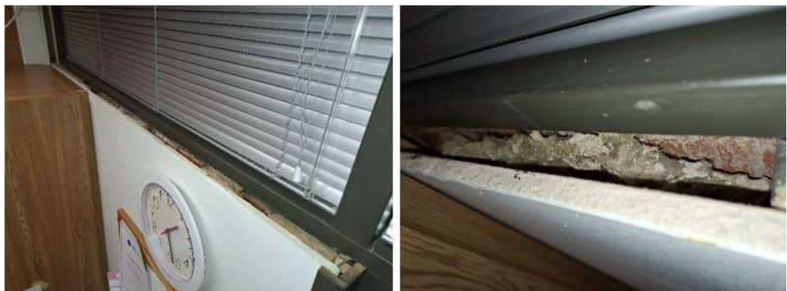
Kuva 101. Työtilan 103 väliseinän levytys on avoinna yläosastaan ja sen sisällä oleva mineraalivilla on avoinna ilmatilaan. Levytyksen takana havaittiin paljon pölyä.
