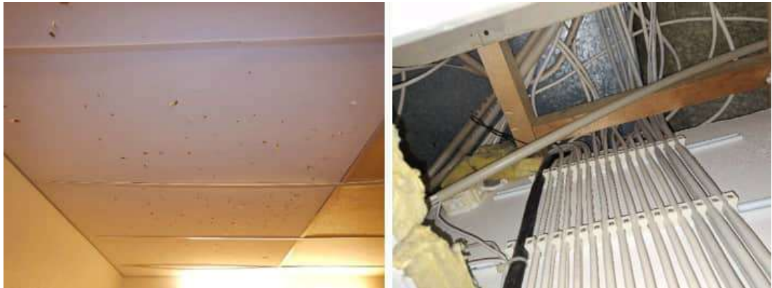
Kuva 51. Tiloista 022, 034a: rikottua mineraalivilla-akustolevyä musaluokassa ja avointa villapintaa sähkökaapissa.
