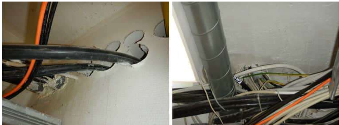
Kuva 87. Kellarin tilasta 008, läpivientejä perusmuurista ulos, sekä ylös välipohjaan tiivistämättä tai tiivistys puutteellinen.
