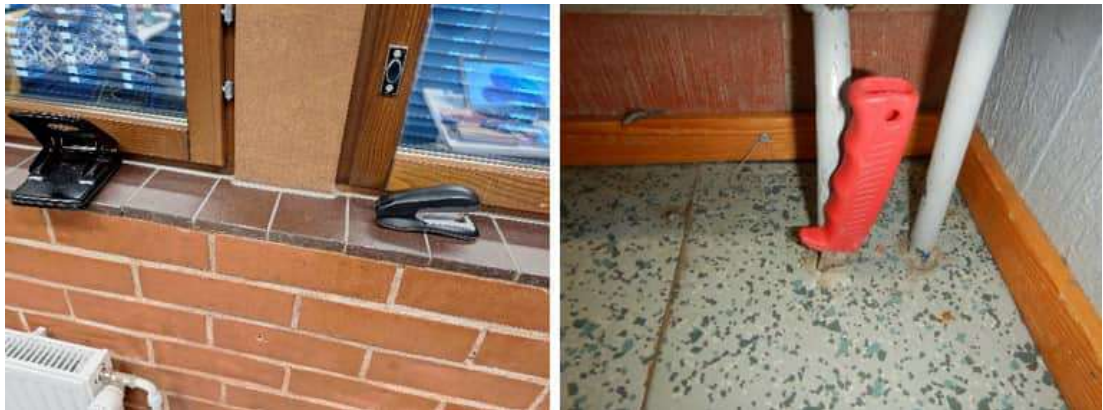
Kuva 100. Tilan 103 rakenneliittymien ja -läpivientien ilmatiiveys on kohtalaisella/heikolla tasolla. Rakenteita ei ole erikseen tiivistetty.
