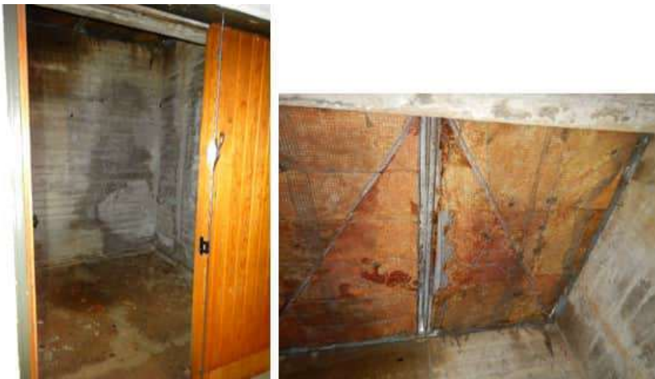
Kuva 35. Muuntamotilan 007 haalausmonttu. Haalausaukon kansi on peltirakenne, joka on eristetty alapuolelta mineraalivillalla. Eriste oli voimakkaasti kastunut ja erittäin vaurioituneen näköinen. Tila on ylipaineinen käytävälle 017 ja väliovi epätiivis.
