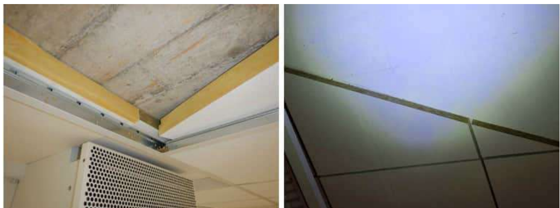
Kuva 131. Tilojen alakattojen levyjen reunoissa ja akustiikkalevyjen leikatuissa reunoissa on avointa villapintaa.
