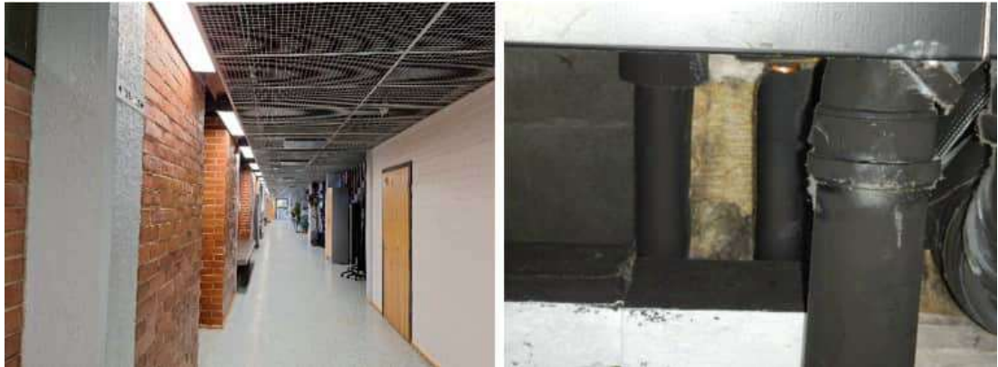
Kuva 102. Käytävällä tilojen 103-105 ulkopuolella on melko laajoja avoimia mineraalivillapintoja.
