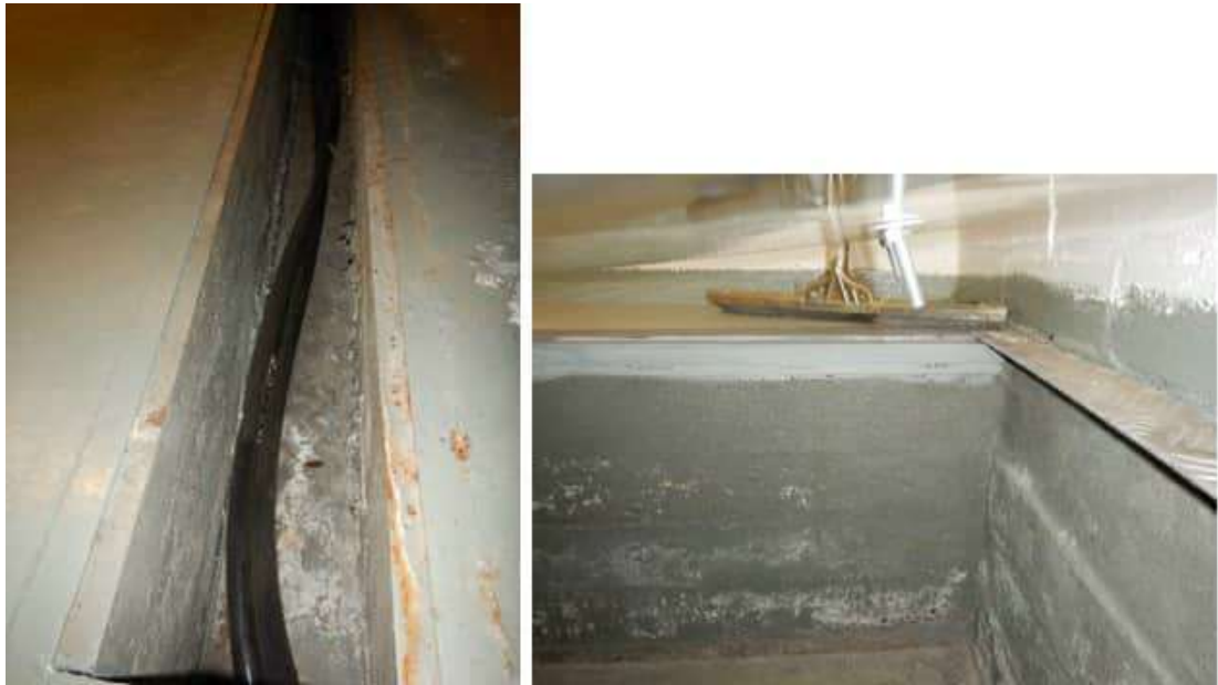
Kuva 34. Muuntamotila 007. Alapohjassa on kosteita putkikouruja, joissa oli voimakas maakellarimainen haju.
