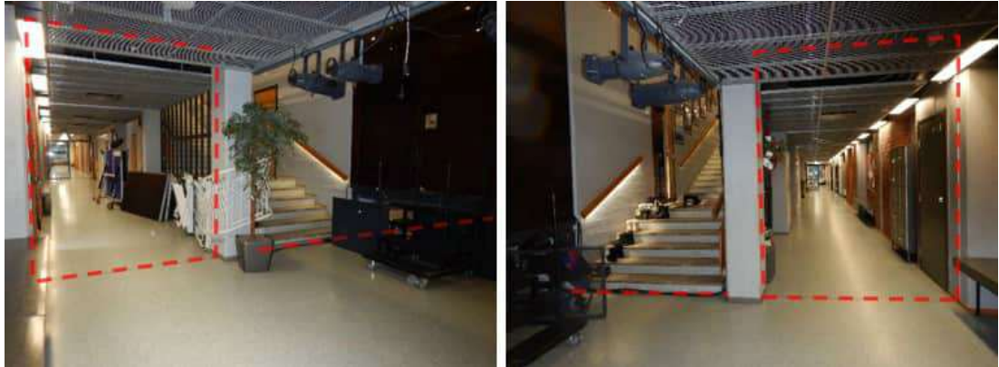
Kuva 112. Liikuntasauman sijainti auditorion viereisillä käytävillä. Sauma on merkitty kuviin punaisella katkoviivalla. Saumassa on erotuskaista, joka on voinut vaurioitua 1. ja 2. krs siivousvesistä.
