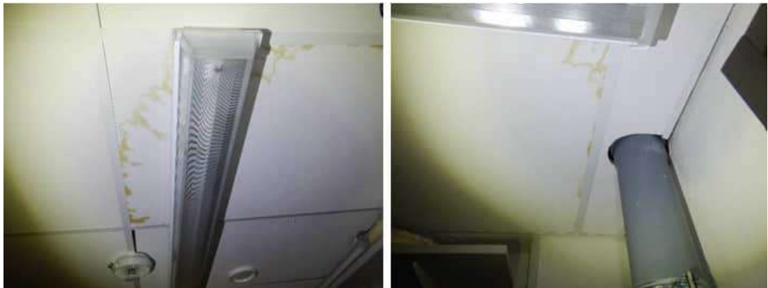
Kuva 55. Varastotilasta 032: alakaton vuotojälkiä viemäriputken lähellä.
