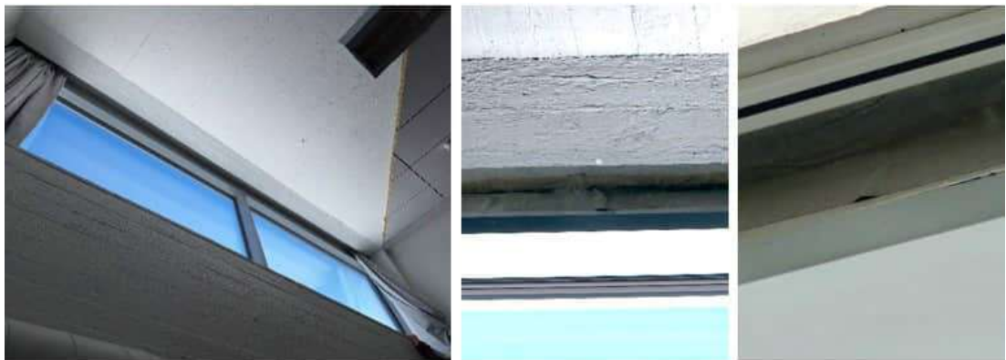
Kuva 133. Luokan 208 yläosassa on katonrajassa ikkunat, joiden liittymät on tiivistetty nauhalla. Tiivistyksissä on paljon poimuja ja ne ovat paikoittain selvästi epätiivitä.
