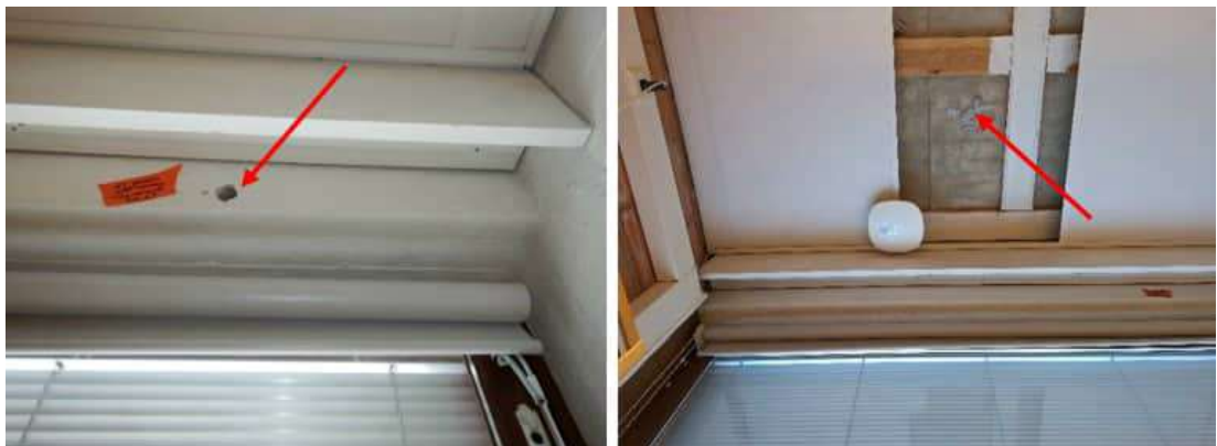
Kuva 129. Länsijulkisivun ulkoseinän rakenneavaus RA-23 (kuva vasemmalla) ja yläpohjan avaus RA-24 luokassa 205. Yläpohjan avauksessa ei havaittu kohonneita kosteuksia hetkellisessä mittauksessa.
