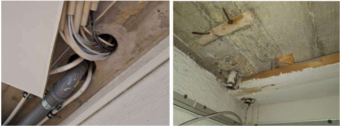
Kuva 94. Luokan 102 alakaton kosteusjäljen kohdalla on täysin avonainen läpivienti yläpuoliseen luokkatilaan (vasen kuva). Läpivientiin on sullottu mineraalivillaa. Ulkonurkassa vanhat katkaistut lämpöputket ovat tiivistämättä. Putkiläpivientien ympärillä näkyy myös pieniä vesivalumajälkiä. Välipohjan alapinnassa on muottilaudoituksen jäämiä.
