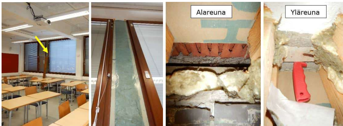
Kuva 98. Luokan 102 ikkunavälin avaus RA12a. Rakenteen ilmatiiveys on heikko; höyrynsulku ei liity tiivisti karmeihin. Toisen ikkunavälin avauksessa todettiin kosteusjälkiä tuulensuojakipsissä. Muutoin vauriojälkiä ei havaittu. Ikkunavälistä on ilmayhteys ulkoseinän yläosan eristetilaan (oikeanpuolimmainen kuva).
