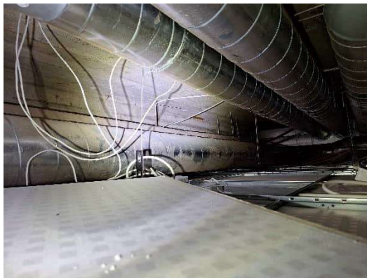
Kuva 139. Käytävien alakatoissa havaittiin paikoittain runsaasti pölyä.
