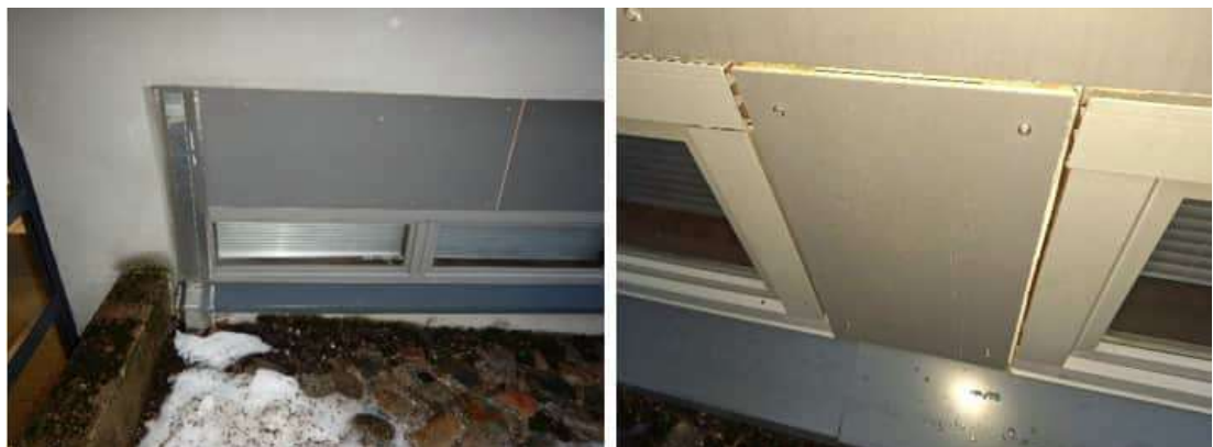
Kuva 17. Kellarin etelänurkkaa, sokkelin juuri on kostea, ikkuna lähellä maanpintaa, ikkunan levyrakenteiden liittymät epätiivti. Levyjen takana ei ole yhtenäistä tuulensuojakerrosta.
