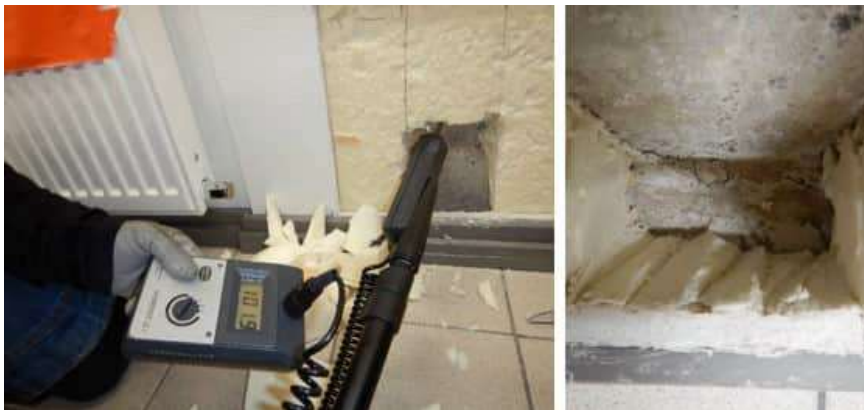
Kuva 61. Luokassa 052 pilarin kohdalla (RA-4) rakenne on muuten kuten 053:ssa, mutta betonin sisäpinnassa ei ole laastikerrosta. Rakenteessa todettiin selvä maakellarimainen haju. Rakenteen ilmatiiveys vastaa oletettavasti tilaa 053, eli on epätiivis.
