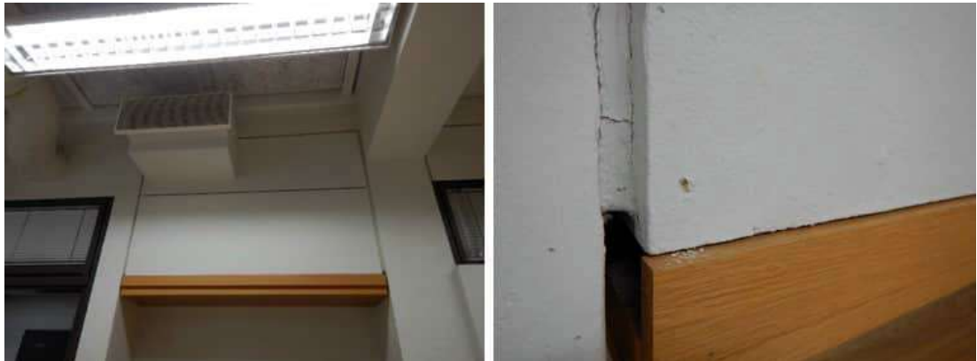
Kuva 95. Luokkien käytävän vastaisen väliseinän yläosa on levyrakenteinen. Alkuperäinen levy on lastulevyä. Luokassa 101 levyt on vaihdettu, luokassa 102 ei. Rakenteessa ei ole eristettä. Levyissä ei todettu valumajälkiä tmv. viitteitä kastumiseen. Kuvat luokasta 102.
