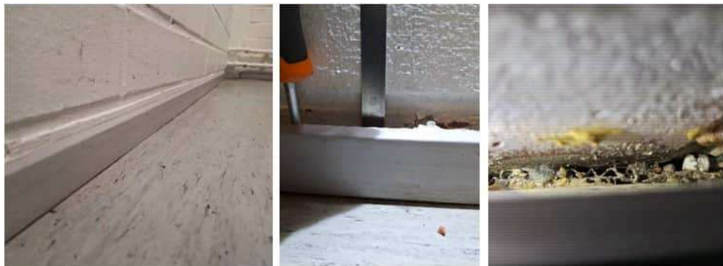
Kuva 99. Tilan VS-VP -liittymästä havaittiin ilmapuotoa (vasen kuva). Liittymä on epätiivis ja siihen upposi viivain noin 90 mm syvyyteen (keskimmäinen kuva). Liittymässä havaittiin aaltopahvi (oikea kuva).
