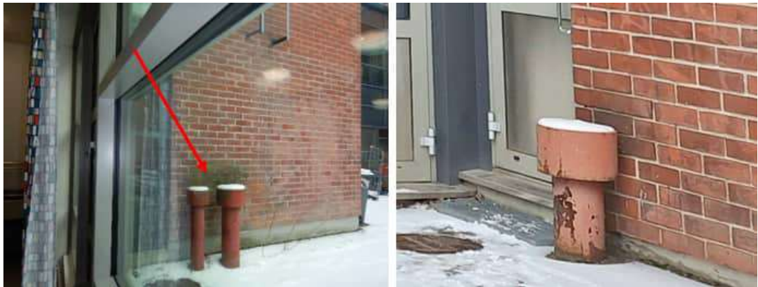
Kuva 14. Eteläpäädyssä julkisivutiili on kostea ja pinnassa on runsaahko leväkasvusto alustatilan tuuletuspaalujen kohdalla. Pohjoispäädyssä vastaavassa kohdassa tilanne on parempi (kuva oikealla).
