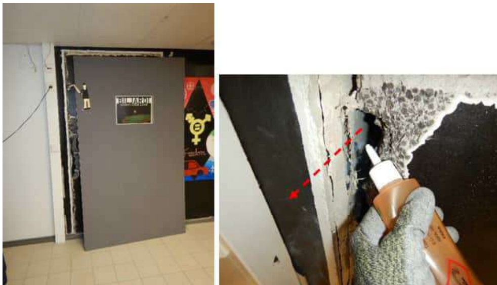
Kuva 43. Tunneli 016a. Kulkuaukko tunneliin 016a on ollut tilassa 030 (kuvassa vasemmalla). Aukko on ummistettu ja tiivistetty v. 2020 jälkeen, mutta tiivistävä rakenne on rikottu (ilkivaltaa). Ilmavirran suunta oli huonetilaan päin. Tilassa 030 aistittavissa oleva kellarimainen haju oli peräisin ko. rikkiäisestä liittymästä ja on selvästi merkittävin yksittäinen sisäilmanlaatua heikentävä tekijä ko. tilassa.
