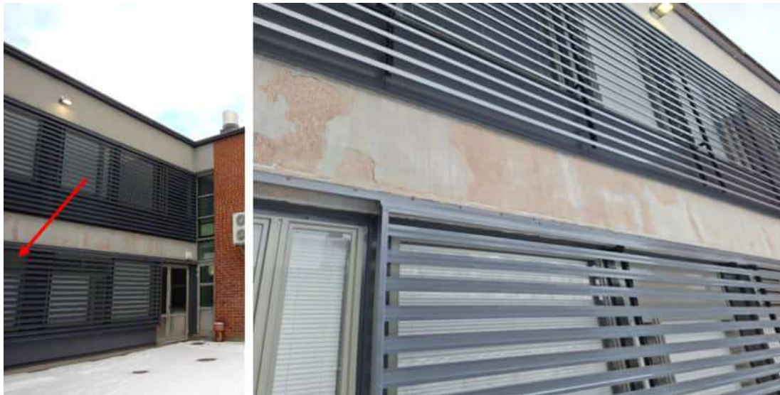
Kuva 117. Eteläjulkisivun betonirakenteisten osien (1. ja 2. kerroksen yläosat) pinnoitevauriot vaikuttavat vanhoilta eikä niitä ole näin ollen uusittu ikkunanauhojen uusimisen yhteydessä. Vasempaan kuvaan on merkitty nuolella suuntaa antavasti kohta, jossa sisäpuolella havaittiin kosteusjälki.
