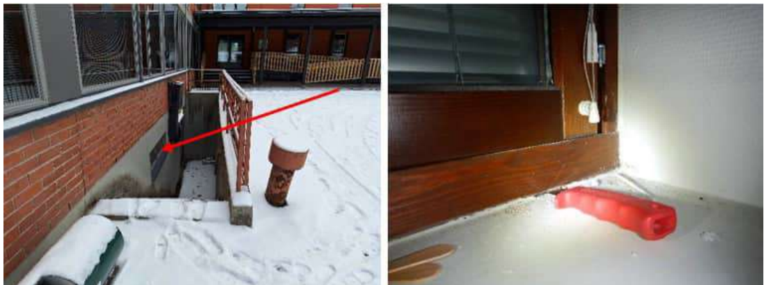
Kuva 78. Tilassa 030 olevan ikkunan liittymää ei ole tiivistetty. Ikkuna sijaitsee uuden IV-kopin sisällä. Vasemmalla ko. ikkunan sijainti ulkoa nähtynä. Ikkunan lähellä on myös kosteusrasitettu kohta julkisivussa portaan vierellä.
