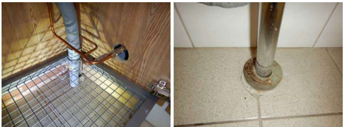
Kuva 79. Kellarin tilasta 054. Yksittäistä lavuaarin viemäriläpivientiä alapohjaan ei ole erikseen tiivistetty (kuva vasemmalla). Märkätiloissa ja
