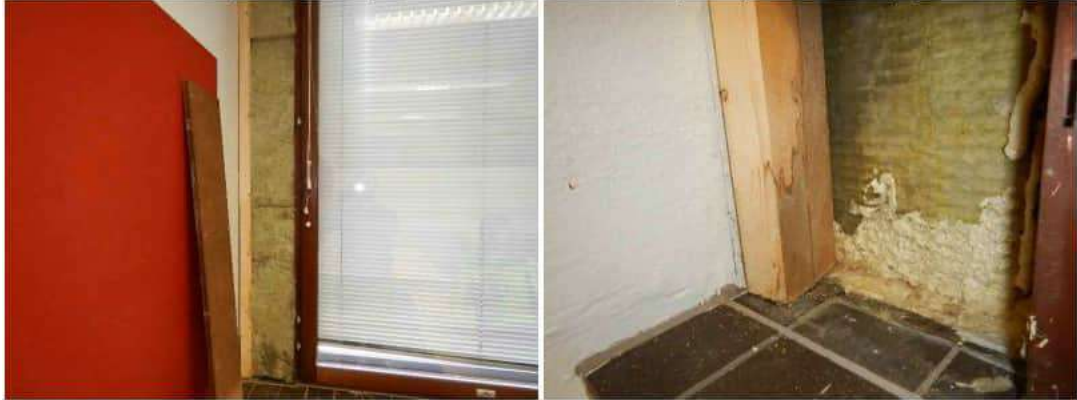
Kuva 136. Ikkunan levyrakenteeseen tehty rakenneavaus IK100. Materiaalit olivat aistinvaraisesti kosteusvaurioituneita.
