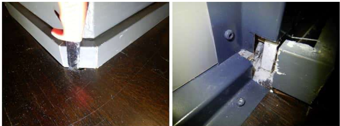
Kuva 115. Tila 123. Puukannen liittymiä ei ole tiivistetty koko tilan alueella, vasemmassa kuvassa liittymä pilarin kohdalta. Ulkoseinän liittymä puukanteen on tiivistetty nauhalla ja massalla levytyksen takana.
