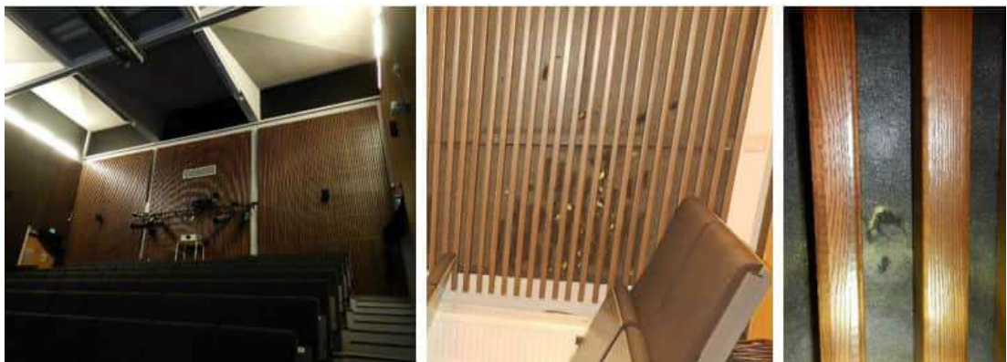
Kuva 109. Auditorion harvalaudoituksen takana on mineraalivillalevytyks, jonka kangaspinta on rikottu useassa paikassa. Levyjen reunat ovat lisäksi avoimia.
