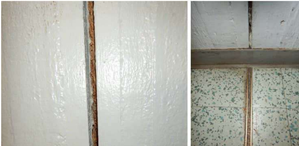
Kuva 122. Käytävillä liikuntasauman välissä on vanha lastulevy tmv (kuva vasemmalla). Lattiassa liikuntasauma on täynnä likaa ja yhdistyy pilarien väliseen liikuntasaumaan (kuva oikealla).
