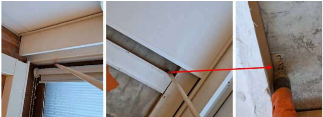
Kuva 130. Tilan US-ikkunaliittymässä havaittiin yksi vuotokohta (vasen kuva). Yläpohjan betonipinnassa on ilmeisesti rakenteen lävistäviä puukappaleita, joista havaittiin vähäistä ilmavuotoa (keskimmäinen ja vasen kuva).
