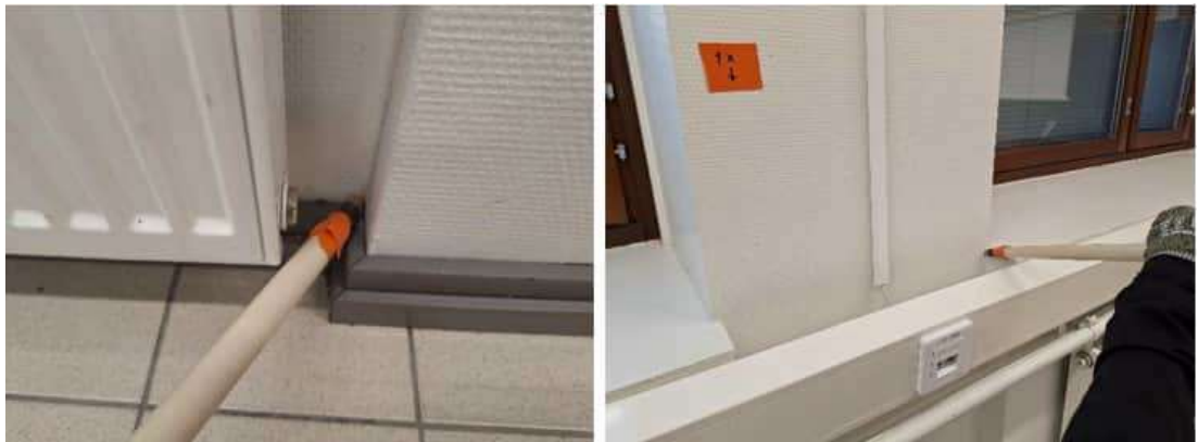
Kuva 88. Tilan AP-US -liittymästä havaittiin ilmavuotoa (vasen kuva). Ulkoseinän sisäpintaa on levytetty ja ilma pääsee liikkumaan levytyksen takana. Levytyksen liitoskohdista havaittiin ilmavuotoa myös ylemmää ikkunan alatasosta (oikea).
