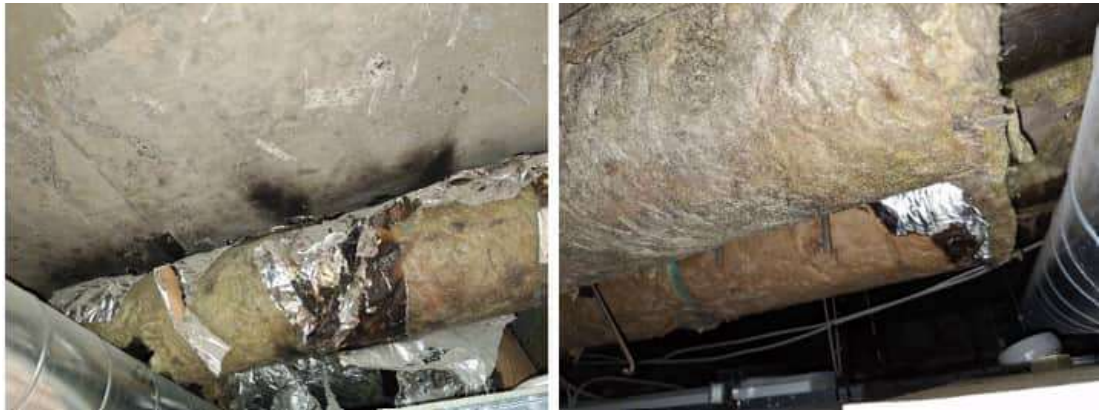
Kuva 54. Tilan 055 alakatosta, vaurioitunutta putkieristettä.
