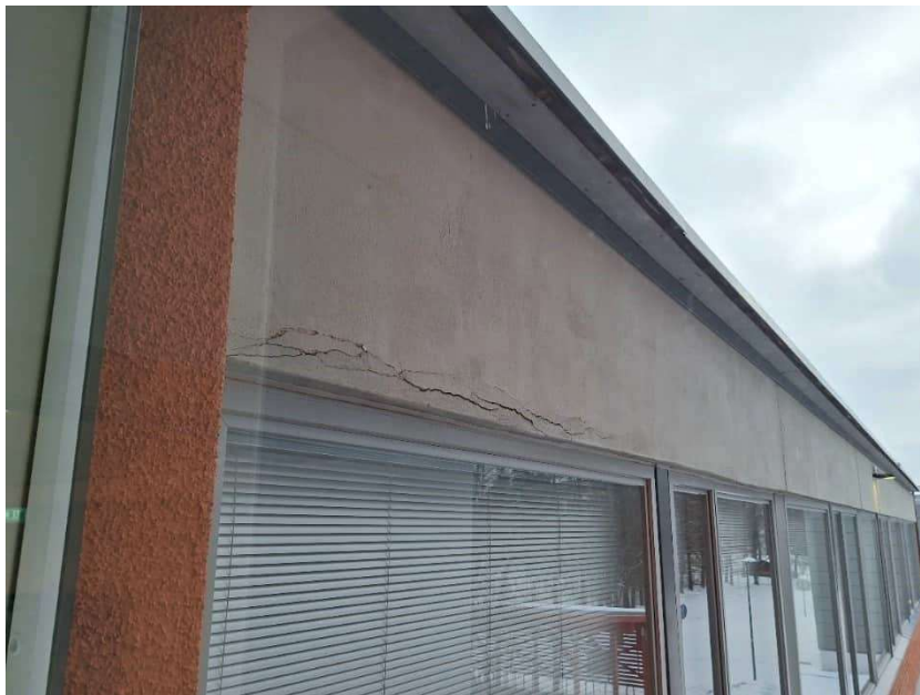
Kuva 128. Luokan 205 kohdalla ikkunan yläpuoleisessa betonipinnassa on iso halkeama. Vastaavia, mutta vähäisempiä halkeamia oli myös muualla. Halkeamien aiheuttaja ei selvinnyt.
