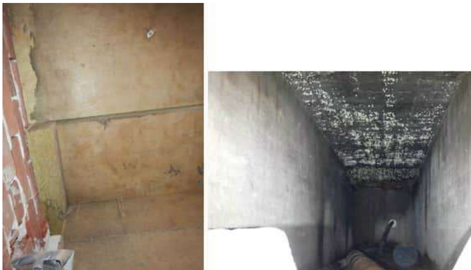
Kuva 38. Tilan 008 putkitunneli, jatkuu. Tunnelin "eteistilassa" luukun takana on vanhaa likaantunutta mineraalivillaeristettä ja levytystä katto- ja seinäpinnalla (vasen kuva). Tunnelin betonipinnat helmeilivät vettä helmikuussa 2025 (kuva oikealla).
