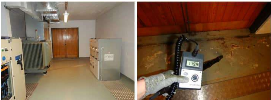
Kuva 33. Muuntamotila 007. Lattian pintakosteudet olivat koholla erityisesti haalausmontun oven edustalla.
