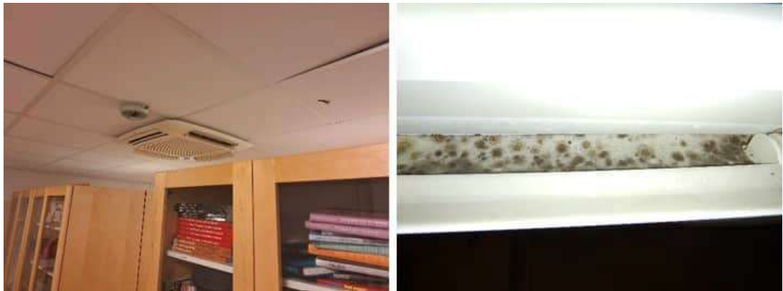
Kuva 52. Tilan 037 likainen ja homeinen puhallinkonvektori.
