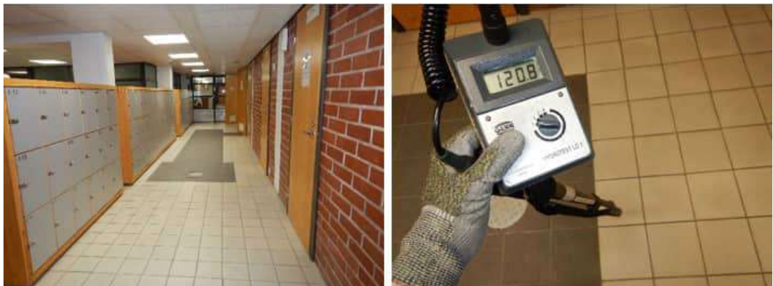
Kuva 28. Kellarin länsipuolen käytävän lattian pintakosteuslukemat olivat koholla.
