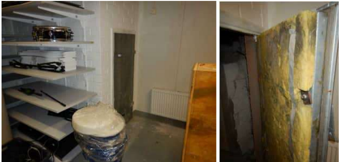
Kuva 37. Tilan 008 nurkasta lähtee putkitunneli rakennuksen ulkopuolelle. Luukku oli melko tiivis. Paine-ero oli käyttötiloihin päin. Luukun eristeenä on vanhaa likaantunutta mineraalivillaa.
