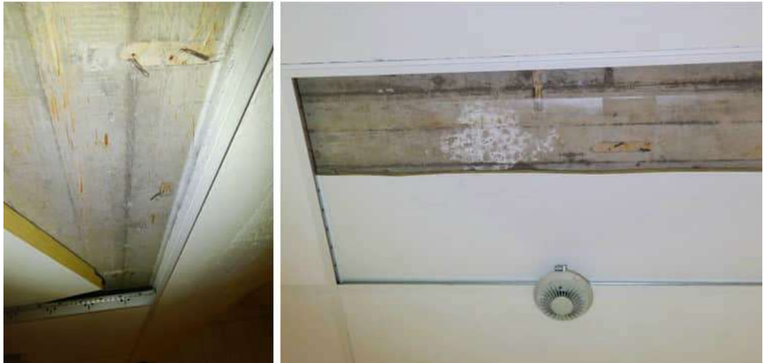
Kuva 132. Alakaton yläpuolella on jäämiä muottilaudoituksesta. Yhdessä kohdassa alakaton levyssä havaittiin vanha pieni kosteusjälki, jonka yläpuolella betonissa on härmää. Kohta oli pintakosteudenosoittimella tutkittuna kuiva.
