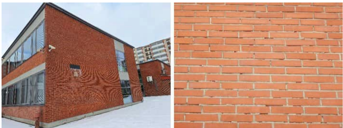
Kuva 15. Vielä peruskorjaamattomien päätyjen tiiliverhouksen muuraussaumot ovat rapautuneet. Rapautuminen on voimakkainta
