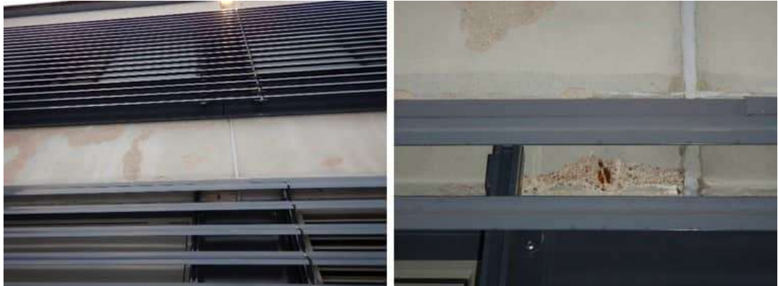
Kuva 118. Eteläjulkisivun betonirakenteisen osan kuntoa. Raudoitukset ovat paikoin esillä. Kuva kohdasta, jossa sisäpuolella oli kosteusjälki.
