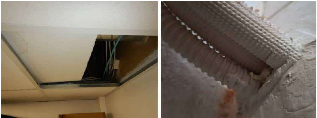
Kuva 125. Tilan 232 alakattolevyssä havaittiin vanha pieni kosteusjälki, jonka yläpuolella betonipinnassa on härmää (kuva vasemmalla). Kanslian 237 ilmalämpöpumpun läpivienti seinässä on aistinvaraisesti havainnoiden varsin tiiviin näköinen (kuva oikealla).
