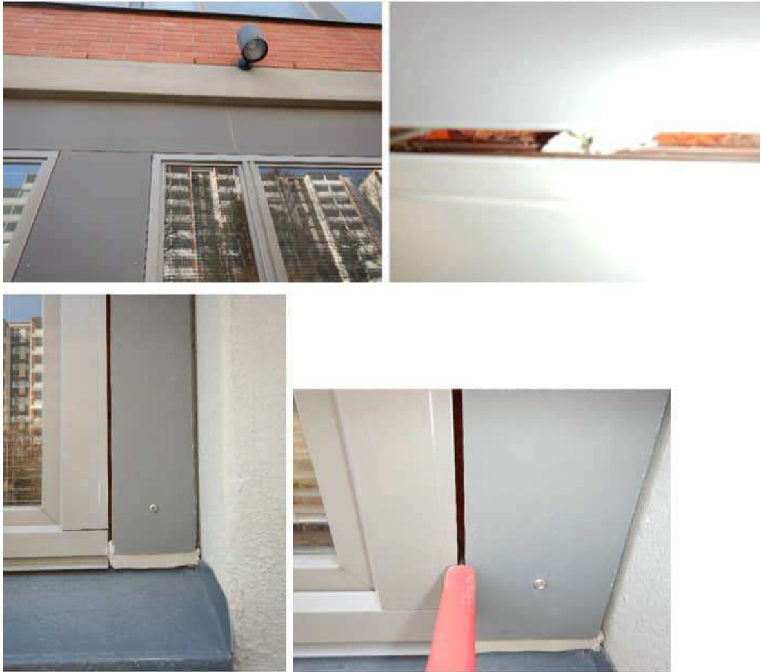
Kuva 18. Epätiivitä ikkunoiden levyrakenteiden liittymiä eri julkisivuilla. Rakenne on auki ikkunakarmin ja ulkoseinän liittymään. Puukon terä uppoaa kokonaan rakenteeseen. Vrt. seuraava kuva.
