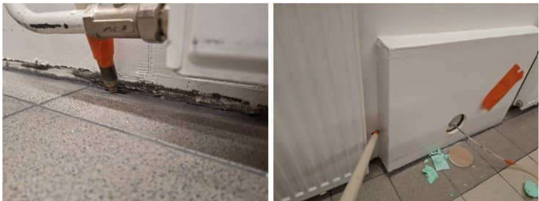
Kuva 89. Tilan AP-US -liittymää ei ole tiivistetty ja siitä havaittiin ilmavuotoa useassa kohdassa. Lisäksi vuotoa havaittiin sisäverhouslevytyksen liitoksista.
