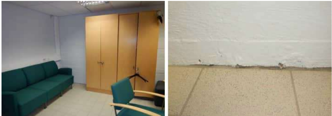
Kuva 27. Kellarin tila 047b, jossa kantavan betoniväliseinän alaosa on kostea ja maalipinta vaurioitunut. Vastavia vaurioita oli muutamissa tiloissa, mutta ne olivat kokonaisuudessaan pienialaisia. Tilan lattian pintakosteuslukemat olivat tavanomaisella tasolla.
