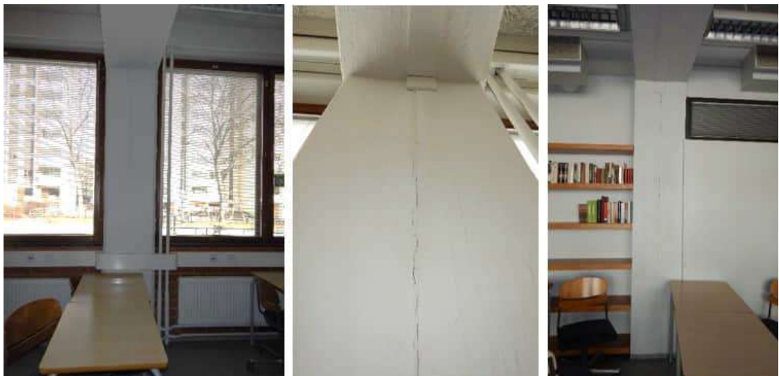
Kuva 108. Luokan 111 kohdalla olevan liikuntasäulan massa on haljennut ulko- ja väliseinäpinnassa.
