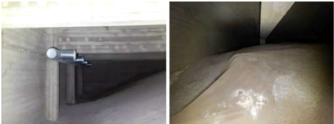
Kuva 49. B-osan alapuolista alustatilaa. Vasemmalla näkymä alustatilan takaosaan. Takaseinällä on poistoilmakanava. Päätelaitteilla ei ollut havaittavissa ainakaan selvää ilmavirtausta. Oikealla alustatilan keskiosaa. Sepelin päällä on osin muovikalvo.
