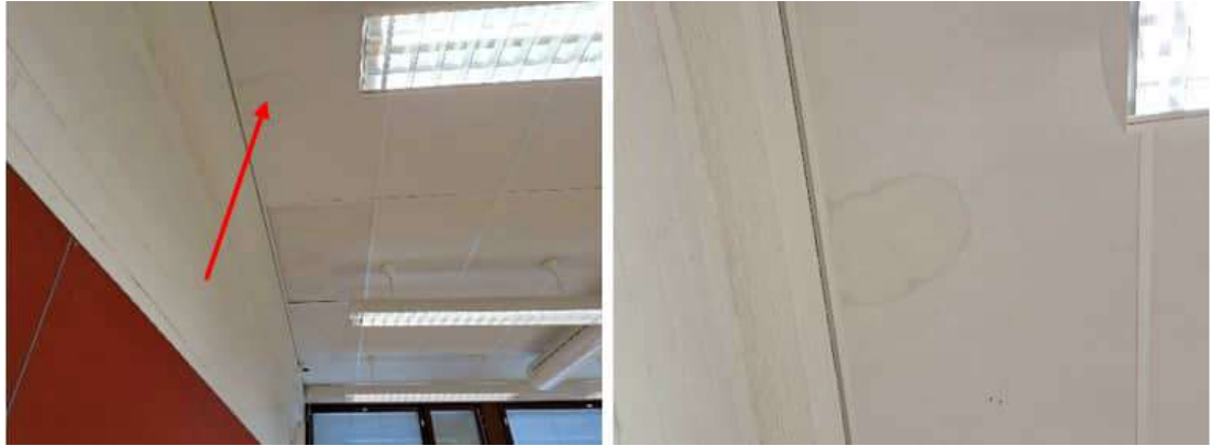
Kuva 93. Luokan 102 alakattolevyssä on pieni kosteusjälki.
