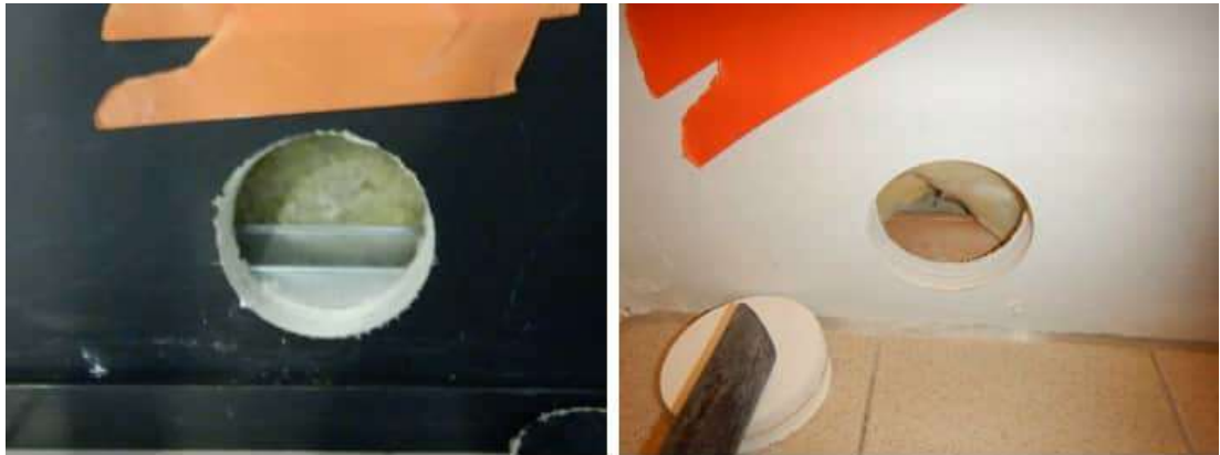
Kuva 66. Tiloissa 047b (vasen kuva) ja 022 (oikealla) on akustisista syistä eristetty väliseinä, joiden toisella puolella todettiin kivirakenteisen seinän alaosassa kohonneita pintakosteuslukemia. Avauksista RA-8 ja RA-9 otetuissa eristenäytteissä ei todettu viljelyanalyysillä mikrobikasvustoa. Avauksessa RA-9 tilassa 022 oli lievä kellarimainen haju.
