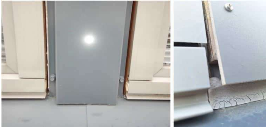
Kuva 121. Ikkunoiden väliset levytetyt osat ovat havaintojen perusteella epätiivit ulkopinnasta. Levyt ovat paikoin vääntyneet ulospäin alaosastaan.
