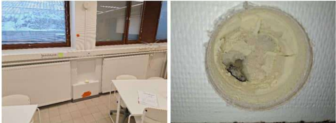
Kuva 60. Luokassa 053 pilarin kohdalla (RA-3) sisäverhouslevy on kuitusementtilevyä, takana polyuretaani (eri tuote kuin 055:ssä), laastikerros ja betoni. Rakenteessa todettiin selvä maakellarimainen haju. Rakenne on merkkiainekokeen perusteella epätiivis sisäilmaan päin.
