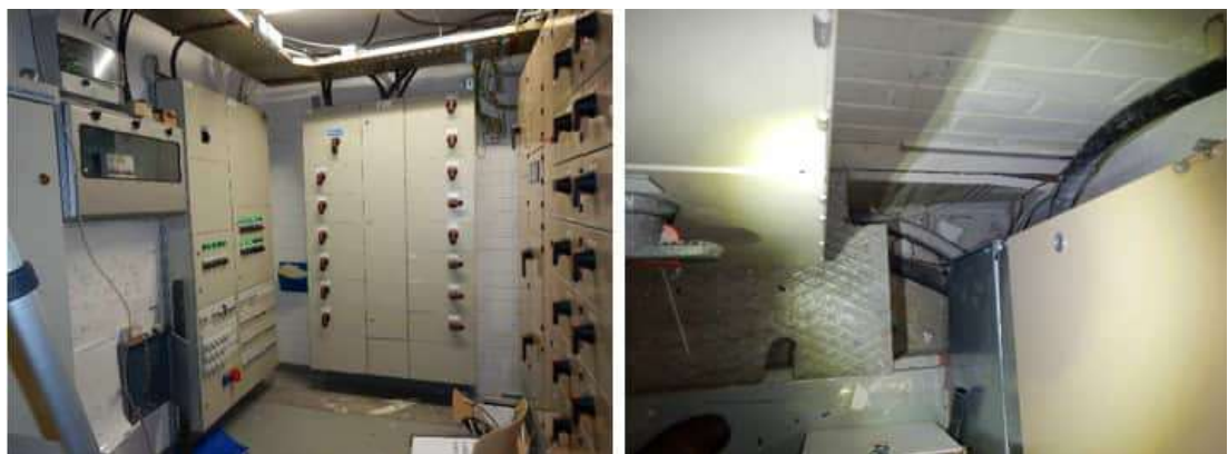
Kuva 56. Tilasta 011 sähkökeskus: pölyä ja roskaa lattialla ja lattian tekniikkakanaaleissa.
