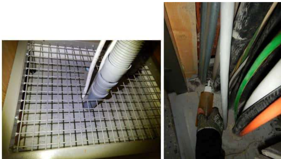
Kuva 96. Luokan 102 lavuaarin viemäriläpivienti lattiaan on tiivistämätön. Oikealla tiivistämättömiä läpivientejä sähkökaapissa luokan ulkopuolella.
