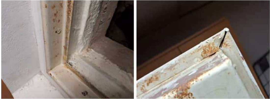
Kuva 46. B-osan alustatilan luukku on ruosteessa ja tiivistetön. Luukun kautta tulee hajua ja epäpuhtauksia varastotilaan ja edelleen muualle käyttötiloihin. Ilmavirran suunta oli tunnelista käytävälle päin ja käytävällä havaittiin todennäköisesti alustilasta peräisin olevaa maakellarimaista hajua myös ovien ollessa kiinni.
