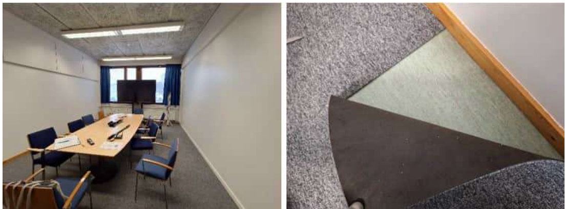
Kuva 137. Tilassa 252a on tekstiilimatto, jonka alapuolella havaittiin öljyinen haju. Muovimaton pohjassa ei havaittu poikkeavaa.
