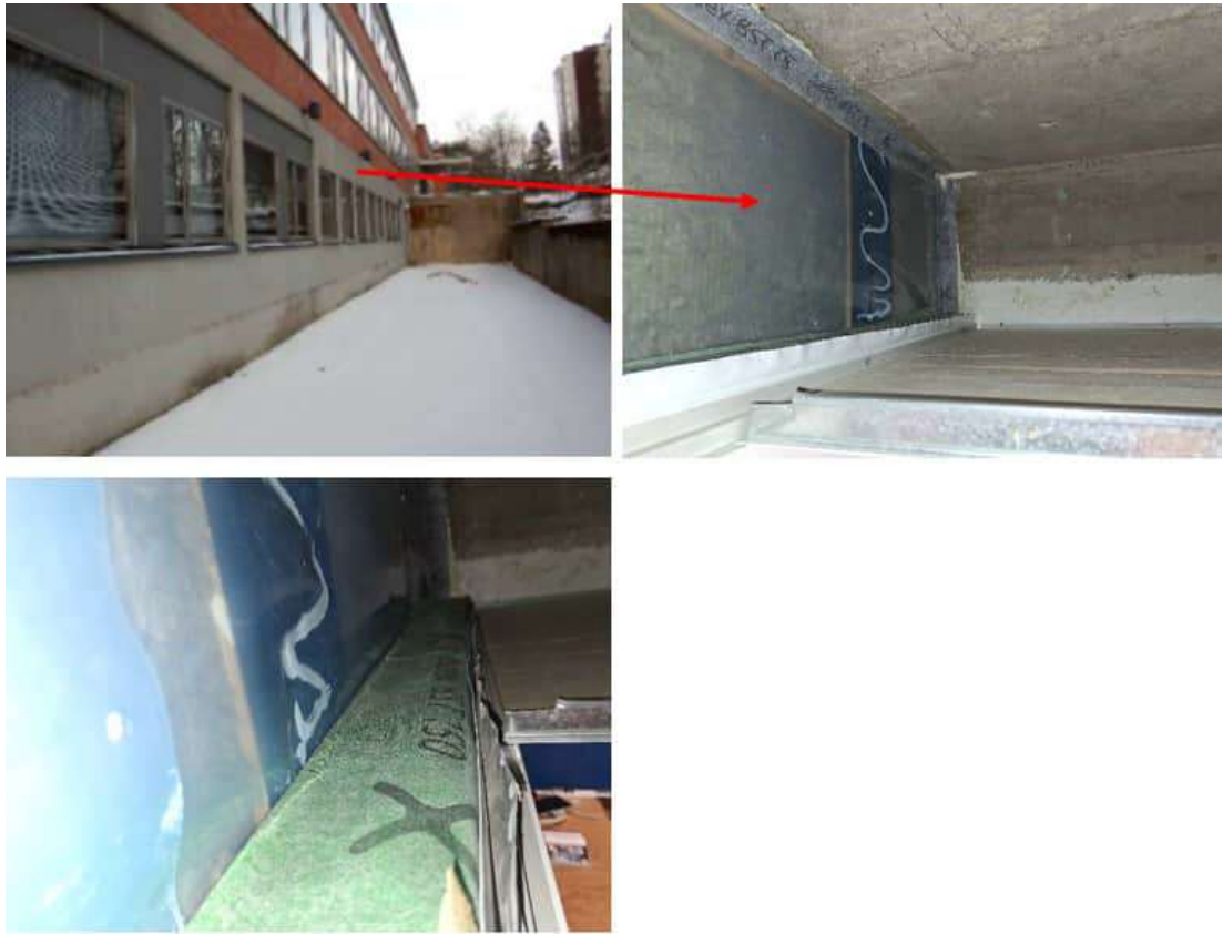
Kuva 84. Kellarin tilasta 054, ulkoseinän yläosan sisäpuolelta mineraalivillalla eristetty osa. Tällä alueella eristeen ulkopuolella on betonikuori. Tiivistys on toteutettu Codex-nauhalla ja se oli melko tiivis. Höyrynsulun limitykset on tiivistetty liimamassalla, toteutus ei ole tiivis. Rakennetta ei tutkittu tarkemmin rakenneavauksin.
