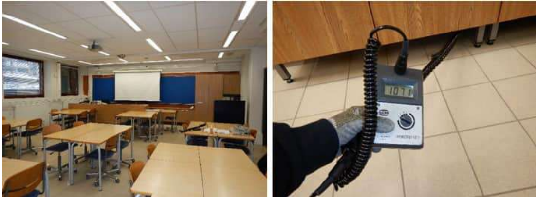
Kuva 32. Tilaa 052 lukuun ottamatta kellarin itäpuolen luokissa oli vain paikallisia kosteita kohtia, lähinnä pilarien ja viemäriläpivientien lähellä. Kuvissa luokka 054, jossa pintakosteuspoikkeamaa luokan etuosan lavuaarikaapin alla.
