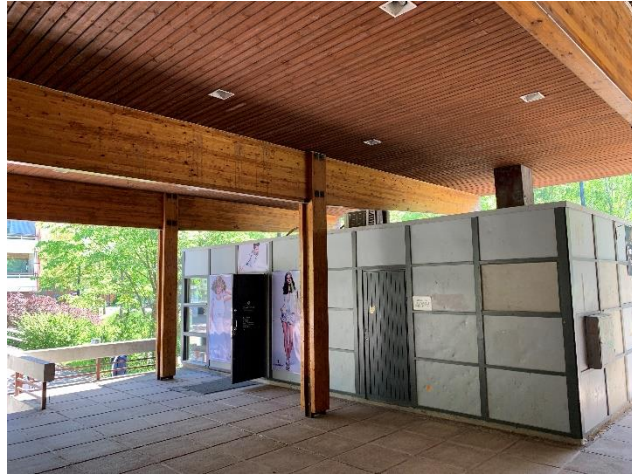
Pienempi kioskeista, jossa näkyvissä toinen myöhemmin uusittu ovi sekä korjattavissa/uusittavissa olevat julkisivurakenteet.
