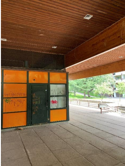
Isomman kioskin teräsrakenteinen ja kunnostettavissa oleva teräsovi sekä korjattavissa/uusittavissa olevat julkisivun julkisivurakenteet
