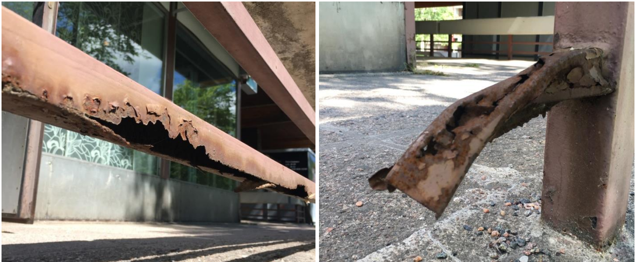
Kaiteet huonossa kunnossa
