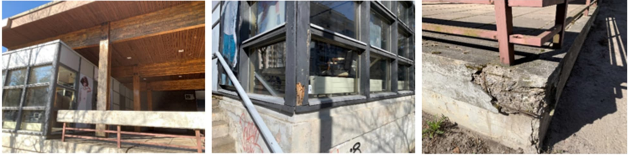
Vaurioita ostoskeskuksen rakenteissa: lahoa, taipumaa, ruostetta ja rapautumista.
