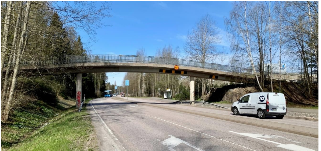
Rajatorpantien betonisilta on heikkokuntoinen, matala ja jyrkkä.
