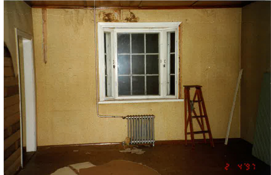
Olohuoneen ikkuna eteläseinältä. Ikkunat oli suojattu ulkoapäin levyin ilkeivallalta. Kuva 04/1997 EV
