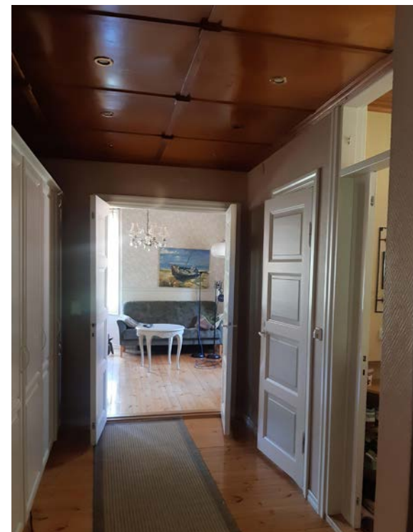
Aulassa sisäkatto on laskettu koneellisen ilmanvaihdon kanavien vuoksi. Kattoon on upotettu spot-valaisimet. 08/2024 AK
