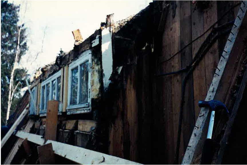
Vesikaton rakenteet olivat kosteusvaurioituneet kattolyhyn alueelta Kuva 05/1997 EV
