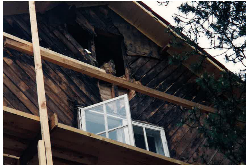
Ulkoseinän kosteusvaurio länsipäädyssä. 06/1997 EV
