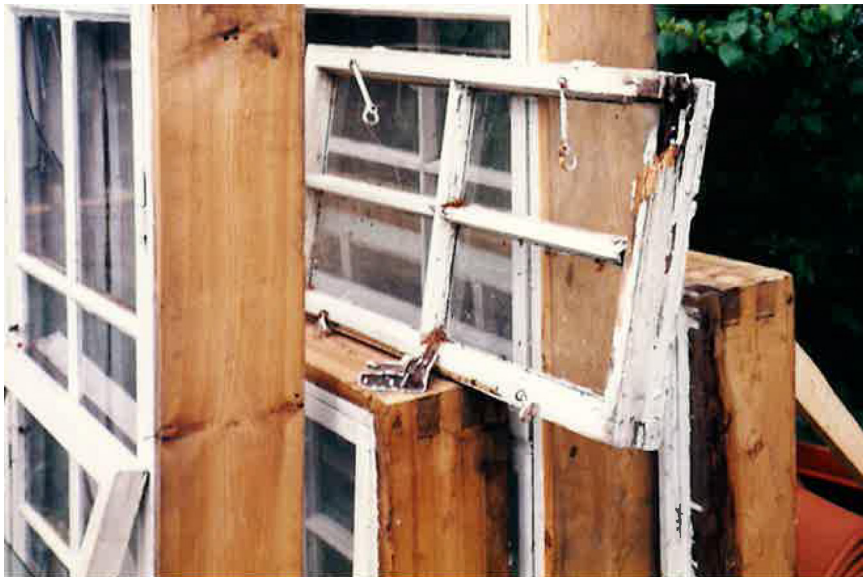
Kaikki ikkunat uusittiin. Ikkunoissa oli lahovaurioita. 07/1997 EV
