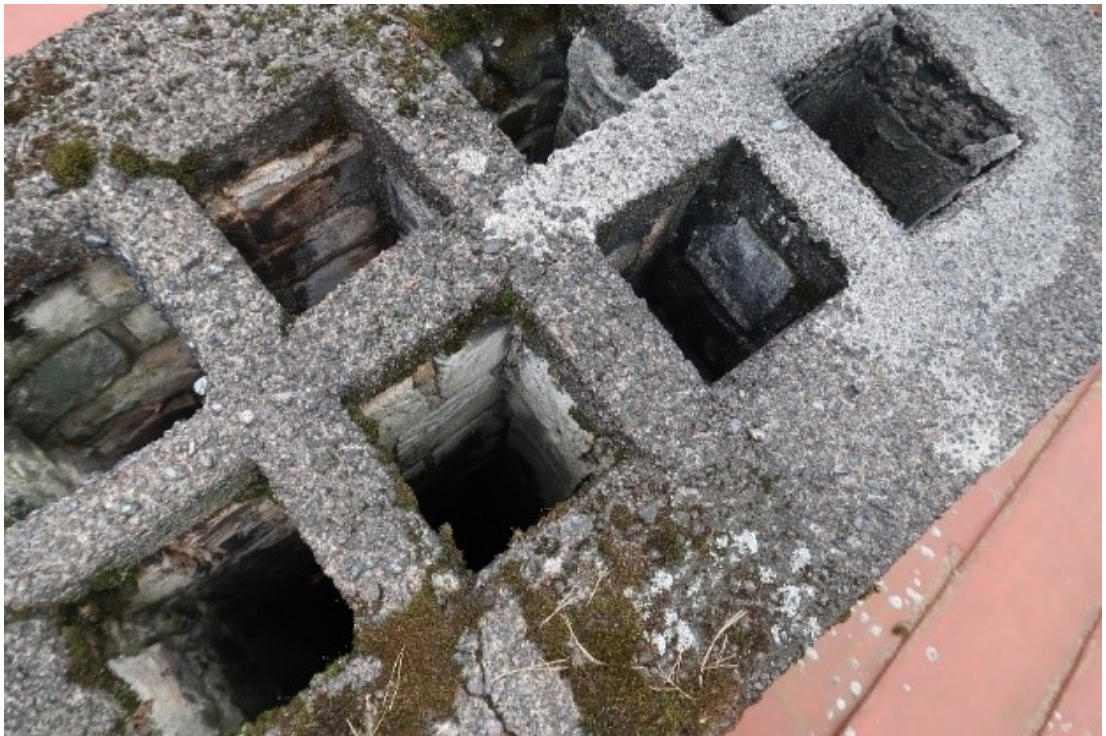
Kuva 94. Piipun hormien avoimet päät ja rapautunutta betonivalua.
