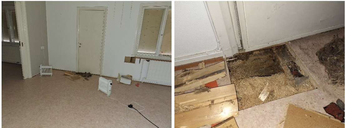
Kuva 85. Avauksen täyttö oli tummentunutta ja avauksesta havaittiin mikrobiperäinen haju. Avauksen kohdalla ulkopuolella on parveke, jonka kantavat rakenteet on liitetty ulkoseinään ja välipohjaan.
