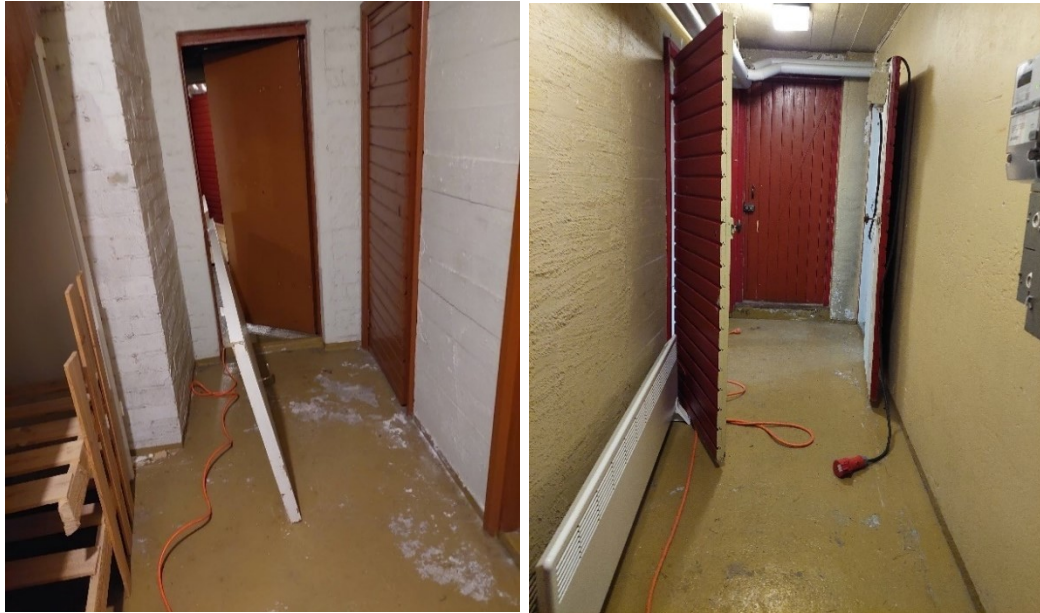
Kuva 63. Kellarin vanhan alapohjan pinnassa on tiivis maalikerros, joka on paikon kulunut. Kuvat kellarin käytäviltä.
