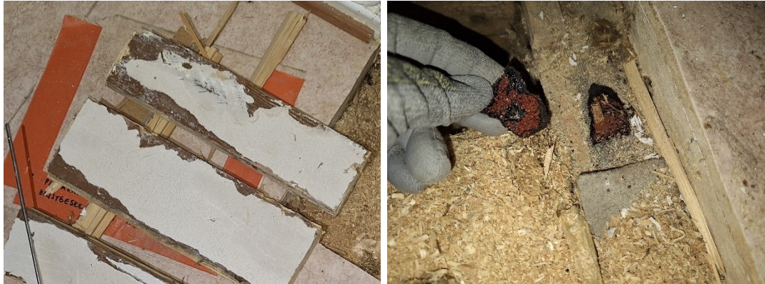
Kuva 100. Välipohjan ponttilaudoituksen pinnassa oleva valkoinen tasoite (HA1) ei sisällä asbestia. Välipohjan sisällä oleva parvekkeen teräspalkin ympärillä oleva kermi ei sisällä asbestia eikä vaarallisen jätteen raja-arvon ylittävää summapitoisuutta PAH(16)-yhdisteitä.
