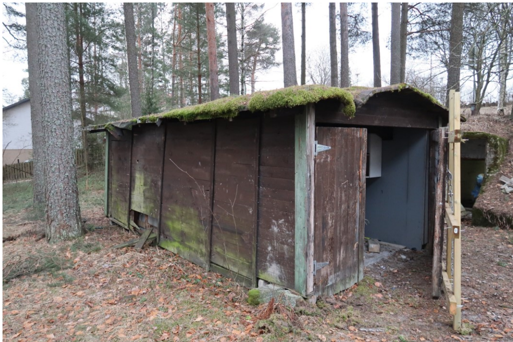
Kuva 42. Autotalli, joka on hyvin huonokuntoinen.
