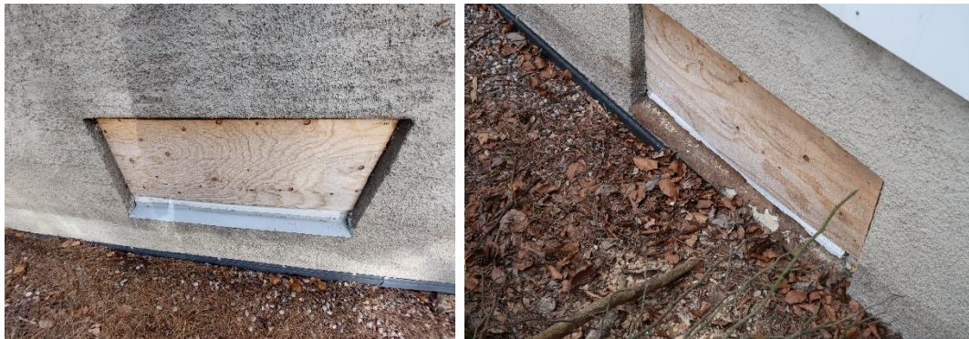
Kuva 79. Kellarin ikkunoiden pellitykset ovat niukkoja ja yhden ikkunan pelti on ruostunut harsoksi.
