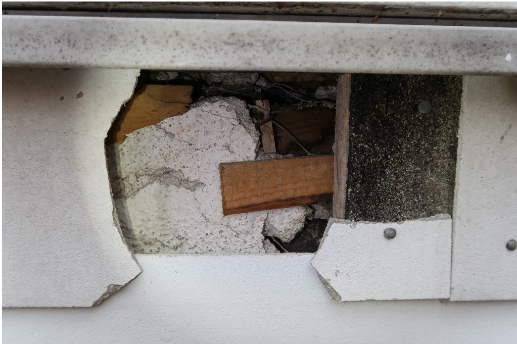
Kuva 52. Rikkinäisten mineriittilevyjen takaa näkyy alkuperäistä, kanaverkon varaan tehtyä rappaista.
