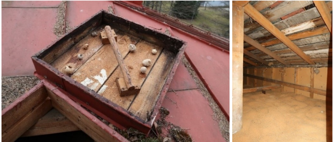
Kuva 91. Kattoluukun puuosissa havaittiin lahoa ja luukun alapinnassa ampiaispesiä. Yleiskuva yläpohjatilasta. Oikealla kuvassa sahanpurun pinnassa näkyy jälkiä pellin alapinnasta tiputelleesta kondensoituneesta kosteudesta. Yhden kattopellin alapinta on maalattu punaiseksi.
