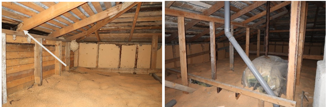
Kuva 92. Itäraystäällä puuosat ovat paikallisesti tummentuneet (nuoli). Idän puoleinen yläpohjatililan seinä on laudoitettu, kun muissa on sisäpintana huokoinen kuitulevy. Oikealla kuvassa keskellä yläpohjatilaa on muovilla päällystetty ja eristetty paisuntasäiliö (tieto raportista Raksystems Oy 16.2.207).
