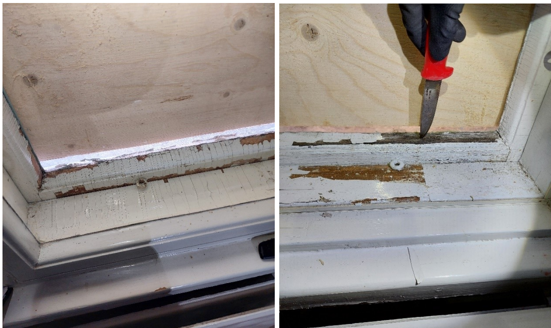
Kuva 81. Ikkunoiden maalipinnat hilseilivät. Yhdessä toisen kerroksen ikkunanpuitteessa oli alkavaa lahoa.
