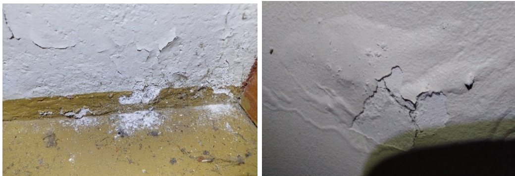
Kuva 64. Maalipinnan hilseilyä maanvastaisten seinien alaosaan portaan vieressä ja vanhassa kuivaushuoneessa.
