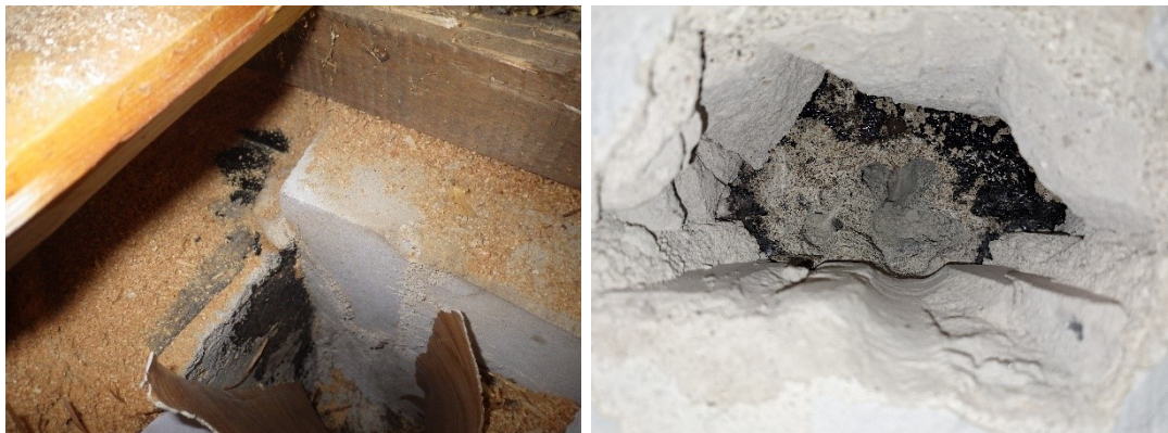
Kuva 101. Välipohjassa oleva musta sively / kermi (HA3) sisältää antofylliittiasbestia ja vaarallisen jätteen suositellun raja-arvon ylittävän summapitoisuuden PAH(16)-yhdisteitä (vasen kuva). Samaa sivelyä on todennäköisesti käytetty kellarin kuorimuurauksen takana (oikea kuva).
