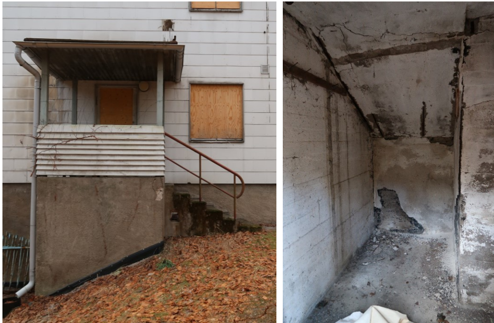
Kuva 60. Pohjoisjulkisivun betoniporras, tasanne ja varasto tasanteen alla. Varastossa näkyy, miten portaan alapinnassa teräkset ovat paikoin ruostuneet ja betonirakenne halkeillut.
