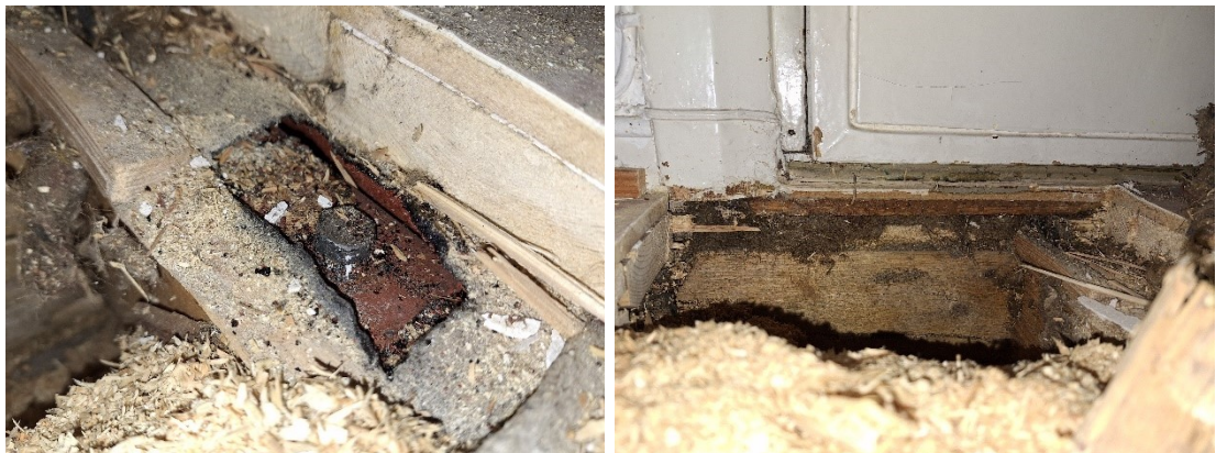
Kuva 86. Parvekkeen kantava teräspalkki on yhdistetty välipohjan puupalkkiin pultilla. Teräspalkin ympärillä on bitumikermi (punainen sirotepinta). Palkin ympäriltä havaittiin selvä ilmavirtaus rakenteesta sisätiloihin päin palkin ulkoseinäliittymän ympäriltä. Parvekkeen kynnyksen alapuolella ja välipohjaeristeen pinnalla kynnyksen vierellä oli lumppurivettä.
