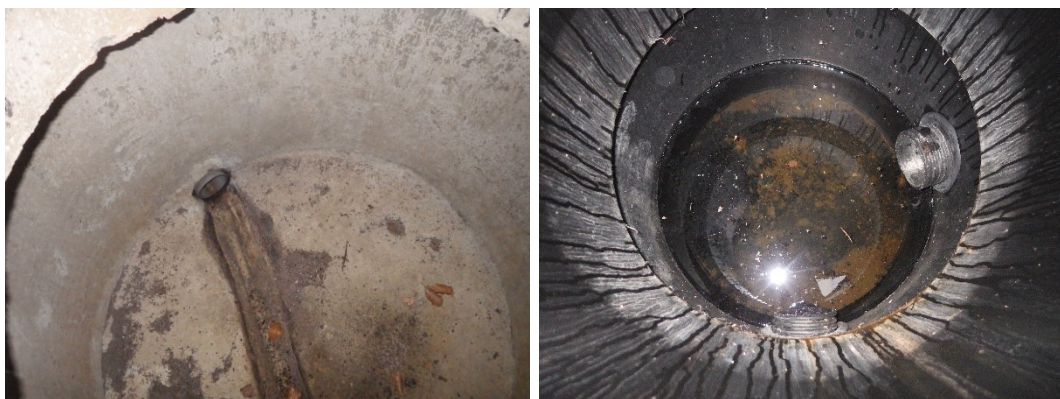
Kuva 61. Vasemmalla todennäköisesti vanha likavesikaivo. Oikealla salaojakaivo pohjoisjulkisivulla.
