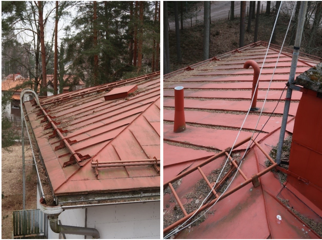
Kuva 95. Tummentumat räystääsalueen puurakenteissa ovat suunnilleen tikapuiden kohdalla. Räystääkouru ja syöksytorven suppilo ovat täynnä neulasia ja lehtiä. Läpiviennit ovat tiiviitä, mutta katolla on paljon neulasia ja lehtiä.
