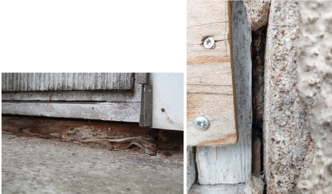
Kuva 80. Vasemmalla länsijulkisivun ulko-oven kynnyksen alla on betoniporrasta vasten oleva puu lahonnut. Oikealla saunan pesuhuoneen ikkunankarmin ja seinärakenteen välissä on huokoinen kuitulevy.
