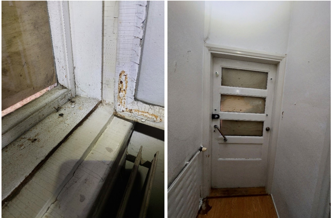
Kuva 82. Ikkunoiden sisäpuitteiden kulmaraudoissa oli ruostetta. Pohjoisjulkisivun oven laseista yksi oli rikottu ja ovi oli levytetty ulkopuolelta.
