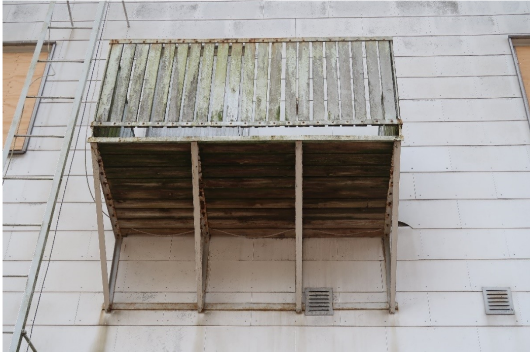
Kuva 72. Parvekkeen teräsosat ovat ruostuneet ja puuosissa kasvaa levää.
