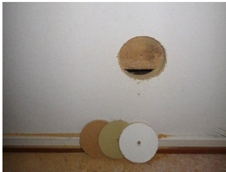
Kuva 77. Avauksesta ei havaittu poikkeavaa hajua ja selvä ilmavirtaus rakenteesta sisätiloihin päin.
