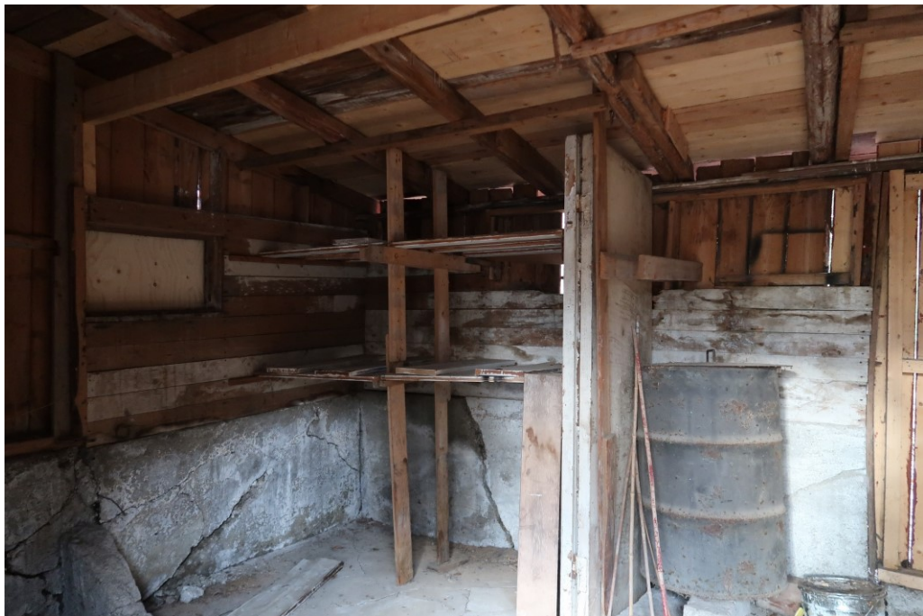
Kuva 40. Liiterin länsipäädyssä on huonokuntoinen, betonirakenteinen eläinsuoja.
