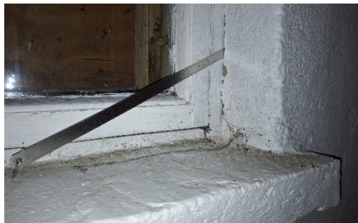
Kuva 65. Maanvastaisen seinän kuorimuurauksen ikkunaliittymäkohdassa on rako.
