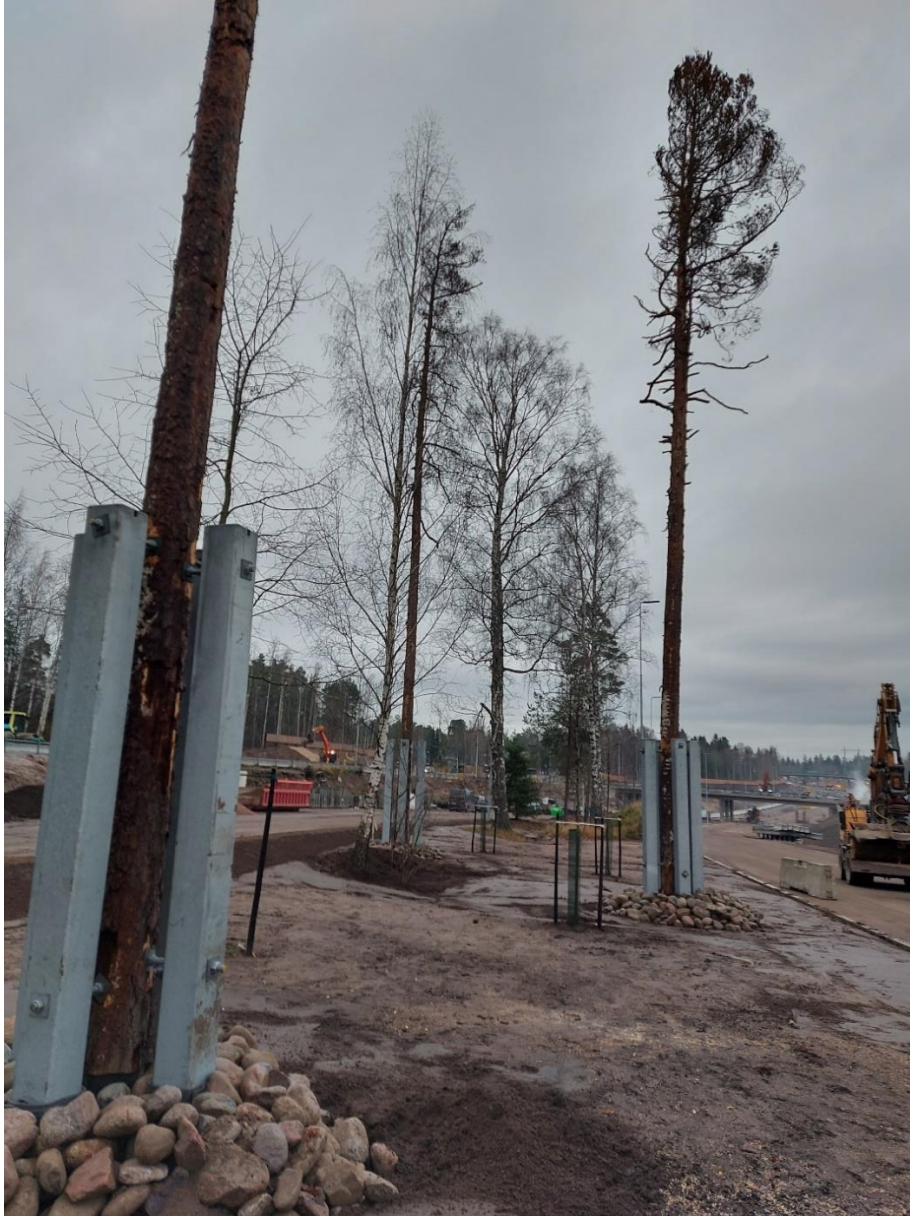
Kuva 6-2. Rakennettuja ja kasvamassa olevia yhteyttä täydentäviä liito-oravan hyppypuita Kehä I:n ylityspaikalla, Laajalahden kohdalla.
