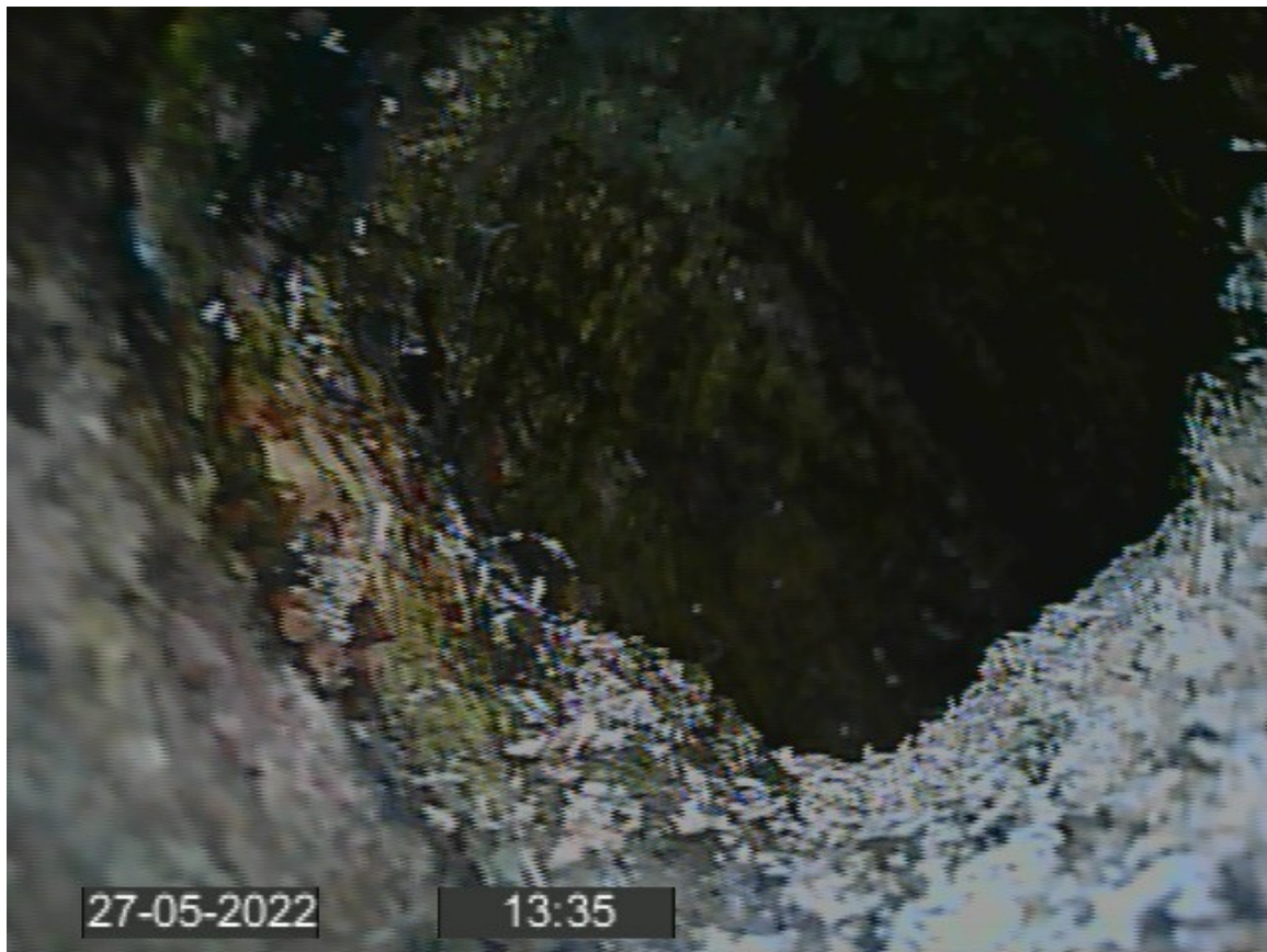
Kuva 4. Koloksi epäilty kolonaloitus, tarkastuskameralla suuaukolta kuvattuna
